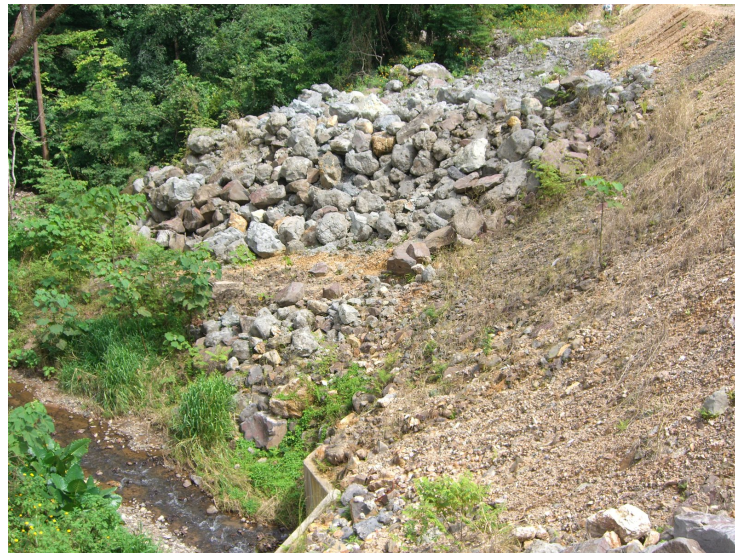
Figura 4.12: Falta de protección en los taludes.
