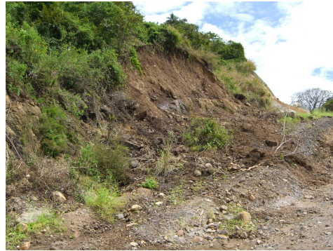
(b) Humedad en el talud.
