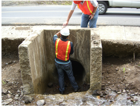
(a) Cabezal inadecuado de entrada.
