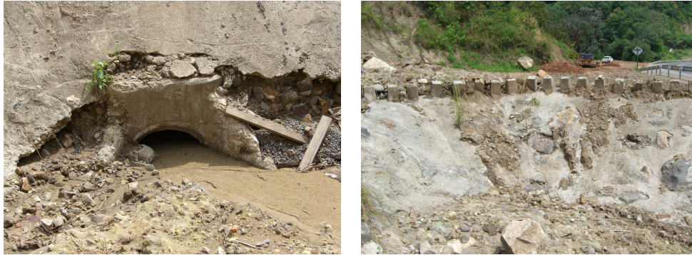
(a) Alcantarilla colapsada por el material transportado. (b) Material transportado por la erosión en los taludes.
