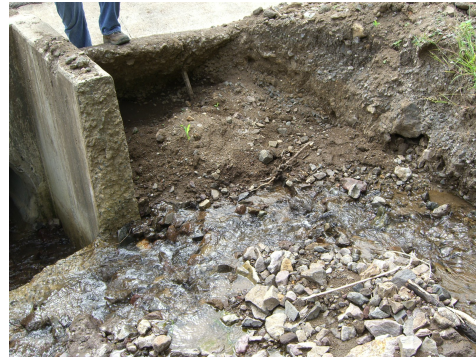
(b) Erosión presentada lado derecho.
