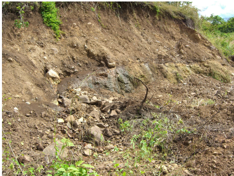
(a) Humedad presente en los taludes.
