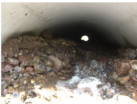
(a) Alcantarilla obstruida por el material.
