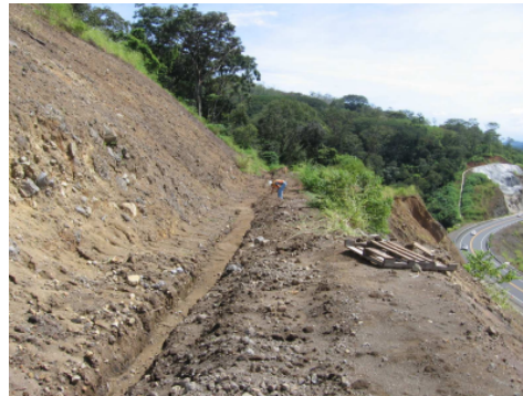
(b) Contracuneta sin revestimiento.
