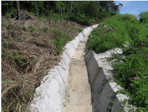
(a) Alineación inadecuada.
