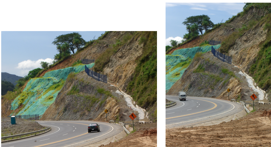
(a) Problemas en los taludes.
