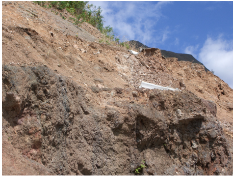
(a) Contracuneta destruida por el deslizamiento.
