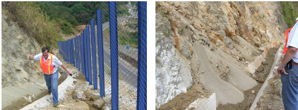
(a) Ubicación de las contracunetas detrás de la barrera. (b) Colmatación en las contracunetas debido a la caída de material.
