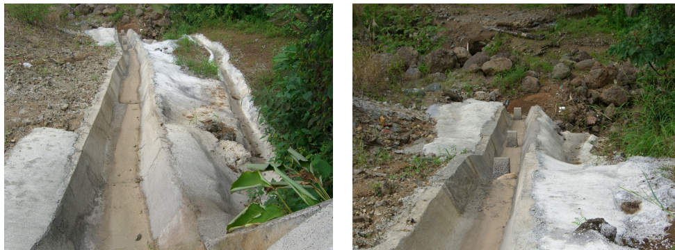
(a) Efectos del salpique de las obras.
