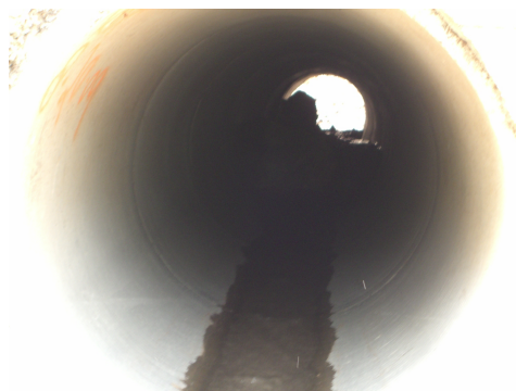
(b) Vista a la salida de alcantarilla obstruida.
