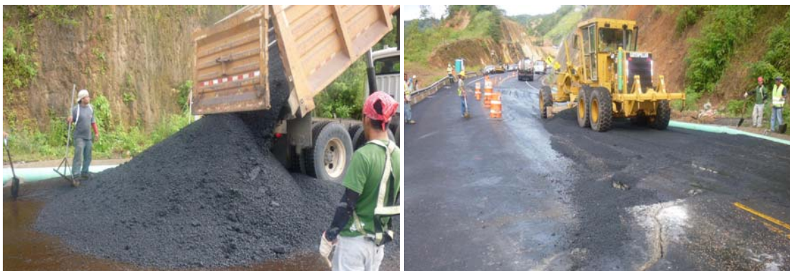
Fotografías 21 y 22. Colocación de sobrecapa luego del desplazamiento severo, kilómetro 46+800. 23 de Setiembre 2010. Fuente: Supervisora CACISA-Cano Jiménez.
