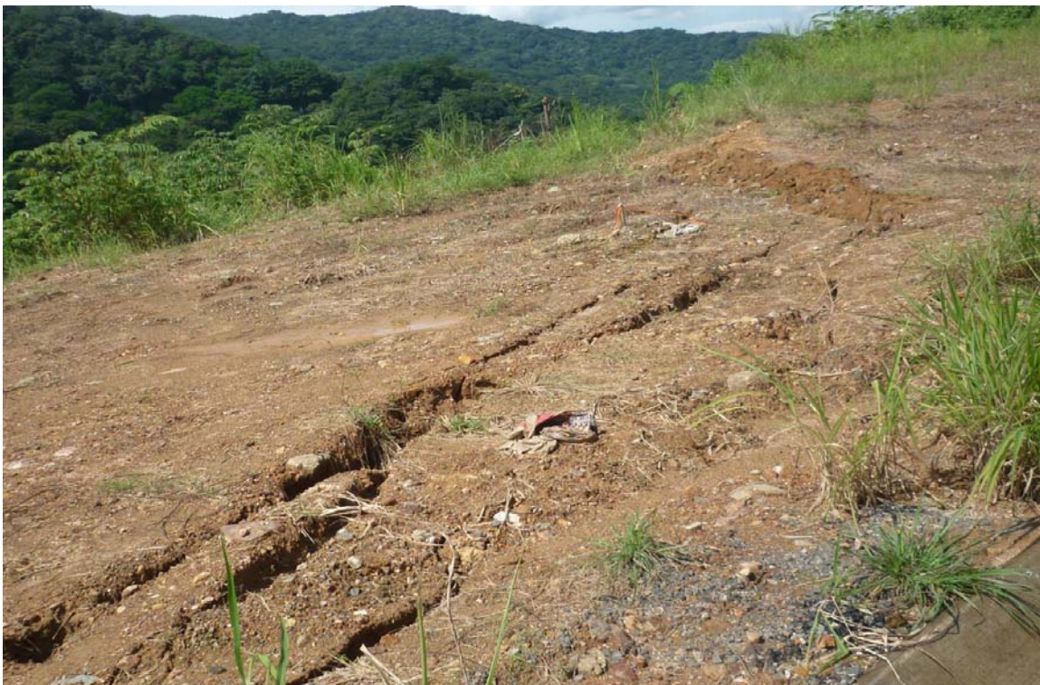
Fotografía 19. Agrietamiento en el talud de relleno., kilómetro 46+800. 22 de Setiembre 2010. Fuente: Supervisora CACISA-Cano Jiménez.
