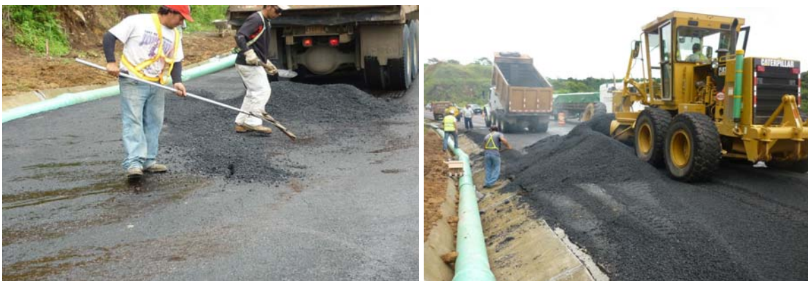
Fotografías 24 y 25. Nuevamente colocación de mezcla asfáltica sobre las grietas que se seguían presentando, kilómetro 46+800. 24 de Setiembre 2010. Fuente: Supervisora CACISA-Cano Jiménez.
