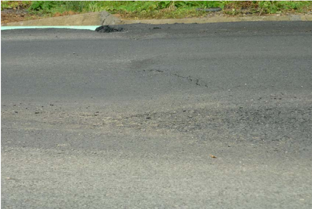
Fotografía 27. Nuevo desplazamiento luego de la colocación de la nueva sobrecapa, kilómetro 46+800. 25 de Setiembre 2010. Fuente: Supervisora CACISA-Cano Jiménez.
