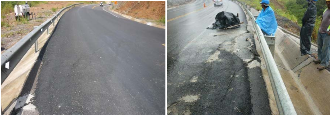
Fotografías 10 y 11. Reflejo de grietas en la sobrecapa asfáltica, kilómetro 46+800. 19 y 21 de Setiembre respectivamente, 2010. Fuente: Supervisora CACISA-Cano Jiménez.
