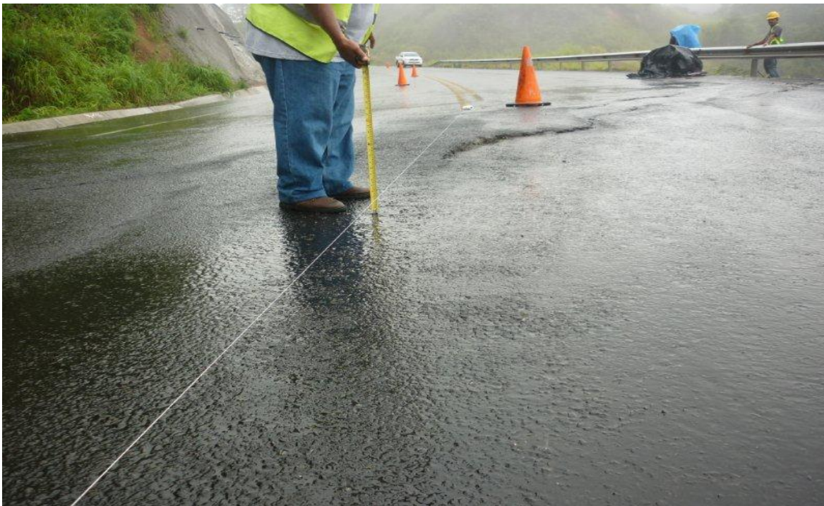
Fotografía 12. Formación de grada en la superficie de rodamiento, kilómetro 46+800. 21 de Setiembre 2010. Fuente: Supervisora CACISA-Cano Jiménez.
