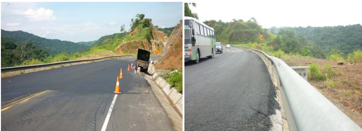
Fotografías 8 y 9. Movimiento constante del terreno luego de colocada la mezcla asfáltica, kilómetro 46+800. 14 y 16 de Setiembre respectivamente, 2010. Fuente: Supervisora CACISA-Cano Jiménez.
