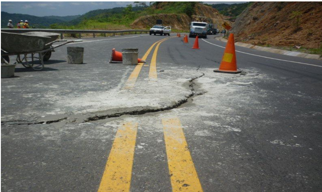
Fotografía 5. Grieta continua formándose luego de inclusión de lechada, kilómetro 46+800. 10 de Setiembre, 2010. Fuente: Supervisora CACISA-Cano Jiménez
