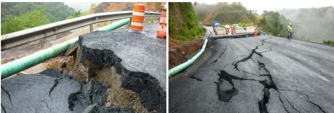
Fotografías 37 y 38. Desplazamiento presentado antes del cierre definitivo de la vía., kilómetro 46+800. 30 de Setiembre 2010. Fuente: Supervisora CACISA-Cano Jiménez.
