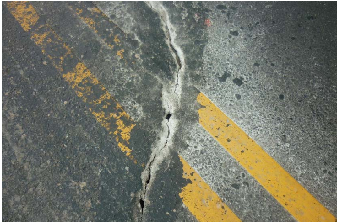
Fotografía 4. Grieta continúa formándose luego de sellada, kilómetro 46+800. 7 de Setiembre, 2010. Fuente: Supervisora CACISA-Cano Jiménez
