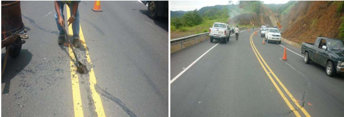
Fotografías 2 y 3. Sellado de la grieta en el kilómetro 46+800. Nótese la extensión a lo largo de la calzada. 31 de Agosto, 2010. Fuente: Supervisora CACISA-Cano Jiménez
