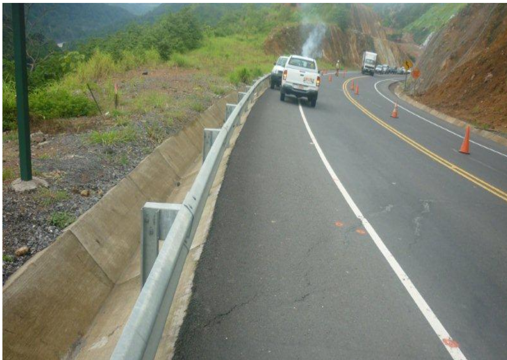
Fotografía 1. Formación de grieta en la carretera en el kilómetro 46+800. 31 de Agosto, 2010. Fuente: Supervisora CACISA-Cano Jiménez
