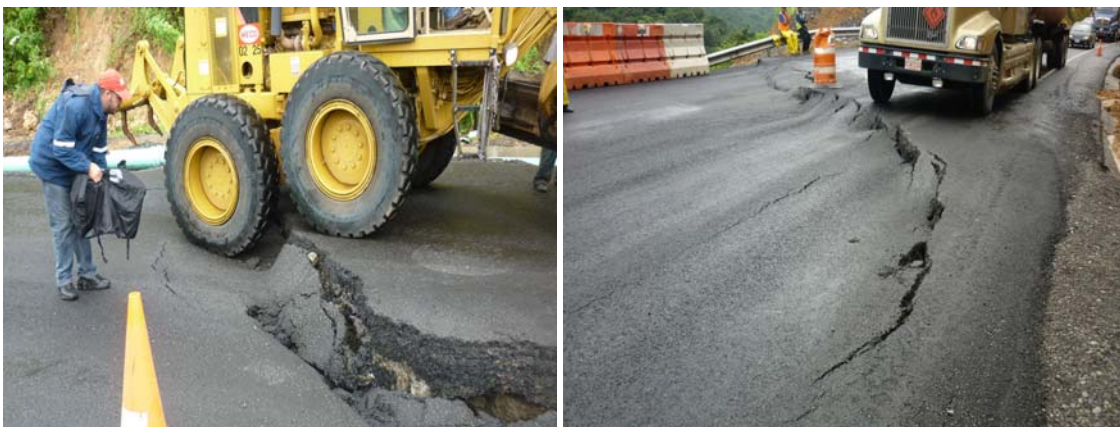
Fotografías 31 y 32. Nuevo desplazamiento del terreno, kilómetro 46+800. 29 de Setiembre 2010. Fuente: Supervisora CACISA-Cano Jiménez
