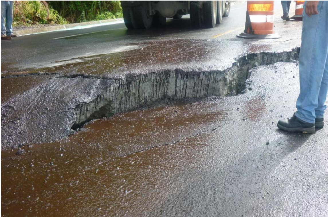
Fotografía 20. Desplazamiento severo un día después de la inyección de lechada en las grietas, kilómetro 46+800. 23 de Setiembre 2010. Fuente: Supervisora CACISA-Cano Jiménez.
