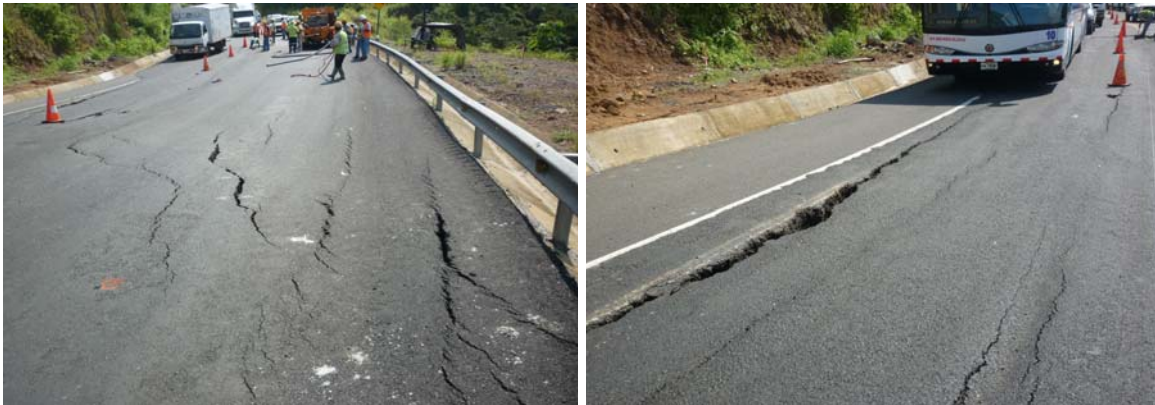
Fotografías 13 y 14. Deterioro acelerado de la superficie, kilómetro 46+800. 22 de Setiembre 2010
