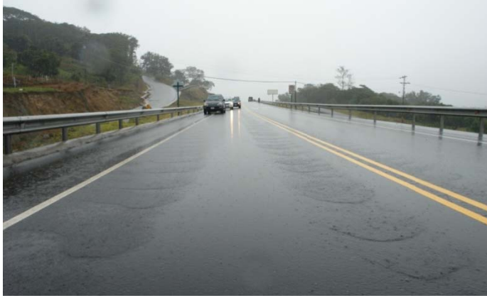
Fotografía N°52: Acumulación de agua en los ahuellamientos. Est. 34+000.
