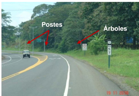
Fotografía N° 35: Curva horizontal sin guardavías y con obstáculos cercanos a la vía
