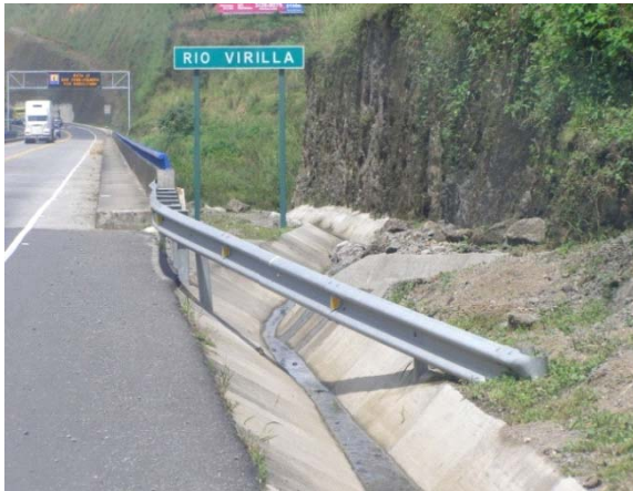
Fotografía N° 31: Transición de sistema de contención en aproximaciones a puente sobre el río Virilla, km. 16+000.
