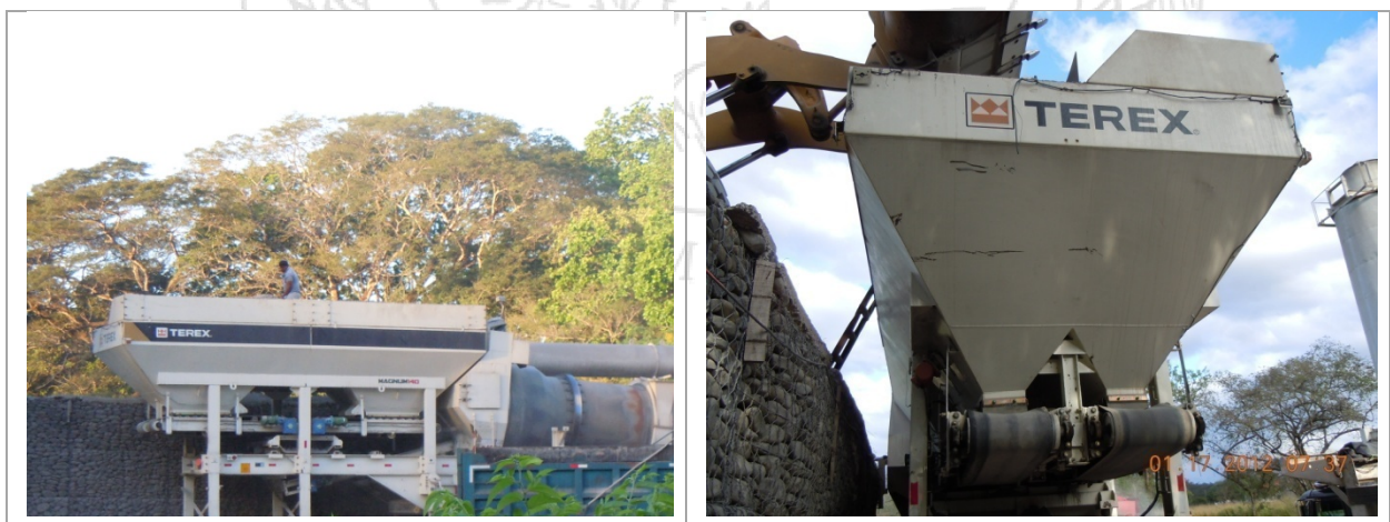
Fotografía 2 Tolvas de dosificación de agregados.
