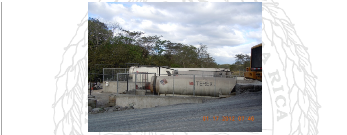
Fotografía 6 Tanques de almacenamiento de cemento asfáltico, combustibles y otros.
