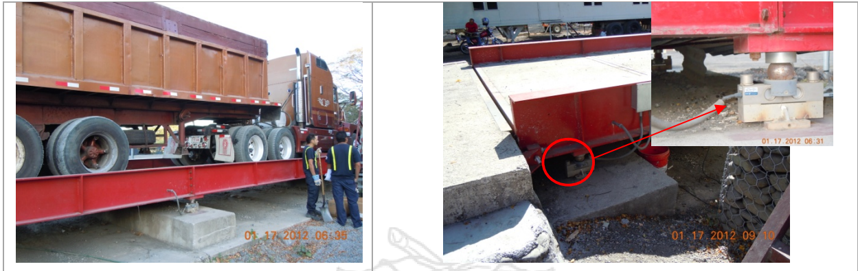
Fotografía 5 Plataforma de pesaje.
