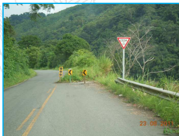
Fotografía 4: Deslizamiento paralelo al cauce del Río Térraba. Ubicación: aproximadamente 6 Km de Palmar Norte hacia Paso Real sobre la Ruta Nacional No.2. Fuente: Unidad de Auditoría Técnica, LanammeUCR.
