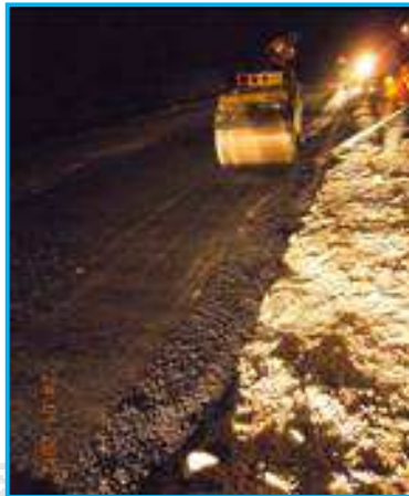
Fotografía 11: Ausencia de Conos en obras nocturnas
