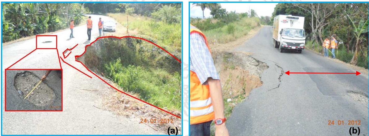
Fotografía 1. a) Deslizamiento de la vía, con un bache profundo en la superficie de rueda, b) Otra perspectiva del deslizamiento.
