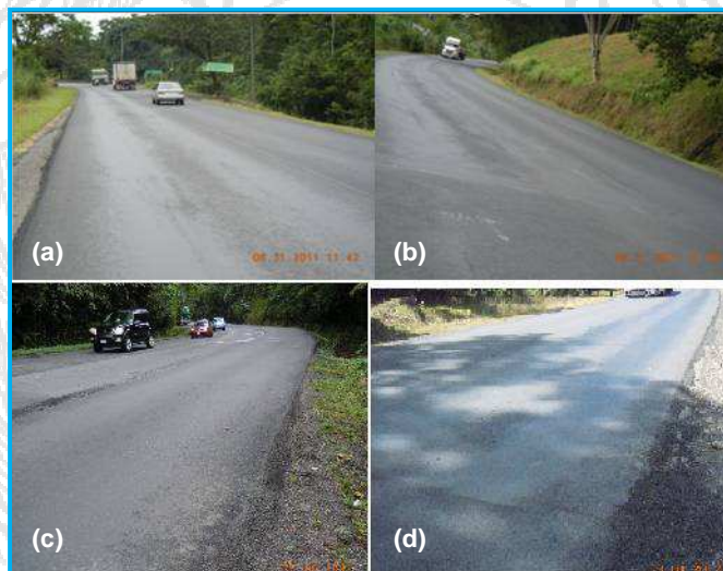
Fotografía 5. Las cuatro fotografías corresponden a diferentes tramos sobre la Ruta Nacional No.32 sin demarcación vial horizontal. Ubicación Braulio Carrillo, Intersección Ruta Nacional No.4, Siquirres y Guápiles. Fecha de las visitas: 2 de Junio 2011 (b y c), 31 de Octubre 2011 (a), 23 de Enero 2012 (d). Fuente: Unidad de Auditoría Técnica, LanammeUCR.
