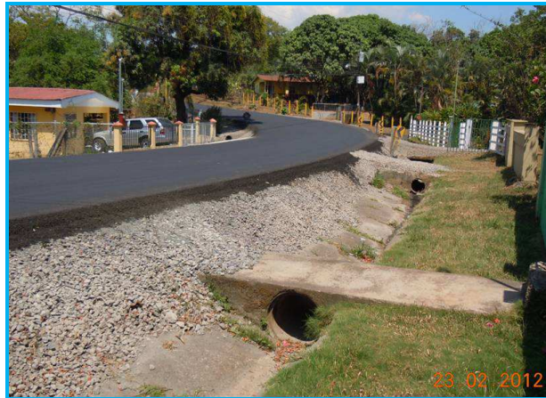
Fotografía A5: Ruta 757, Proyecto Especial Coyolar-Orotina Visitas: 22-23 de Febrero 2012 Fuente: Unidad de Auditoría Técnica, LanammeUCR.
