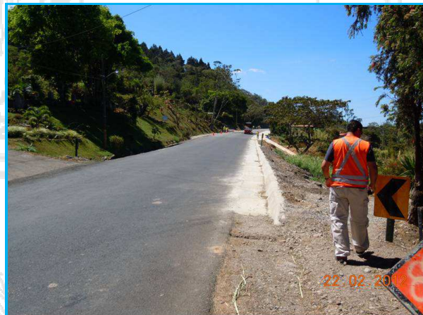
Fotografía A6: Ruta Nacional No.1, Entrada San Ramón- hacia Puntarenas (hundimiento) Visitas: 3 de Noviembre 2011, 22 y 23 de Febrero 2012 Fuente: Unidad de Auditoría Técnica, LanammeUCR.
