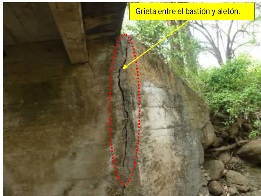
Figura 12. Grieta importante entre bastión y aletón
