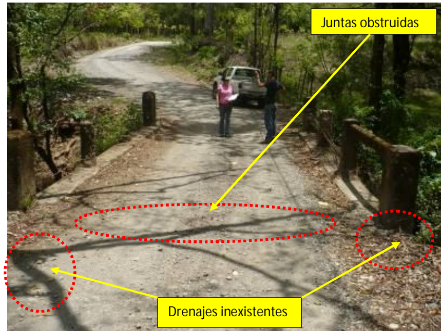
Figura 8. Los accesos no cuentan con drenajes y las juntas están obstruidas.
