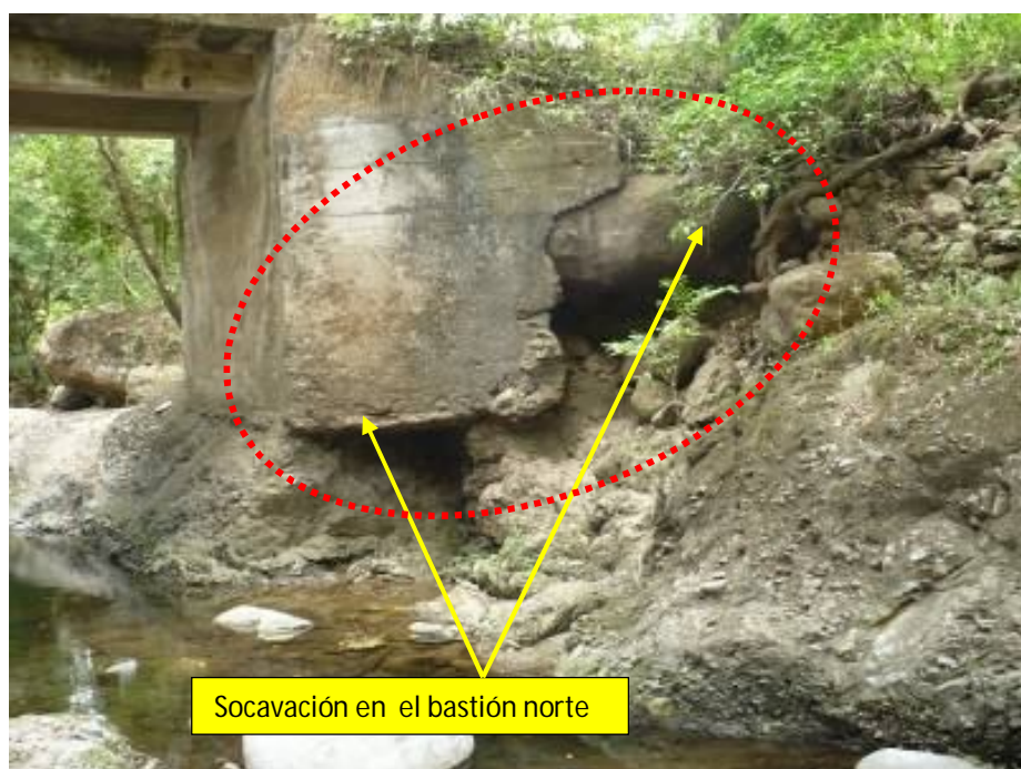
Figura 11. Bastión con socavación importante en el aletón norte.
