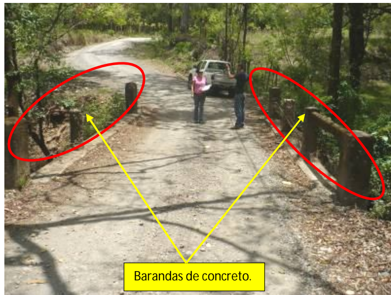
Figura 5. Barandas de concreto en muy mal estado.
