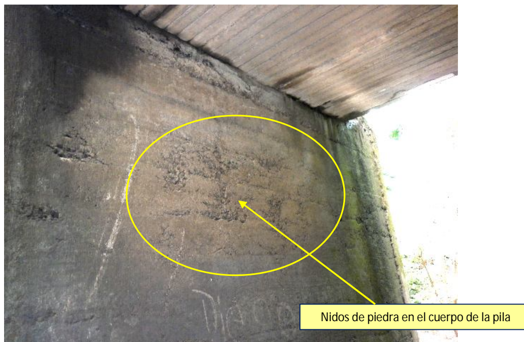
Figura 17. Pila central presenta nidos de piedra y juntas constructivas
