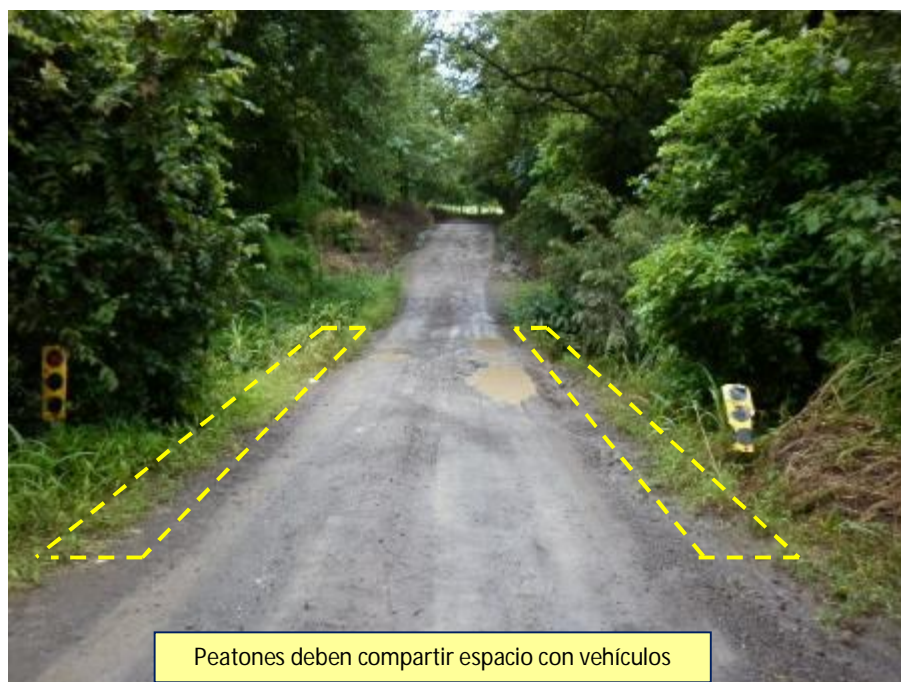
Figura 7. El puente no tiene aceras en sus costados
