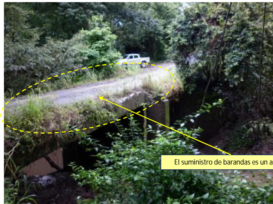
Figura 6. Inexistencia de barandas en el puente
