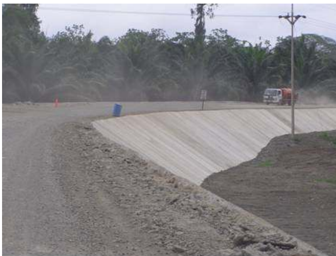
Fotografía No.4: Aproximación al puente sobre el río Tigre, donde existe un talud con una altura importante y no existe señalización suficiente. Fotografía fue tomada el 22 de abril del 2009.
