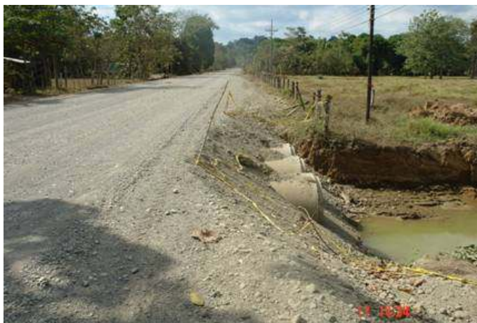
Fotografía No.5: Riesgos al lado de la vía que no cuentan con señalización suficiente para prevenir al usuario. Fotografía fue tomada el 17 de marzo del 2009.
