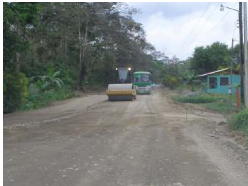
Fotografía No.3: Trabajos de compactación del material colocado. Justo detrás de la compactadora transita un autobús de servicio de transporte público. No existe una canalización adecuada del tránsito. Fotografía tomada el 22 de abril del año 2009.
