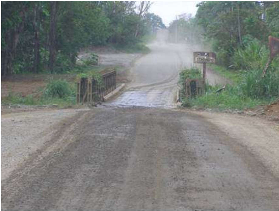
Fotografía No.6: No existe señalización preventiva y la señalización reglamentaria permanece poco visible y en mal estado. Fotografía fue tomada el 22 de abril del 2009.
