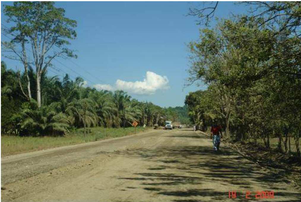
Fotografía No.1: Señalización insuficiente en el sitio de obras. Al fondo se observan dos vagonetas haciendo maniobras dentro de la vía. Fotografía tomada el 19 de febrero del año 2009.
