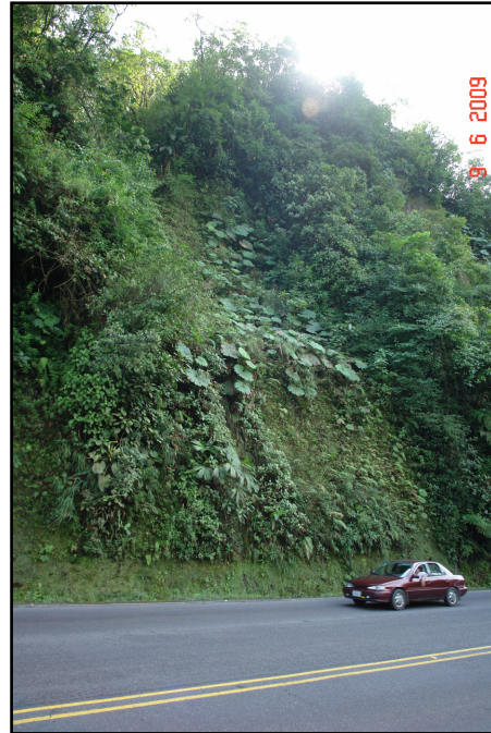
Fotografías 3 y 4. Deslizamientos registrados entre estacionamientos 21+250 y 21+600.
