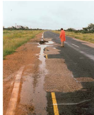
b. Problemas de drenaje
