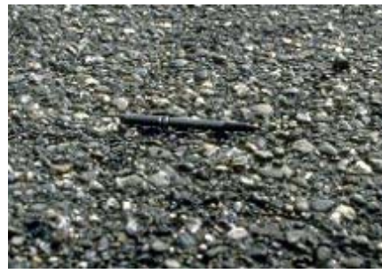
b. Desprendimiento de partículas
