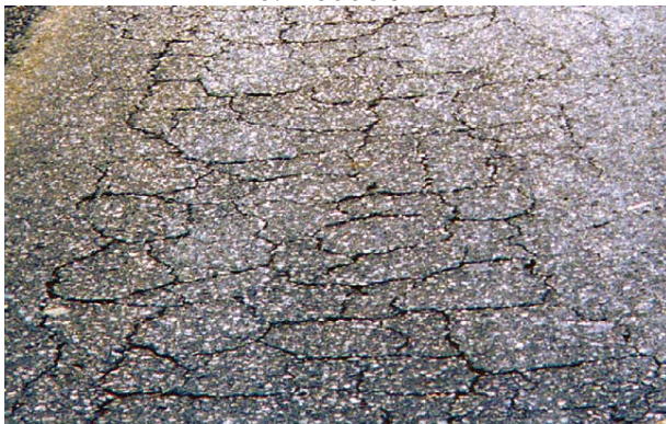
c. Agrietamiento por fatiga
