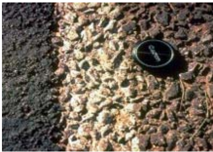
a. Pavimento oxidado
