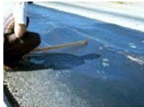
d. Ahuellamiento severo
