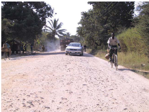
a. Superficie no adecuada
