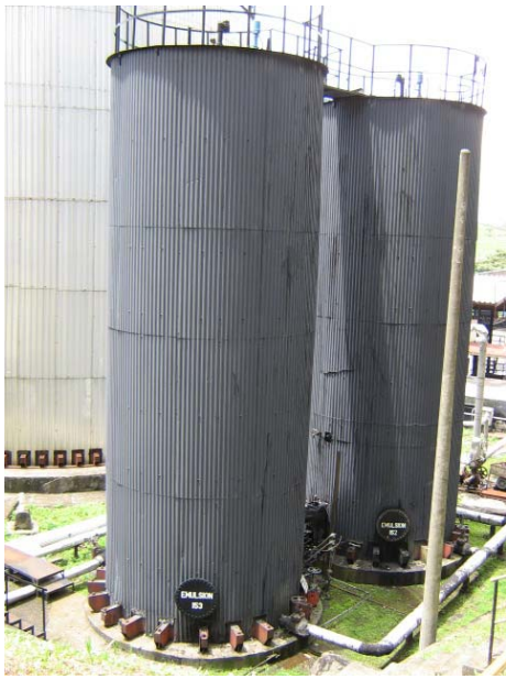
a. Tanques de almacenamiento de emulsión asfáltica.
