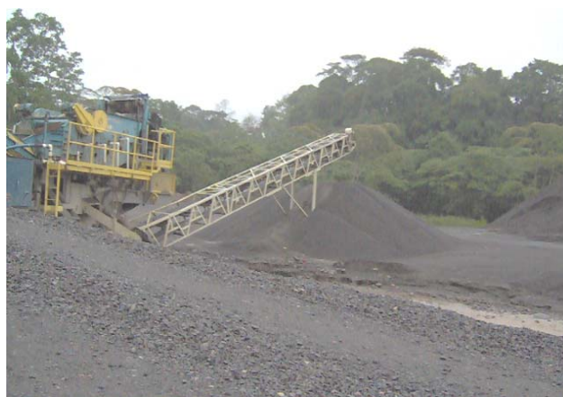
b. Producción de agregados Planta Santa Fé, Guápiles
