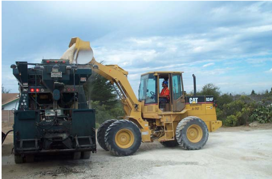
Figura 31: Carga del agregado en la máquina mezcladora en el sitio del apilamiento.
