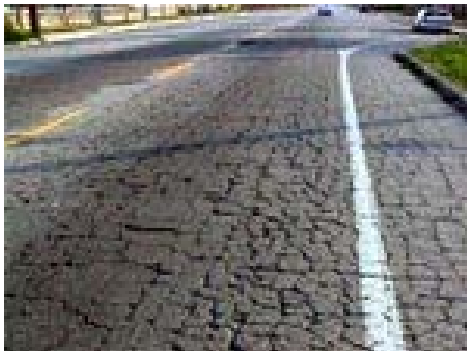
a. Agrietamiento severo
