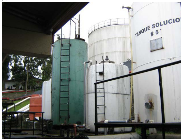
c. Tanques de almacenamiento anaranjado: ácido clorhídrico, verde: gasóleo, blanco pequeño: emulsificante y blanco mediano: solución jabonosa
