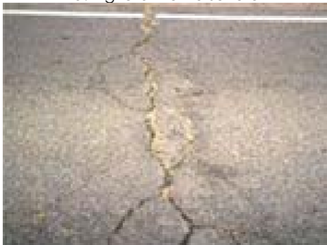
c. Agrietamiento trasversal con desprendimiento de borde
