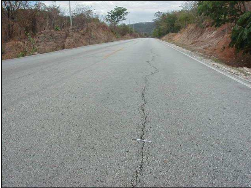
Figura Nº11 a: Grieta longitudinal
