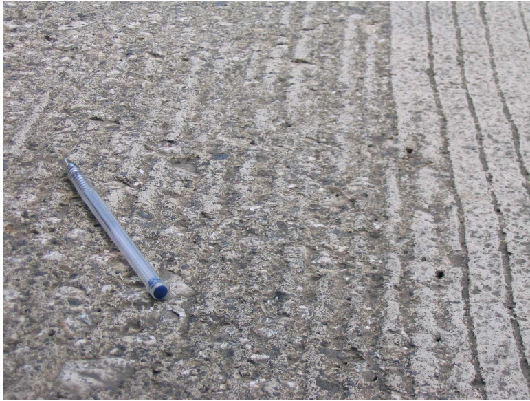
Desprendimiento de agregados
