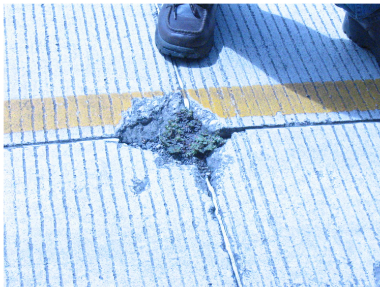
Deterioro en la junta
