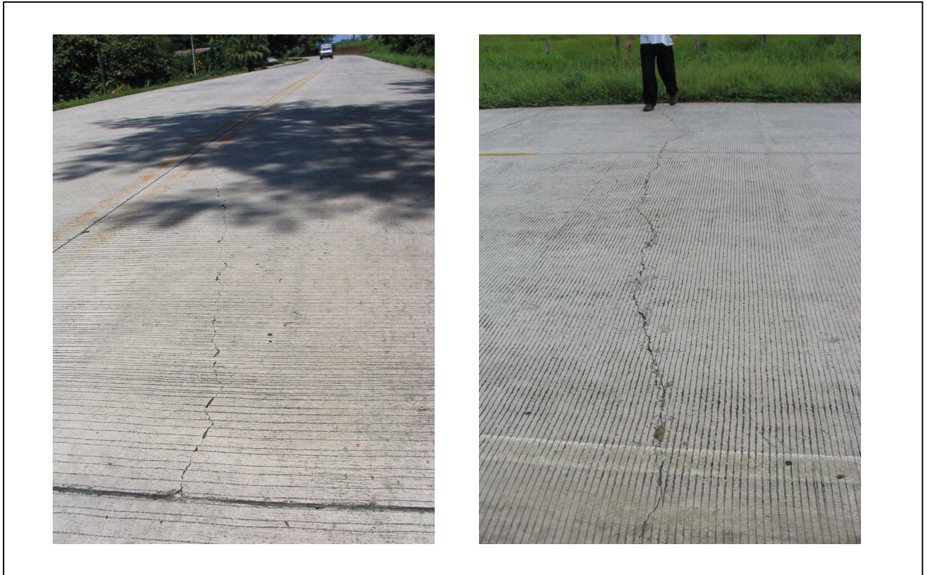
Figura N°1b: Agrietamiento en las esquinas, transversal y longitudinal.
