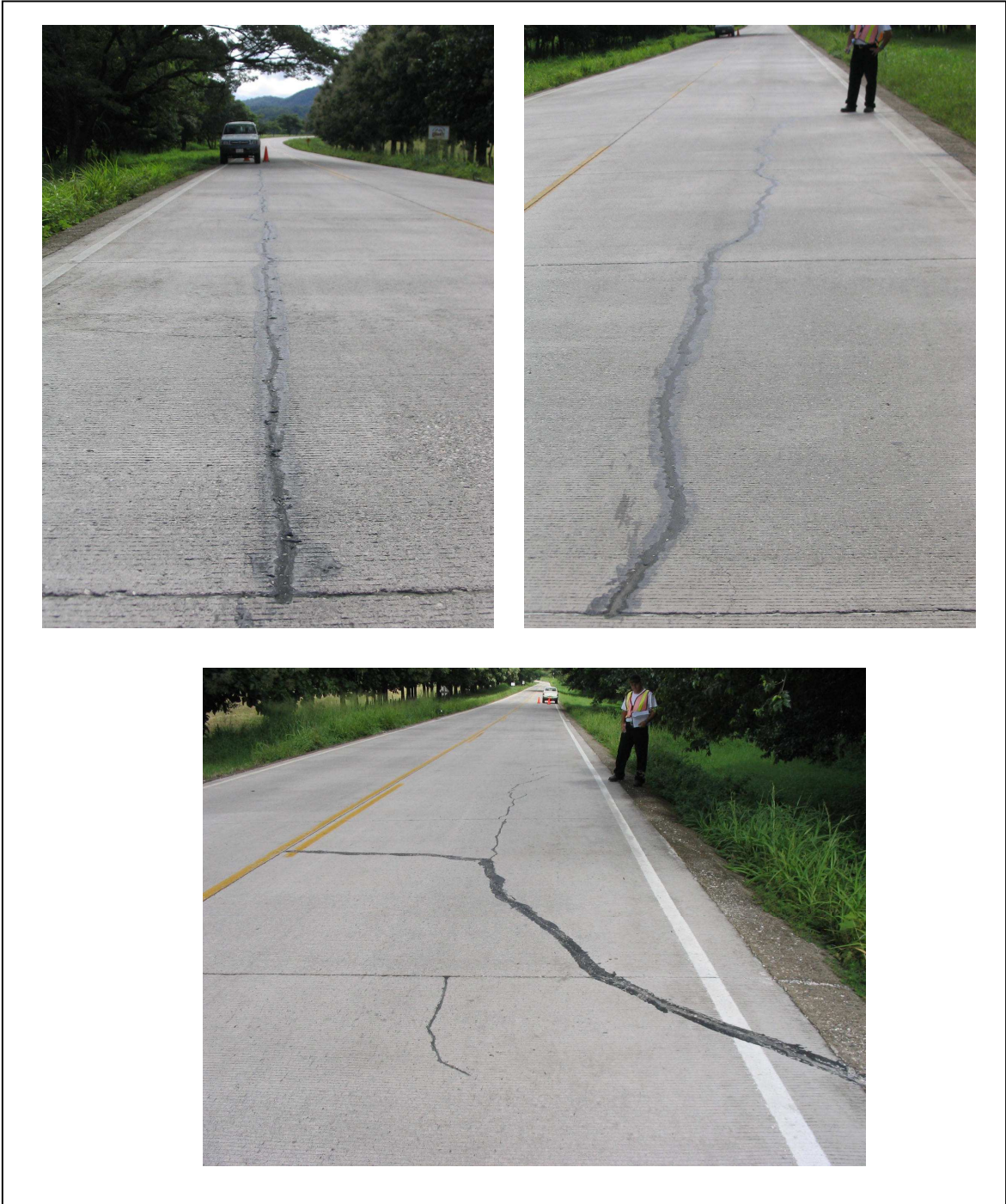
Figura N°1a: Agrietamiento por problemas geotécnicos
