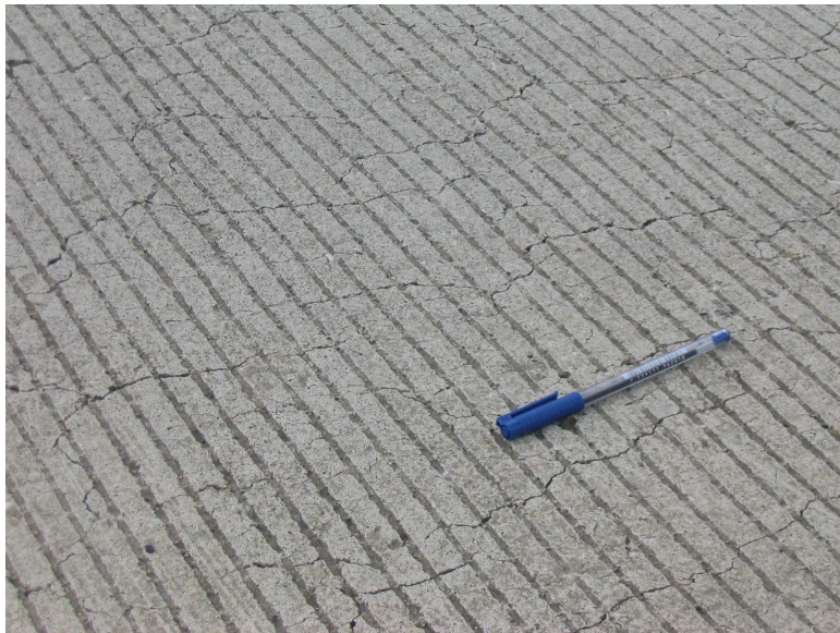
Agrietamiento en el concreto
