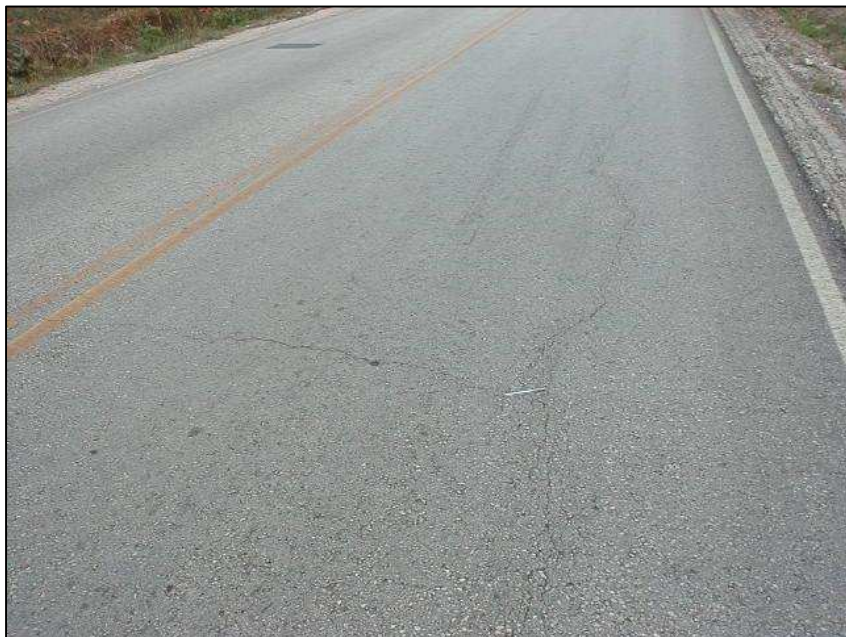
Figura Nº11 b: Grieta transversal
