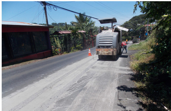
Figura 10. Texturizado superficial realizado para corregir exudación. Fuente: Unidad de Auditoría Técnica (PITRA-LanammeUCR), 2018.
