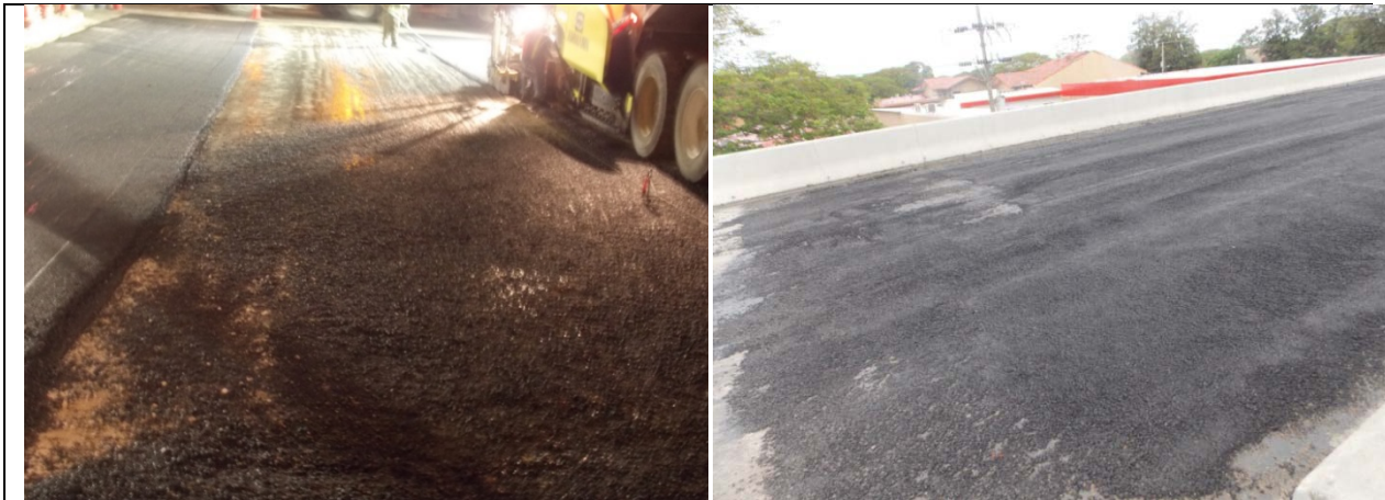
Fotografía 5 y 6. Uso de "traba" en las actividades de colocación de mezcla asfáltica en caliente . Ubicación: Sobre la Ruta 1 ,Intercambio de Liberia Sección Cañas Liberia , Fecha 15 de julio y 10 de setiembre de 2015. Fuente: LanammeUCR.
