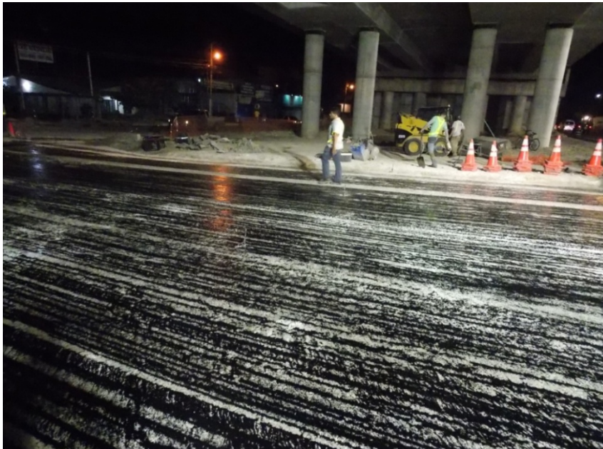
Fotografía 4. Riego no uniforme en los ramales del intercambio de Liberia . Ubicación: Sobre la Ruta 1, Intercambio de Liberia Sección Cañas Liberia . Fecha 15 de julio de 2015. Fuente: LanammeUCR.
