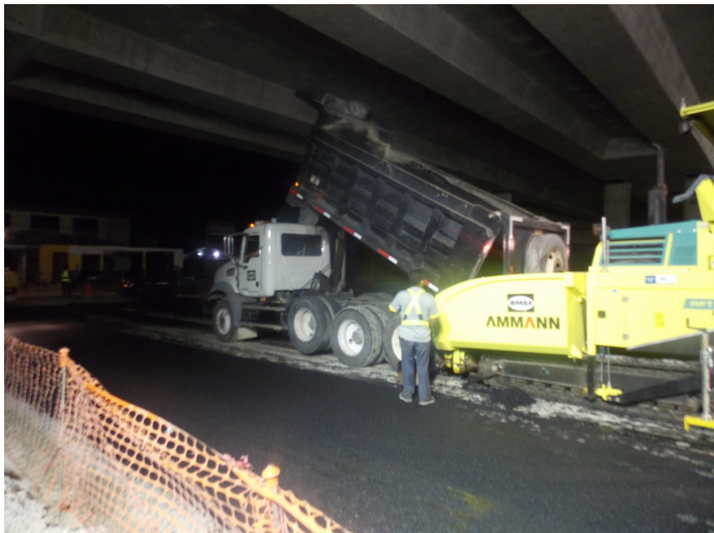
Fotografía 3. Mezcla colocada en los ramales del intercambio de Liberia. Ubicación: Sobre la Ruta 1, Intercambio de Liberia Sección Cañas Liberia, Fecha 15 de julio de 2015. Fuente: LanammeUCR.
