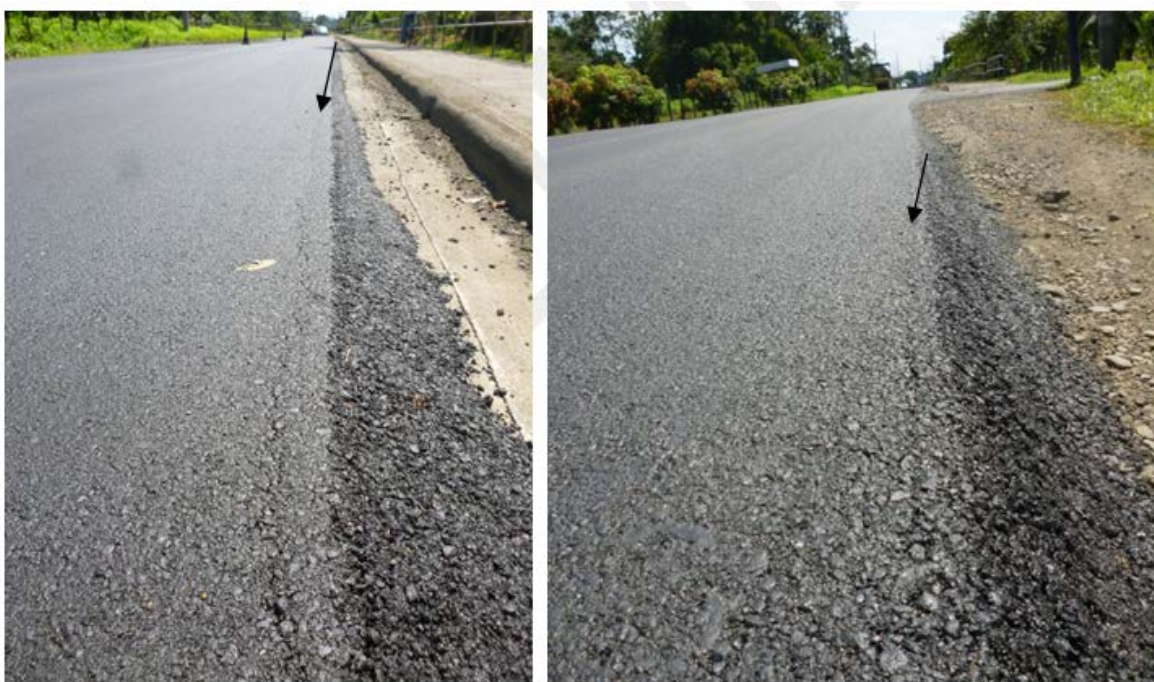
Fotografía 10. Agrietamiento en el borde de la capa
