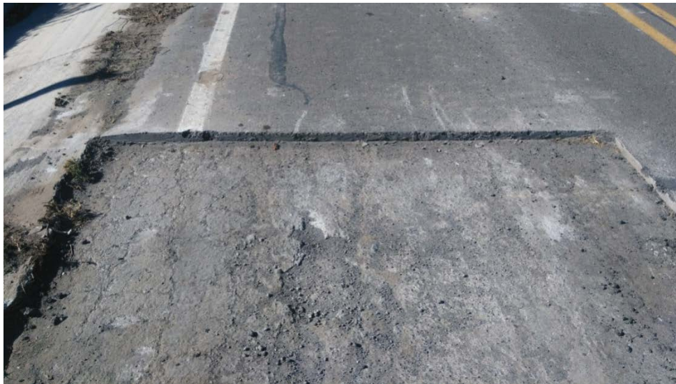
Fotografía 40. Corte de bacheo inconcluso expuesto al tránsito. No se observó señalización de advertencia del desnivel en la vía para alertar a los usuarios de forma preventiva.
