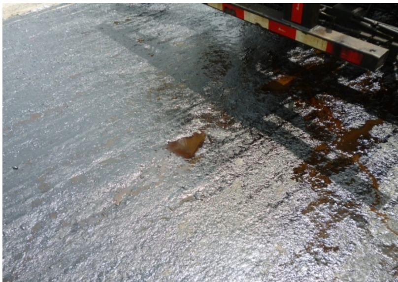
Fotografía 37. Acumulación de emulsión asfáltica producto de fuga en tuberías del camión dosificador. Ubicación: Ruta Nacional 118, Sección de control: 20170, Grecia- Río Sarchí, km 17+800. . Fecha: 27 de mayo de 2016. Fuente: LanammeUCR.
