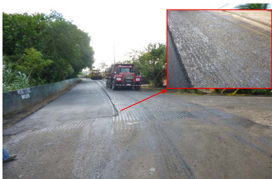
Fotografía 18. Riego poco uniforme y sin cobertura total de la superficie. La dosificación de riego de liga utilizada fue de 0,3 l/m 2 .
