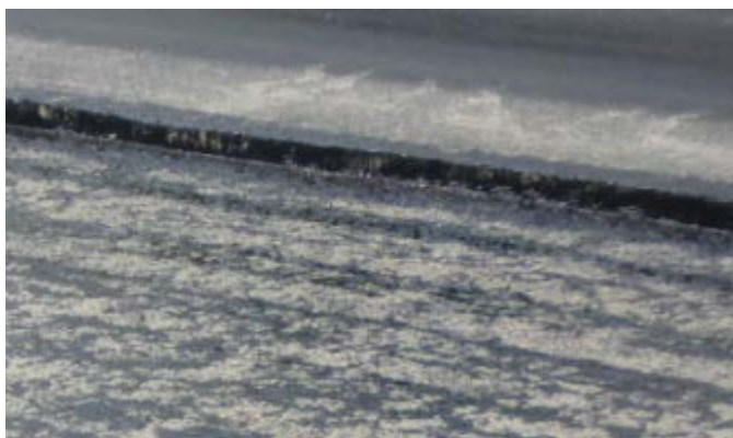
Fotografía 8. El borde interno de la capa colocada otro día fue cortado para construir la junta longitudinal. Ubicación: Ruta Nacional 36, Sección de control 70050, Limón - Río Banano, kilómetro 0+300. Fecha: 2 de marzo 2016. Fuente: LanammeUCR.
