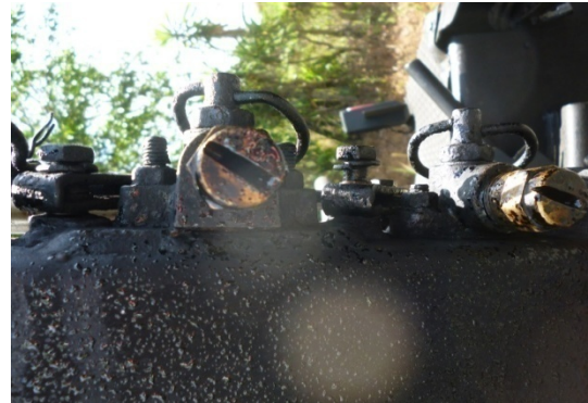
Fotografía 20. Boquillas con abertura inadecuada para la presión de bombeo y dosificación aplicada de riego de liga.
