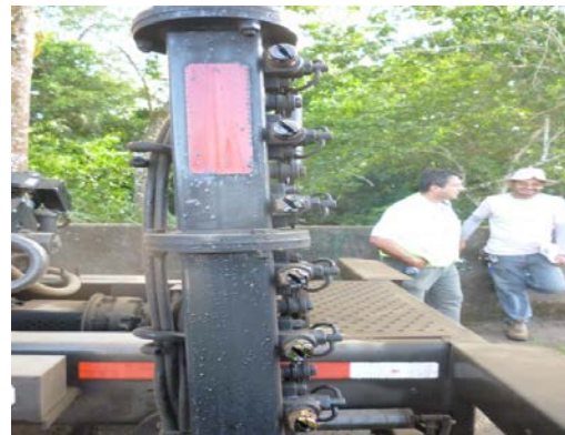
Fotografía 22. Boquillas con abertura inadecuada para la presión de bombeo y dosificación aplicada de riego de liga.
