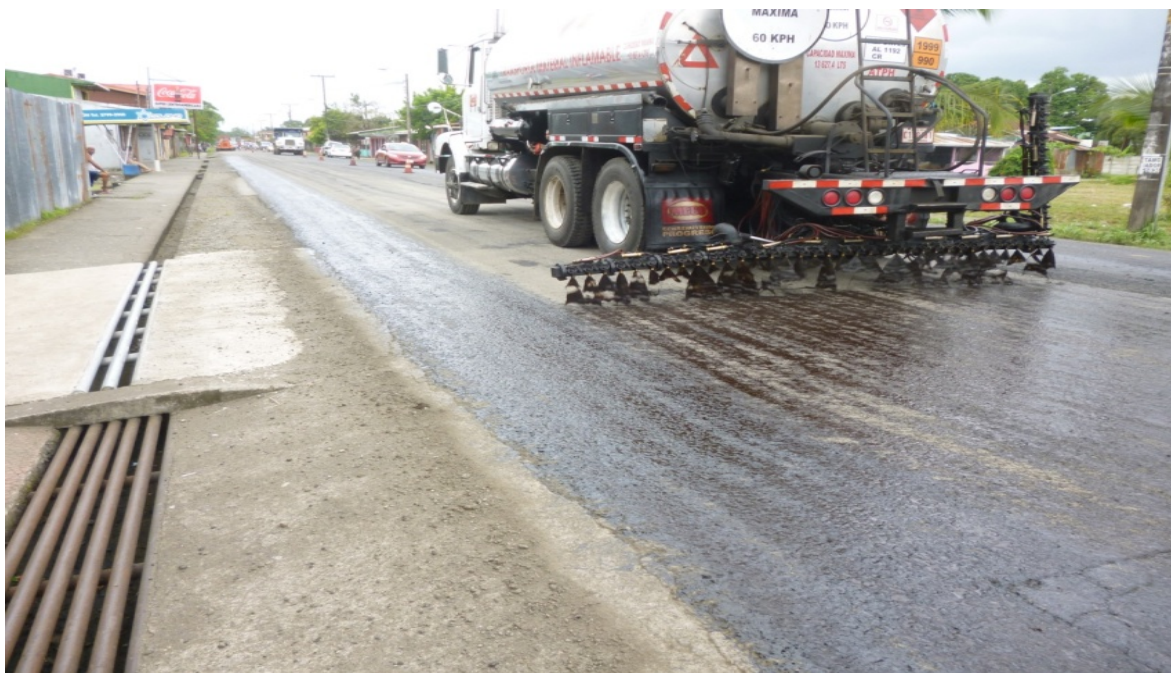
Fotografía 27. Se observó que las boquillas no presentaban la misma aspersión por posibles obstrucciones. Ubicación: Ruta 36, Sección de control 70050 Limón -Río Banano, Lugar: km 0+450 desde el cruce con la Ruta Nacional 32. Fecha: 1 de marzo de 2016. Fuente: LanammeUCR.
