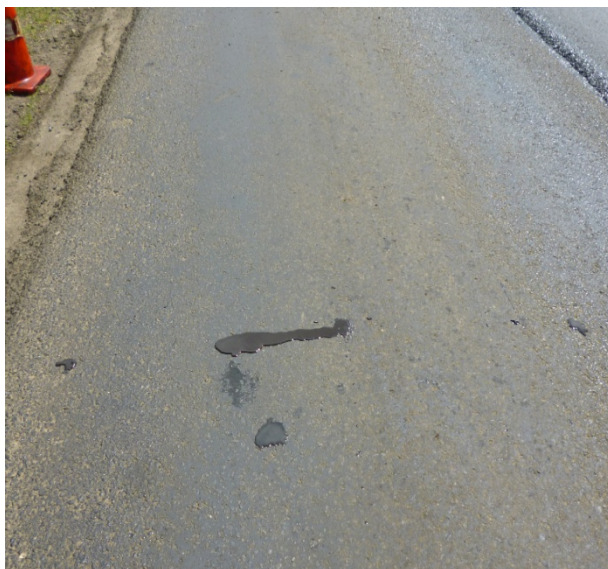
Fotografía 35. Derrame de emulsión producto de fuga en camión dosificador.
