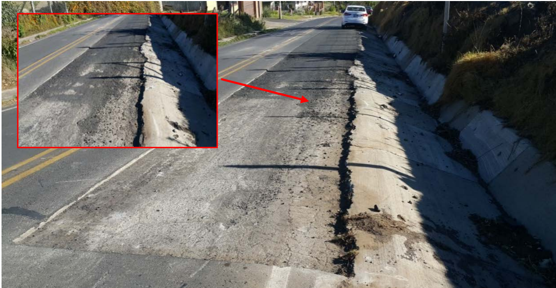
Fotografía 39. Bacheo inconcluso al término de la jornada laboral. La condición de la base estabilizada donde se realizó la intervención permanece agrietada moderadamente.
