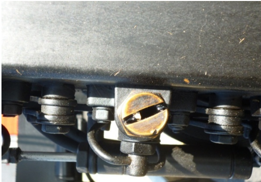
Fotografía 19. Boquillas con abertura inadecuada para la presión de bombeo y dosificación aplicada de riego de liga.
