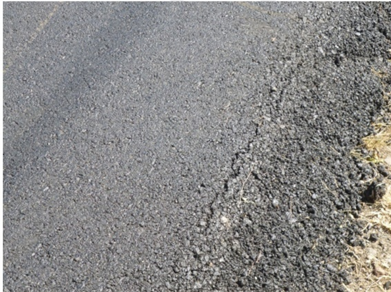
Fotografía 13. Agrietamiento en el borde de la capa
