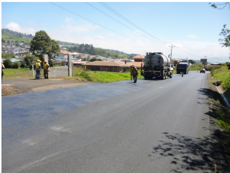
Fotografía 32. Riego de liga fue aplicado por segunda vez después de la observación del equipo auditor. Ubicación: Ruta 219, Sección de control 60262, Tierra Blanca- Límite Cantonal Oreamuno-Alvarado, Lugar: km 1+400 desde el cruce con la Ruta Nacional 401. Fecha: 24 de febrero de 2016. Fuente: LanammeUCR.
