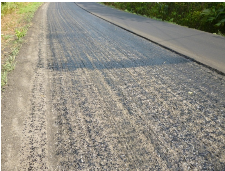
Fotografía 16. Riego de liga distinto en la misma sección donde se realiza intervención, la cobertura no es total. Se utilizaron una boquillas con abertura mayor que lo adecuado para riegos de liga leves según riego y presión utilizados, por lo que utilizan boquilla de por medio para lograr un riego de 0,33 l/m 2 . Ubicación: Ruta 2, Sección de control 60052 Buenos Aires - Paso Real, Lugar: km4+900 del cruce con ruta 246. Fecha: 15 de marzo de 2016. Fuente: LanammeUCR.
