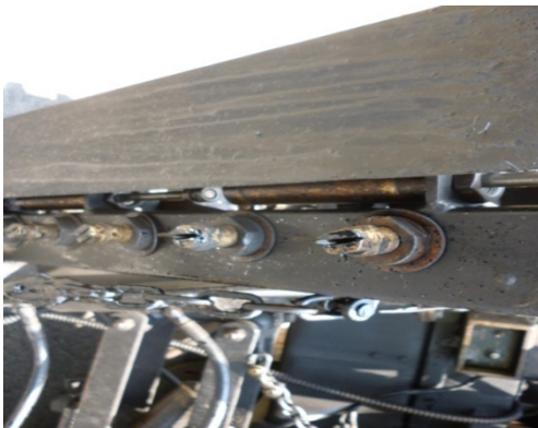
Fotografía 21. Boquillas con abertura inadecuada para la presión de bombeo y dosificación aplicada de riego de liga.
