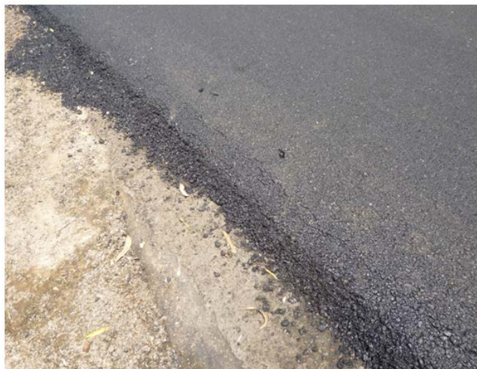
Fotografía 11. Agrietamiento en el borde de la capa colocada.
