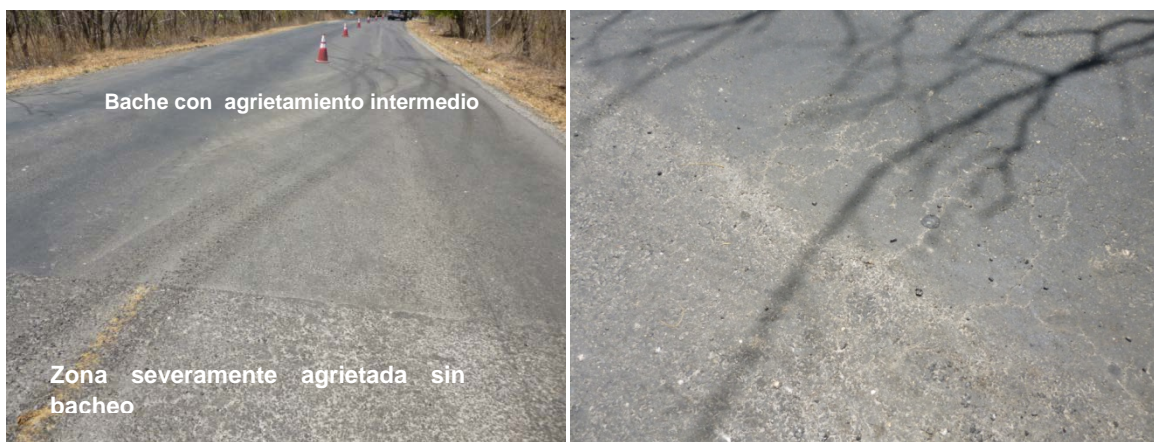
Fotografía 5. Baches colocados en fechas anteriores que ya presentan agrietamiento.
