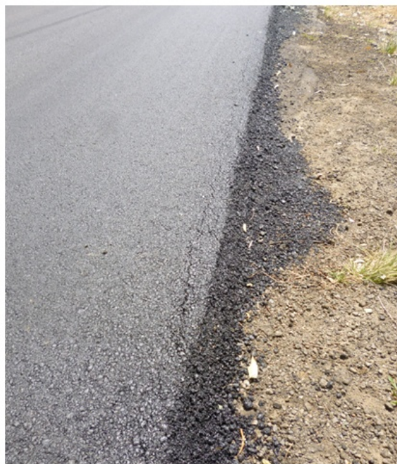
Fotografía 12. Agrietamiento en el borde de la capa colocada.
