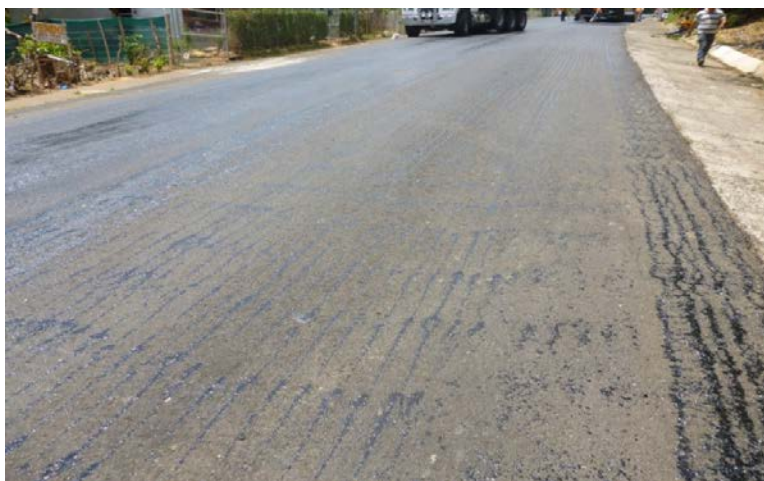
Fotografía 17. Riego de liga no uniforme donde se evidencian secciones de la superficie a intervenir sin cobertura.
