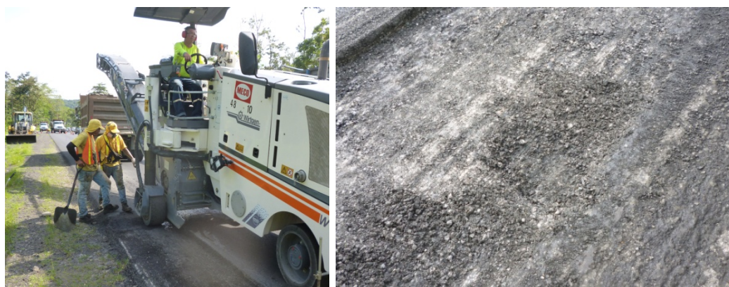
Fotografía 43. Evidencia de la falta de compactación en el tramo corregido.
