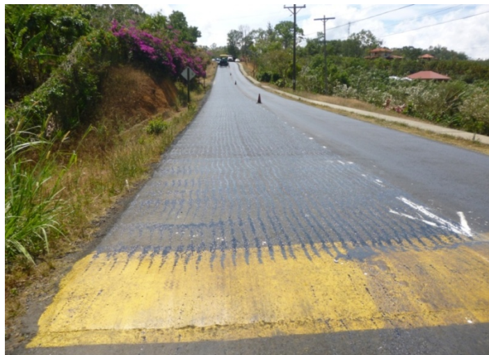
Fotografía 15. Riego de liga no uniforme. La dosificación del riego de liga fue de 0,5 l/m 2 . Ubicación: Ruta 226, Sección de control 10151, Límite cantonal Tarrazú/León Cortés - San Pablo, Lugar: km 2+801 desde el cruce con la Ruta Nacional 303. Fecha: 25 de febrero de 2016. Fuente: LanammeUCR.
