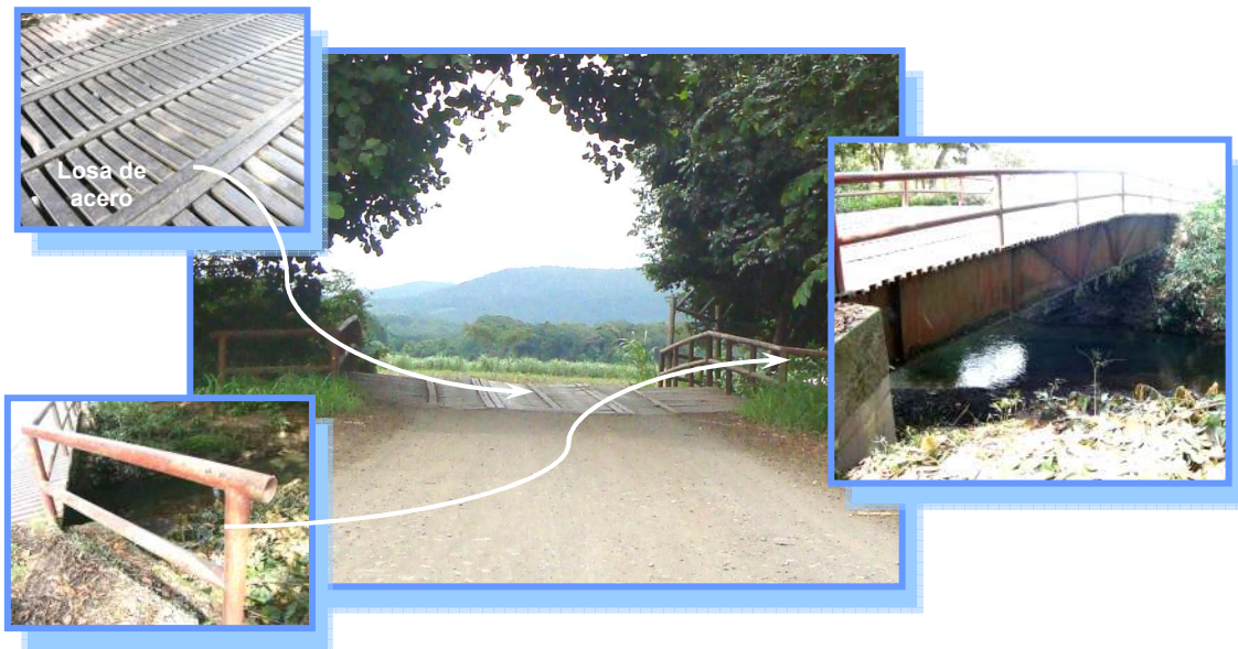
Fotografía N° 19: Estación 13+700. Puente sin sistema adecuado de contención vial en los accesos. (Fecha de fotografías 08-Junio-2010)
