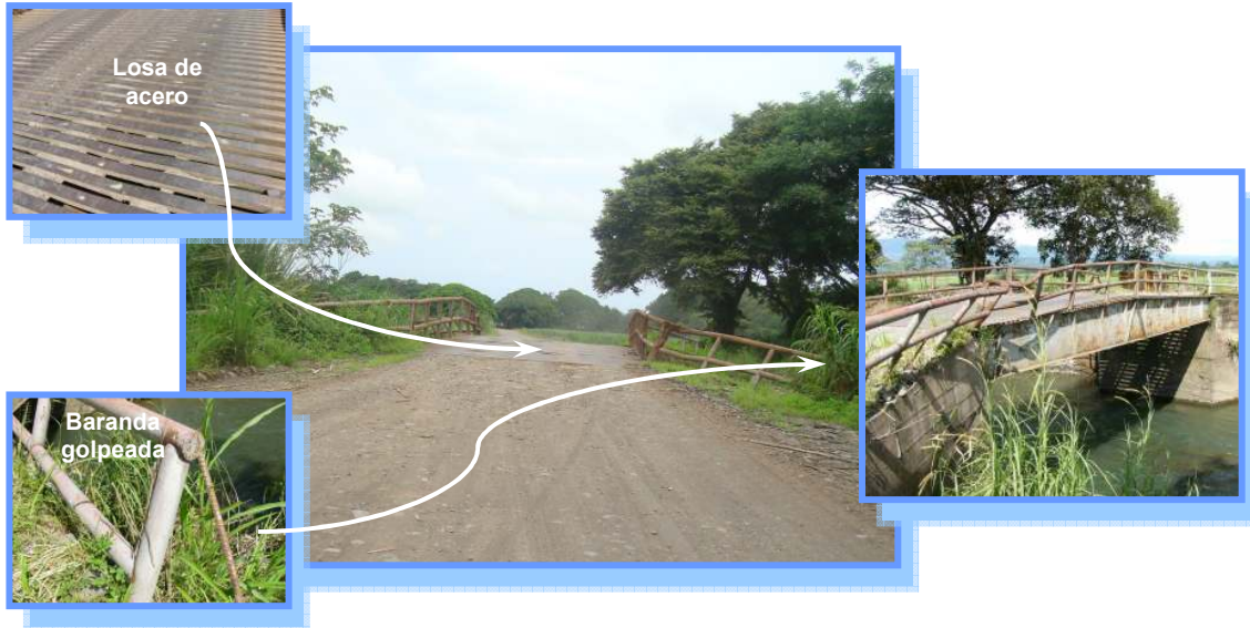
Fotografía N° 18: Estación 12+370. Puente con barandas golpeadas, sin sistema adecuado de contención vial en los accesos. (Fecha de fotografías 08-Junio-2010)
