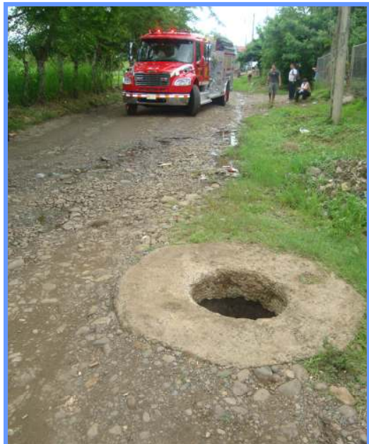
(C) Estación 0+225. Servicio público de alcantarillado Pozos de alcantarillado sin tapas
