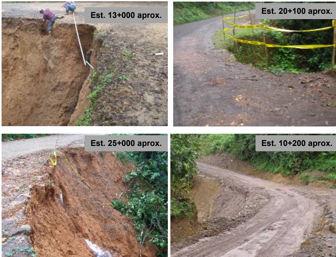
Fotografías No.18, 19, 20 y 21: Inestabilidad de taludes. 05/11/09
