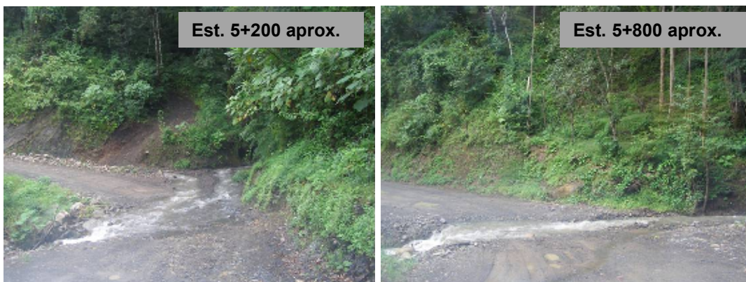
Fotografías No.11 y 12: Pasos de agua no controlados. 05/11/09
