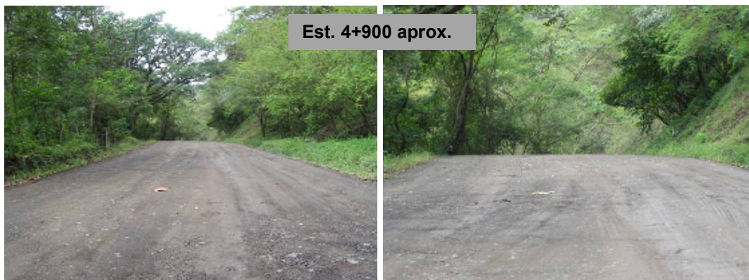
Fotografías No.9 y 10: Bombeo deficiente. 05/11/09
