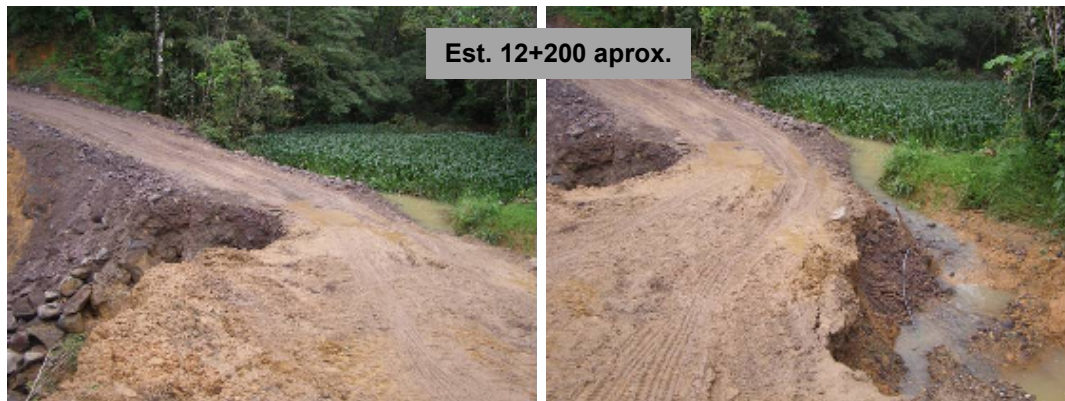
Fotografía No.13 y 14: Sección crítica de pérdida de sección. 05/11/09
