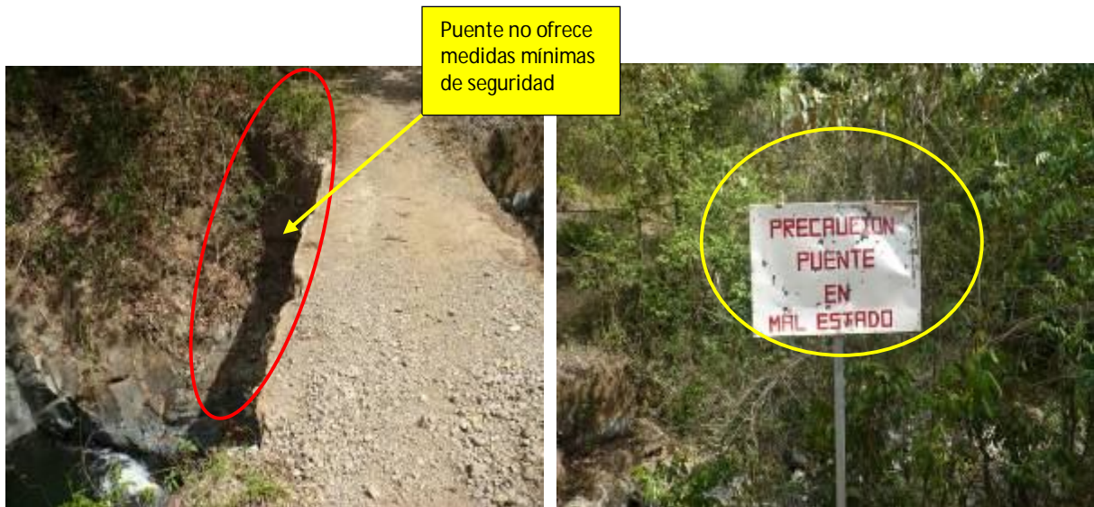
Figura 4. Ausencia de barandas y aceras en el puente. Señalización de advertencia
