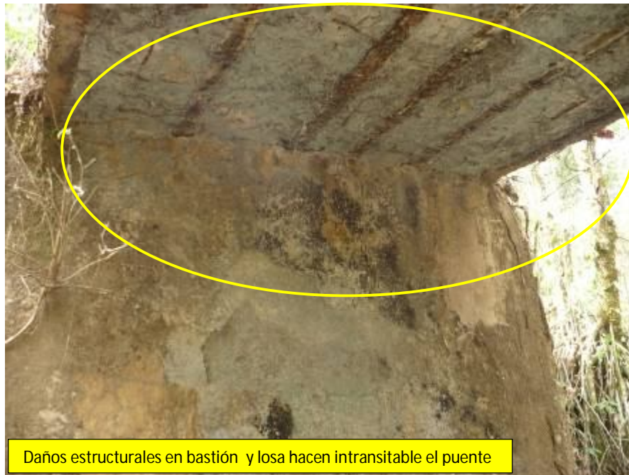
Figura 6. Estado actual de la losa inferior
