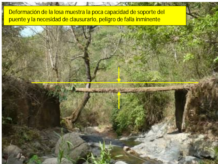
Figura 7. Estado actual de la losa
