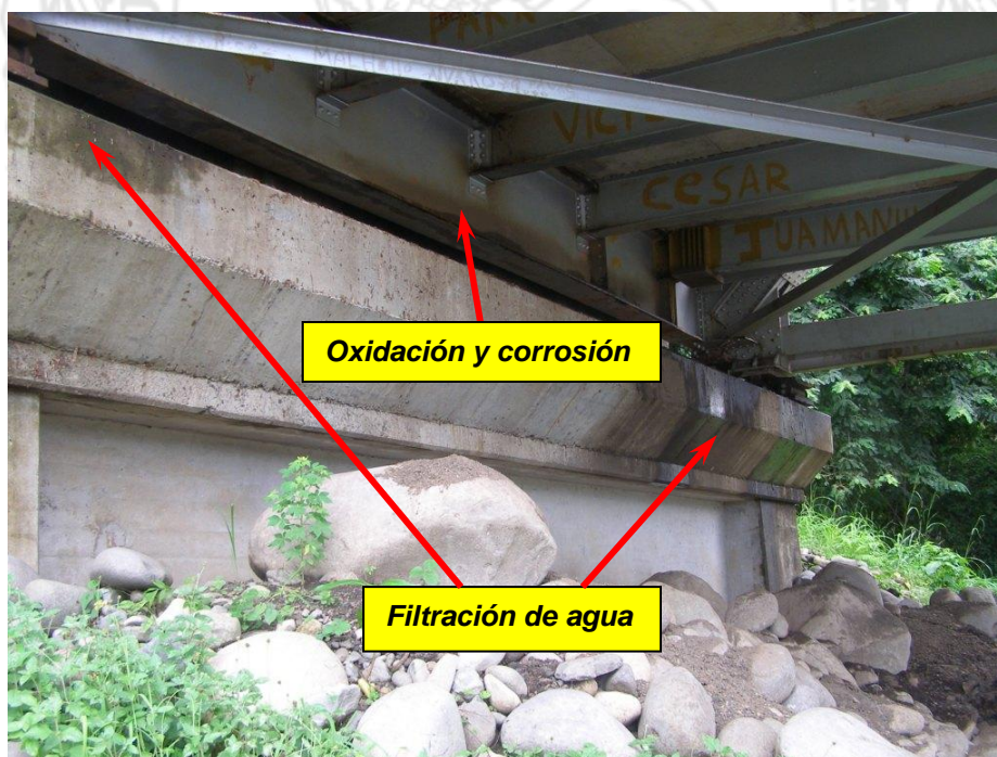
Figura 15. Filtración de agua a través de la junta de expansión sobre el bastión Noroeste y corrosión de la viga transversal.
