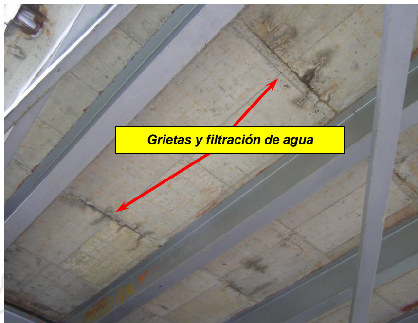
Figura 12. Filtración de agua por las juntas frías de la losa de concreto. La losa presenta agrietamiento en dos direcciones.
