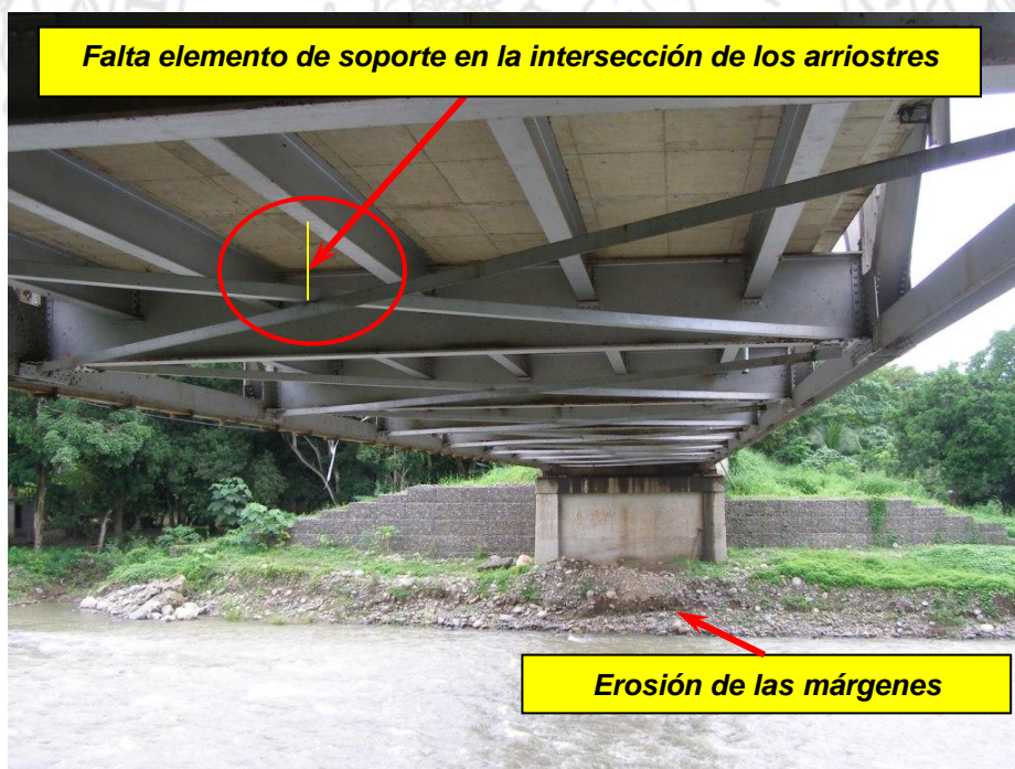
Figura 9. Vista del bastión Sureste mostrando la erosión de la margen frente al bastión y el muro de gaviones junto al bastión. También se muestra la falta del elemento de soporte en la intersección de los arriostres.
