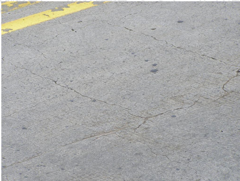
Figura 7. El pavimento está agrietado en dos direcciones.
