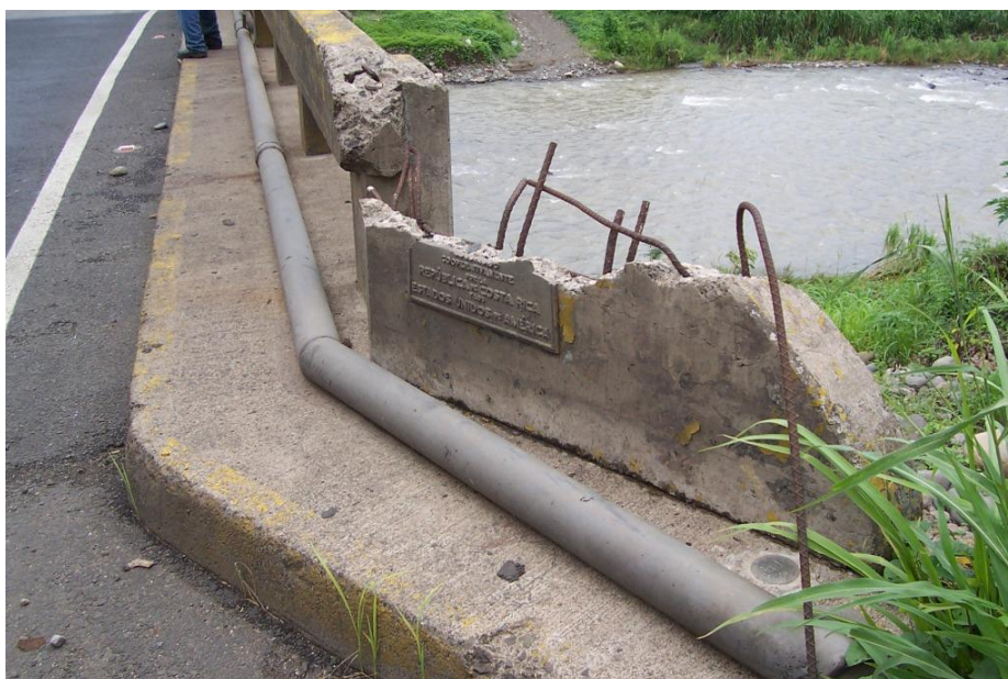
Figura 4. Daño observado en la baranda de concreto del acceso Sureste.
