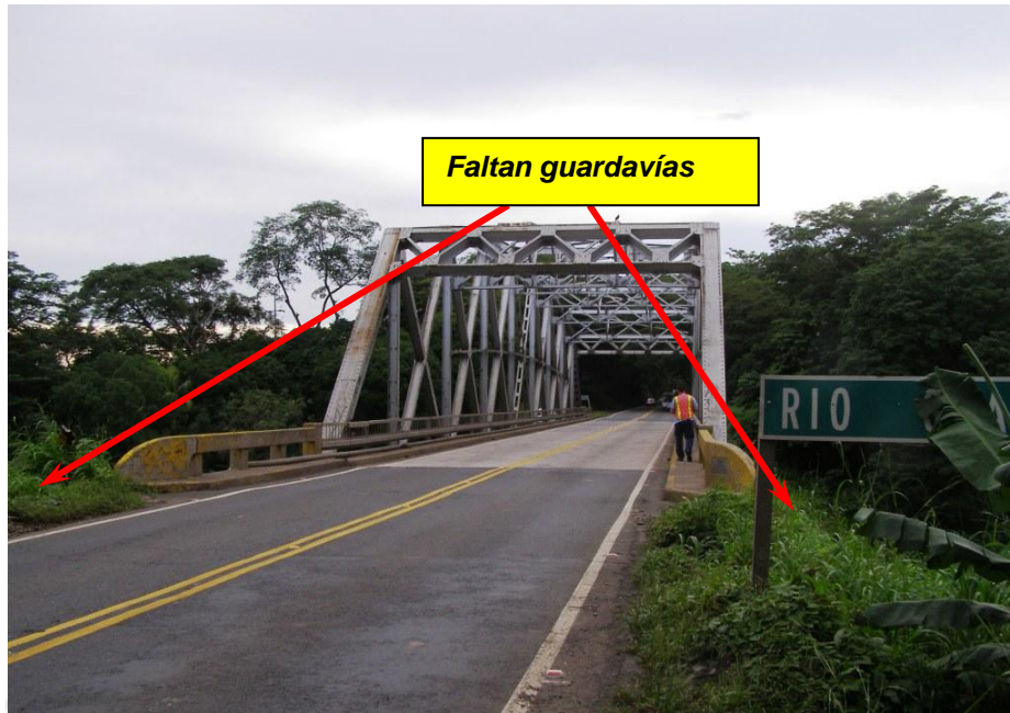
Figura 6. Faltante de guardavías en ambos accesos al puente.
