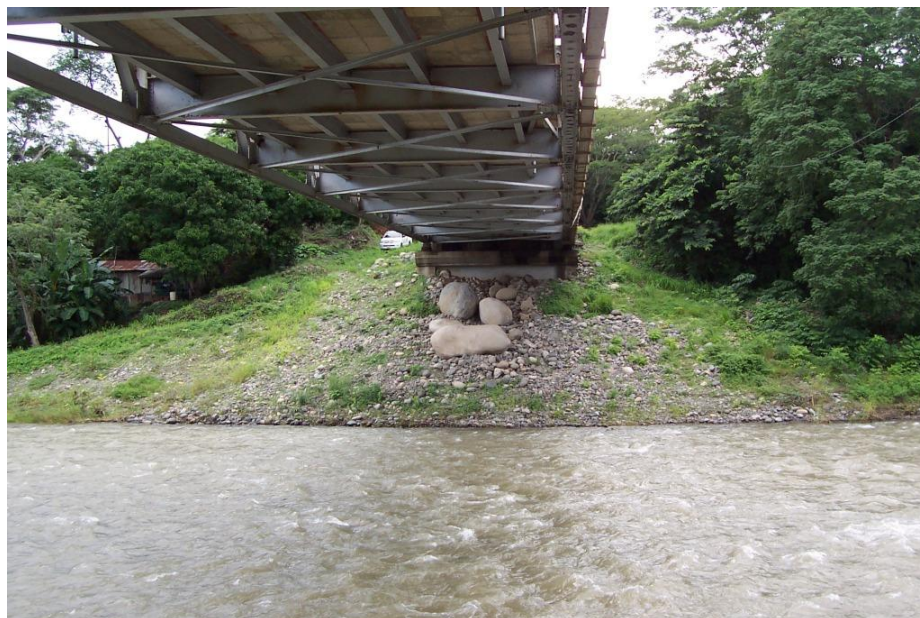
Figura 8. Vista del bastión Noroeste mostrando la erosión del talud junto a los aletones y bajo el bastión.
