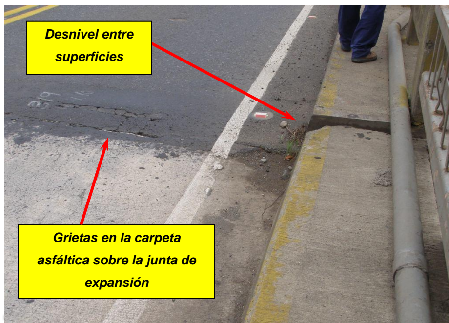
Figura 10. Junta de expansión sobre el bastión Noroeste donde se observa el desnivel entre la superficie del puente y el acceso y las grietas en la carpeta asfáltica sobre la junta.
