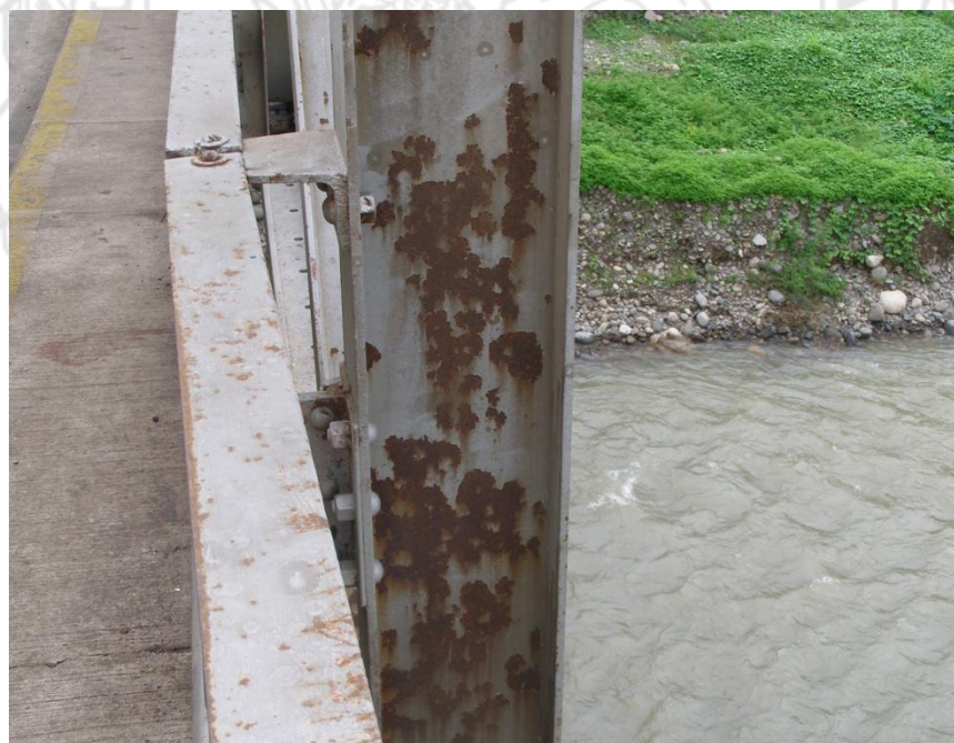
Figura 13. Oxidación, corrosión general y piquetes de corrosión en elementos de la cercha y la baranda.
