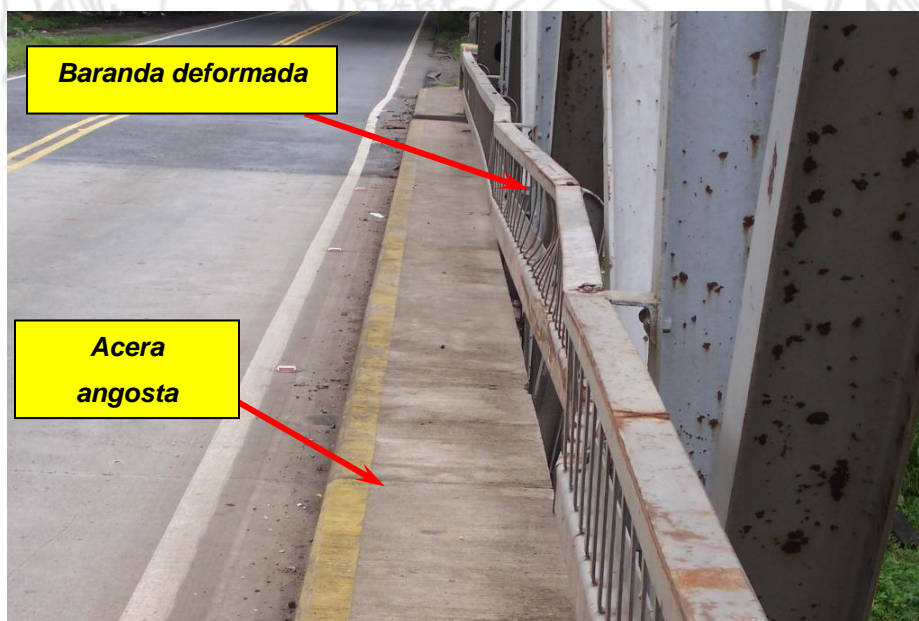
Figura 5. Baranda deformada y acera peatonal angosta.
