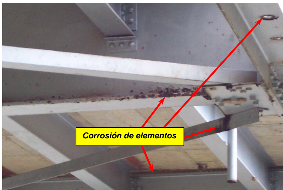
Figura 14. Oxidación y corrosión de las vigas transversales, en los elementos del arriostramiento y en la cuerda inferior de la cercha.
