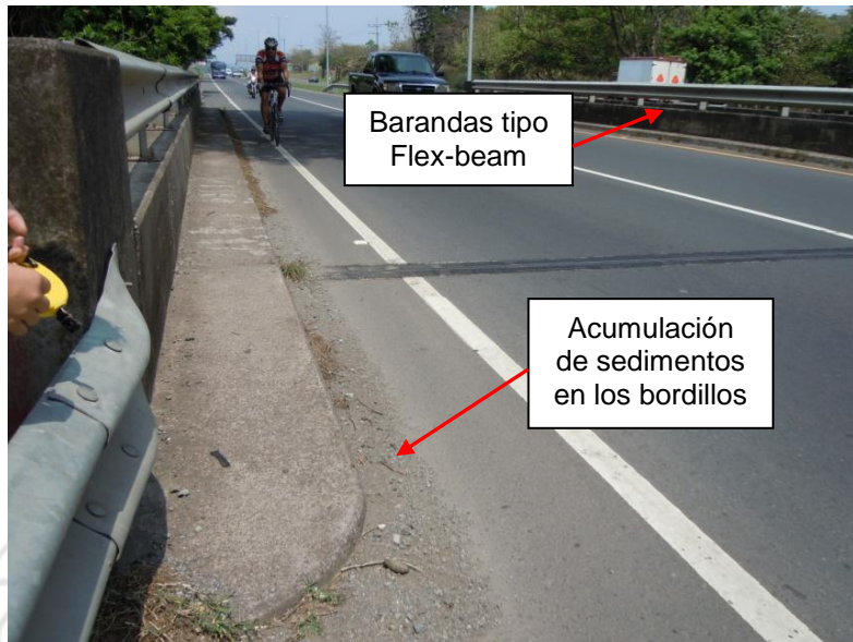
Figura 4: Acumulación de sedimentos
