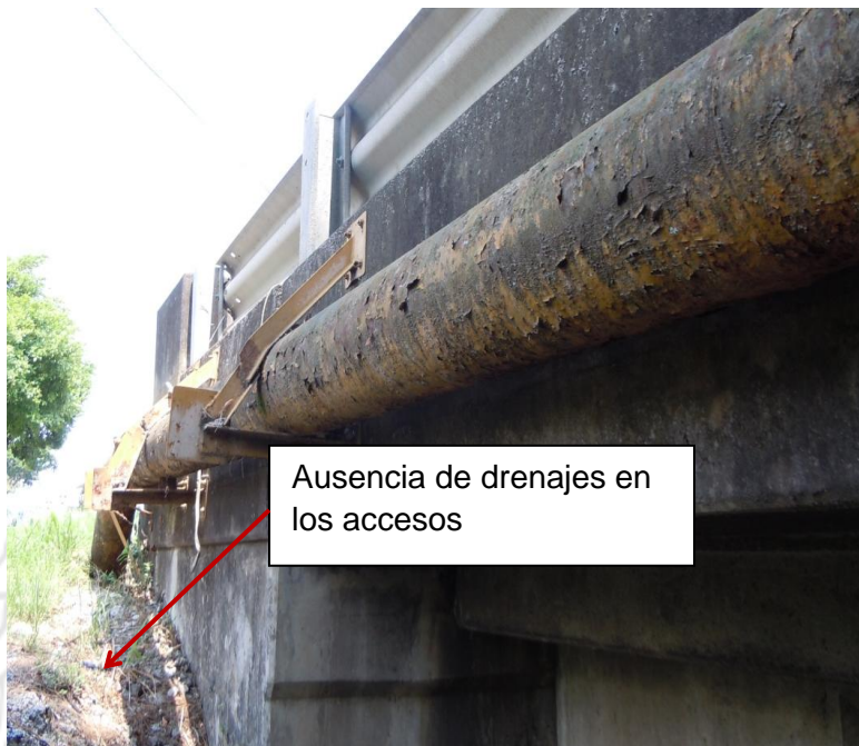
Figura 6: Ausencia de drenajes en los accesos del puente
