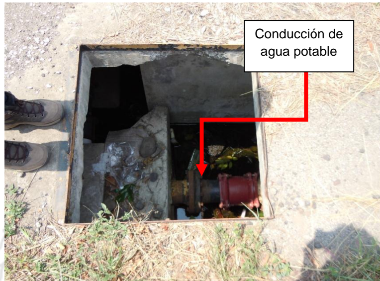
Figura 8: Conducción de agua potable desprotegida.
