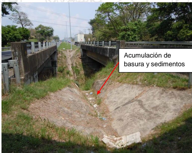
Figura 7: Acumulación de basura y sedimentos en la cuneta central
