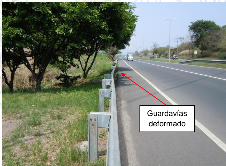
Figura 5: Guardavías deformado en el acceso Oeste
