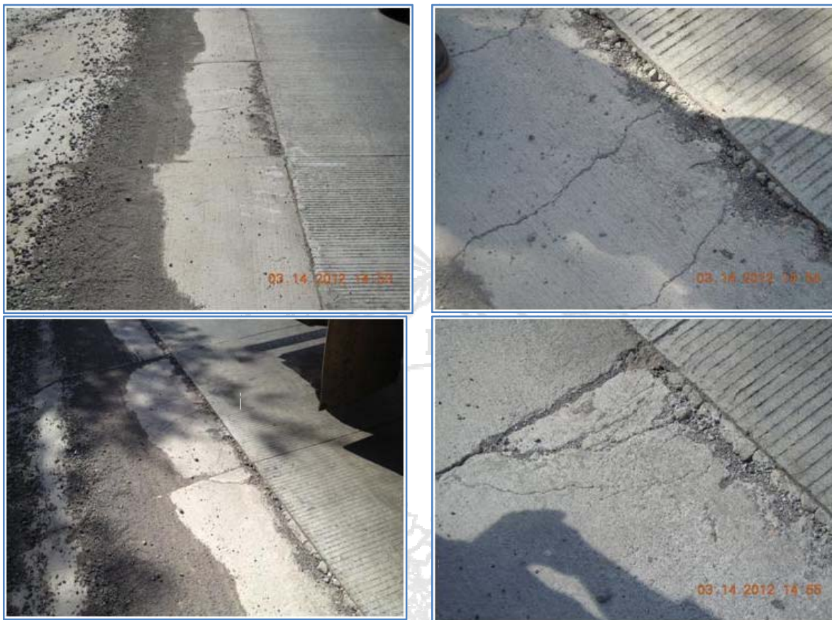
Fotografía 9. Deterioro del espaldón de concreto.
