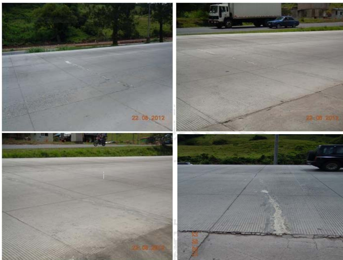
Fotografía 8. Presencia de grietas en las losas de concreto.
