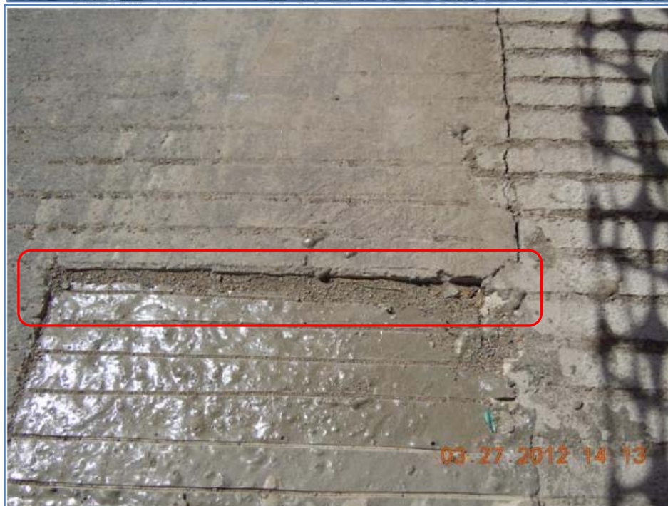
Fotografía 6. Proceso reparación del deterioro de la losa de cemento hidráulico, notéese que el área de corte no abarca la zona completa del agrietamiento o deterioro.
