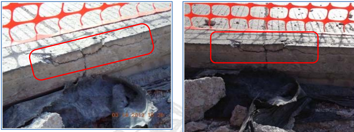
Fotografía 4. Deterioro de los bordes de la losa de cemento hidráulico.
