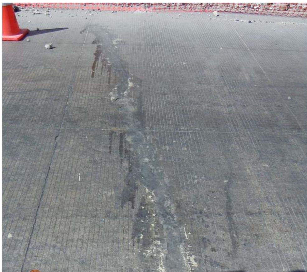
Fotografía 7. Proceso de colocación de la losa de cemento hidráulico. a. Grieta 3. b. Grieta 2 y c. Grieta 1 (según Figura 6)
