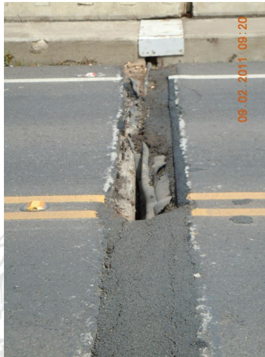
Figura 6. Sello elastomérico suelto, y uso inapropiado de concreto asfáltico para sellar las juntas de expansión.
