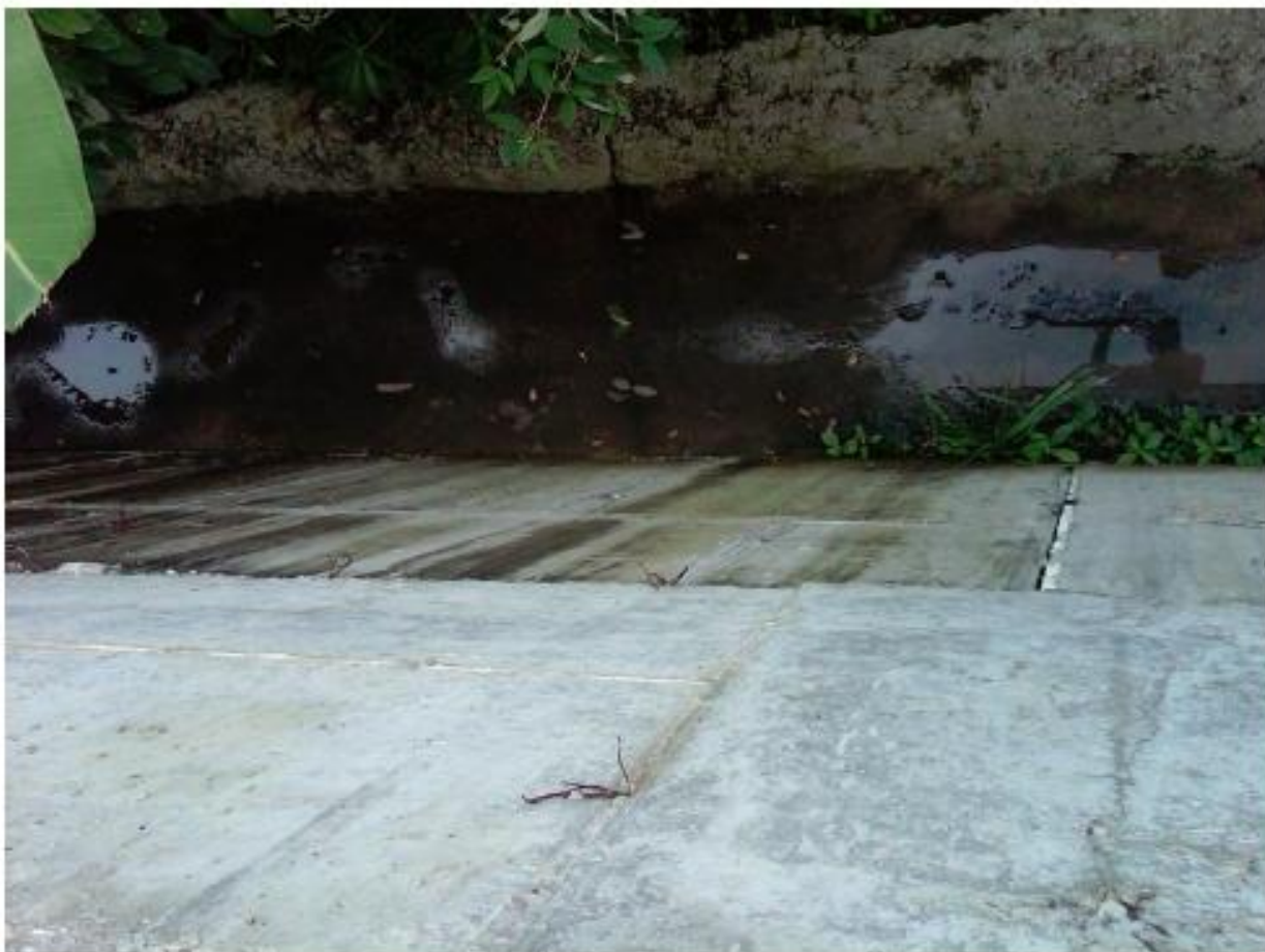
Fotografía 1: Muro de retención observado desde la parte superior donde no se observan drenajes para liberar las presiones de poro
