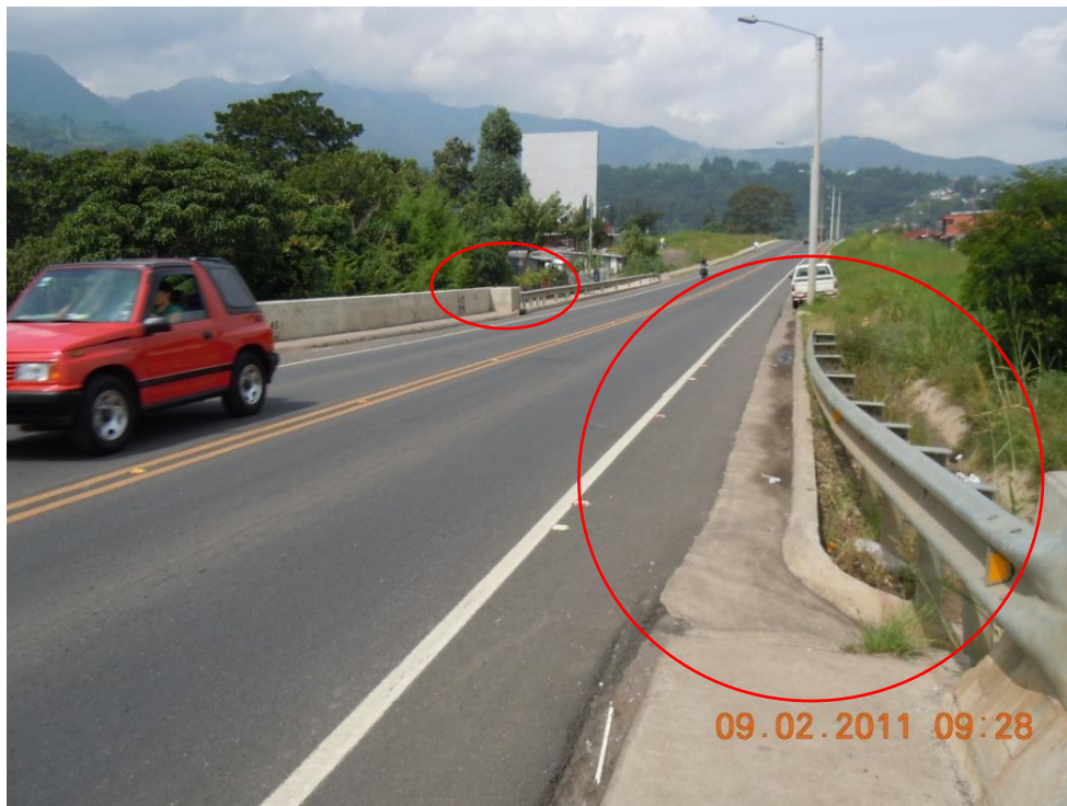
Figura 14. Transiciones inadecuadas entre aceras de calzada y aceras del puente.
