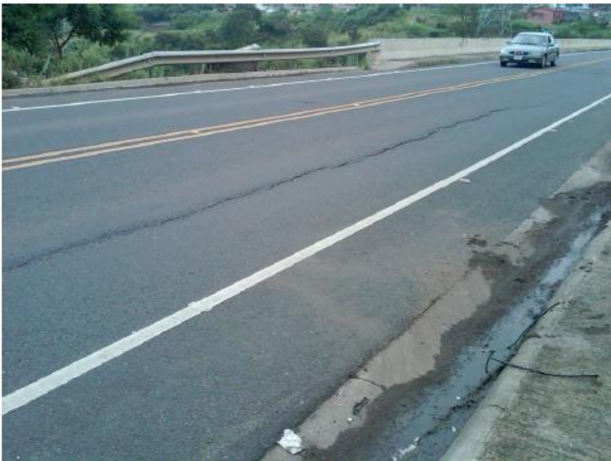
Fotografía 3: Grieta observada en la carpeta asfáltica por encima del muro de retención
