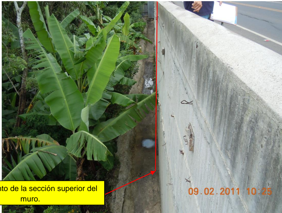
Figura 12. Cara del muro de contención acceso suroeste. (Sin drenajes y con deformación)
