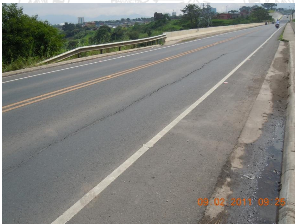
Figura 11. Grieta longitudinal en el pavimento del lado del muro de contención, acceso suroeste.
