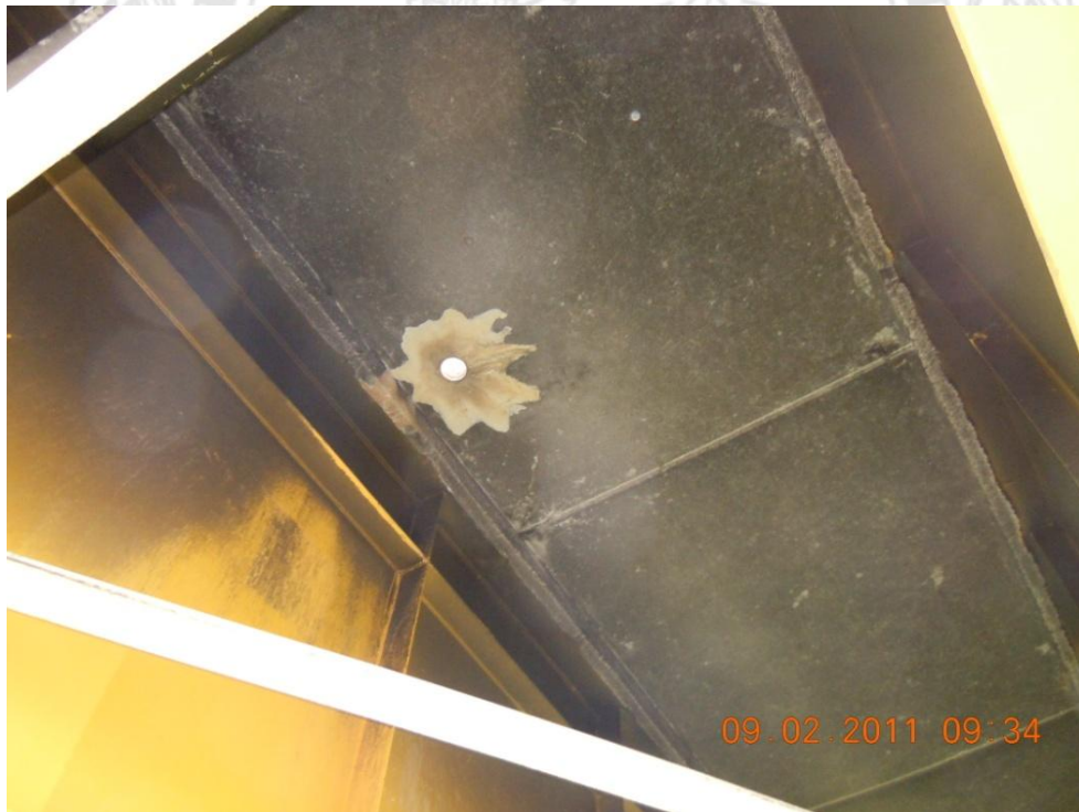
Figura 13. Drenajes de la superestructura sin tubo de extensión.
