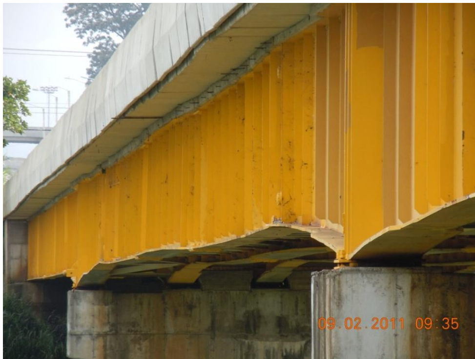
Figura 8. Deformación en el patín inferior de las vigas principales
