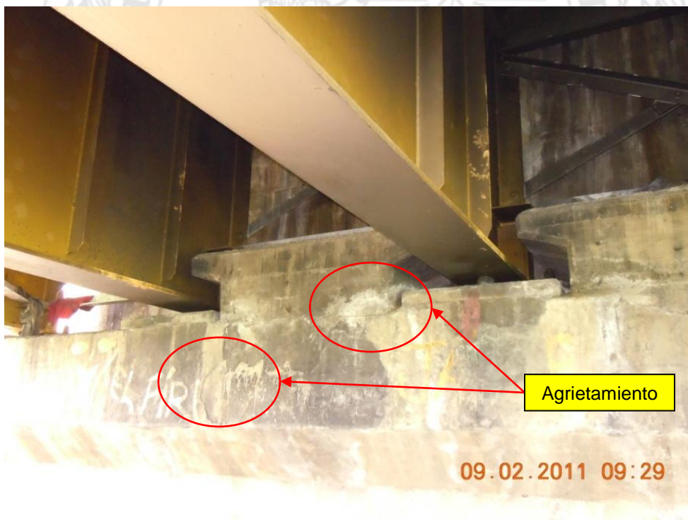
Figura 9. Grietas detectadas junto a una de las llaves de cortante del bastión suroeste
