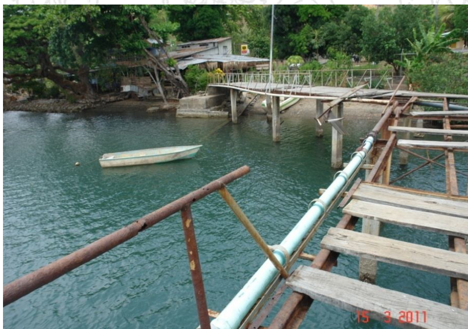
Figura 5. Estado de las barandas de la superficie superior de la superestructura.
