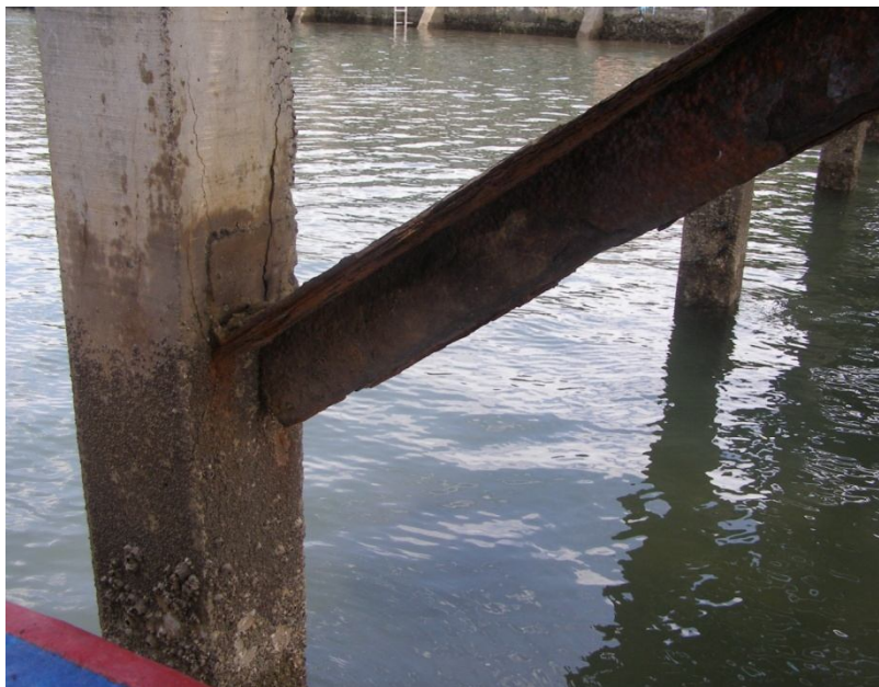
Figura 10. Los elementos de arriostamiento son inadecuados, presentan oxidación generalizada y conexiones deficientes
