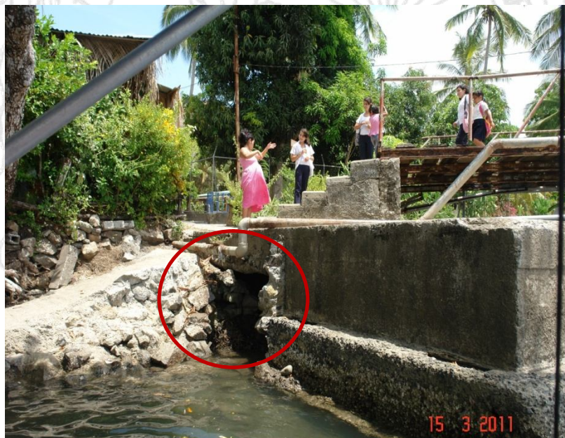
Figura 13. Socavación en el bastión Noroeste.
