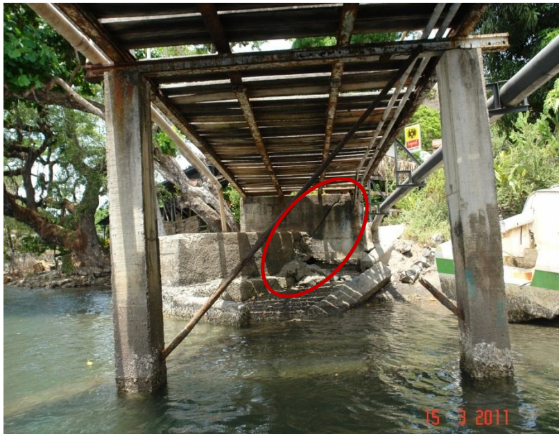
Figura 12. Agrietamiento en el bastión Noroeste.
