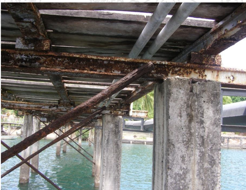
Figura 9. Oxidación y corrosión en las vigas transversales y en los elementos de arriostramiento.
