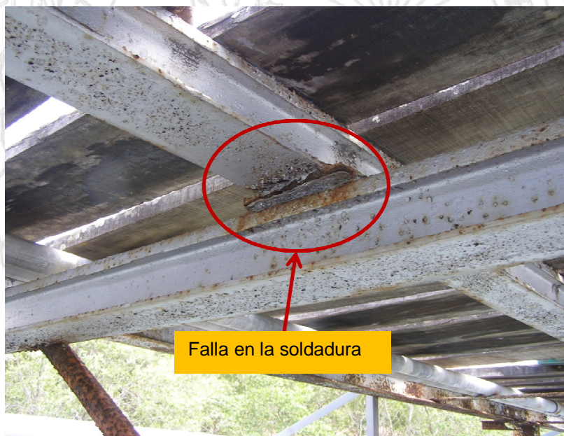
Figura 7. Falla en la soldadura de unión entre una viga transversal y una viga longitudinal.
