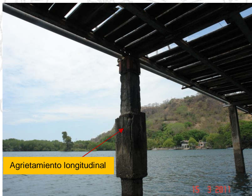
Figura 15. Agrietamiento observado en las columnas a las cuales se les realizó un encamisado con concreto.
