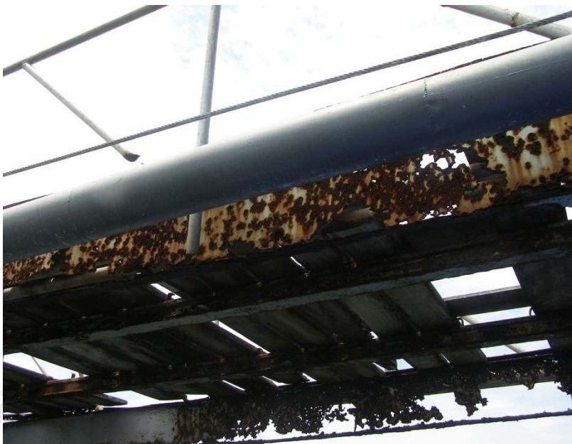
Figura 8. Pérdida casi total de la sección transversal de una viga de acero.
