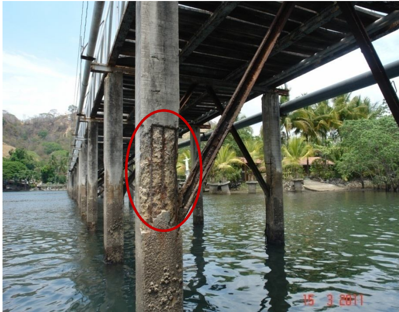
Figura 14. Descascaramiento del concreto y corrosión del acero de refuerzo expuesto.
