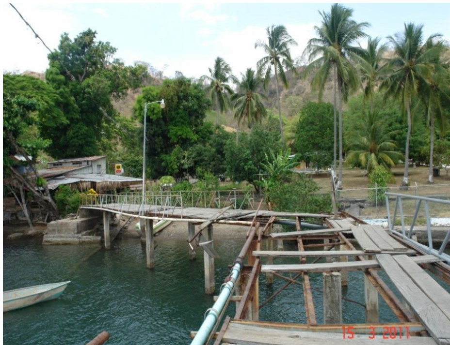
Figura 4. Falta la baranda en más del 10% de la longitud del puente y hay una falta significativa de tablonés.
