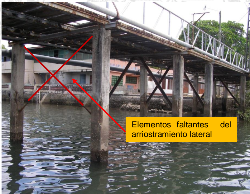
Figura 11. Se observó como varios elementos del arriostamiento lateral se han perdido completamente debido a la corrosión.
