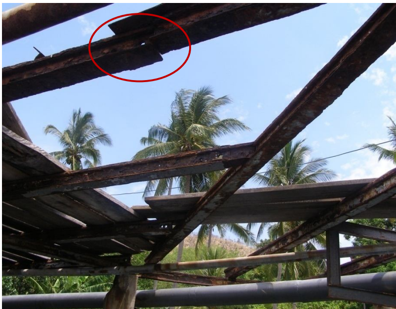
Figura 6. Corrosión generalizada de las vigas principales y conexiones deficientes entre los elementos
