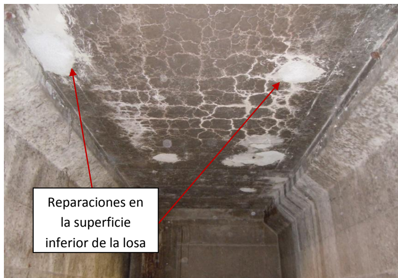
Figura 9: Reparaciones localizadas en la superficie inferior de la losa del puente, agrietamiento en dos direcciones y eflorescencias.
