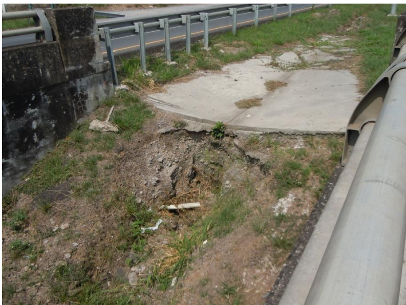
Figura 5: Terminación inadecuada de la cuneta en la medianera
