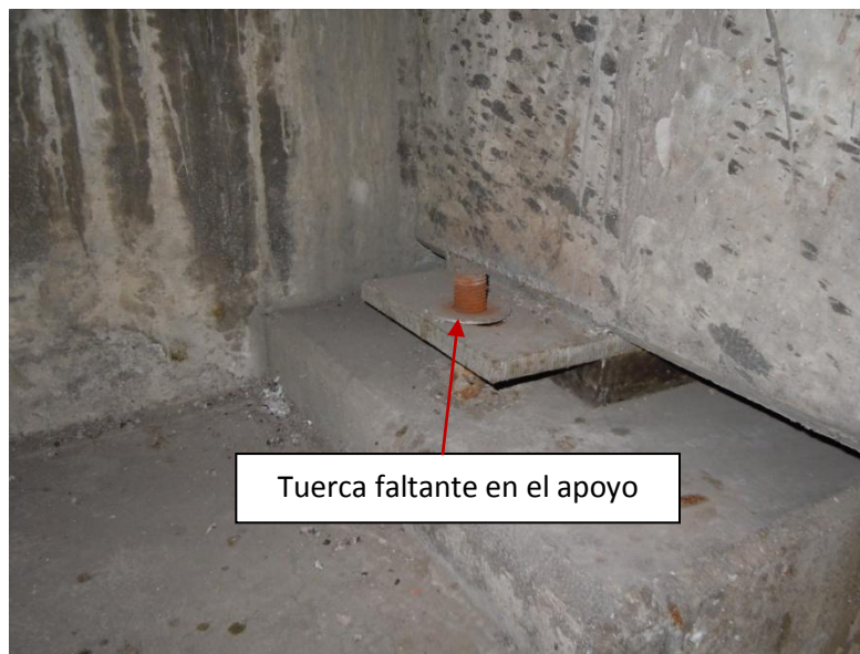
Figura 10: Apoyo en el que se ha perdido la tuerca del perno de anclaje
