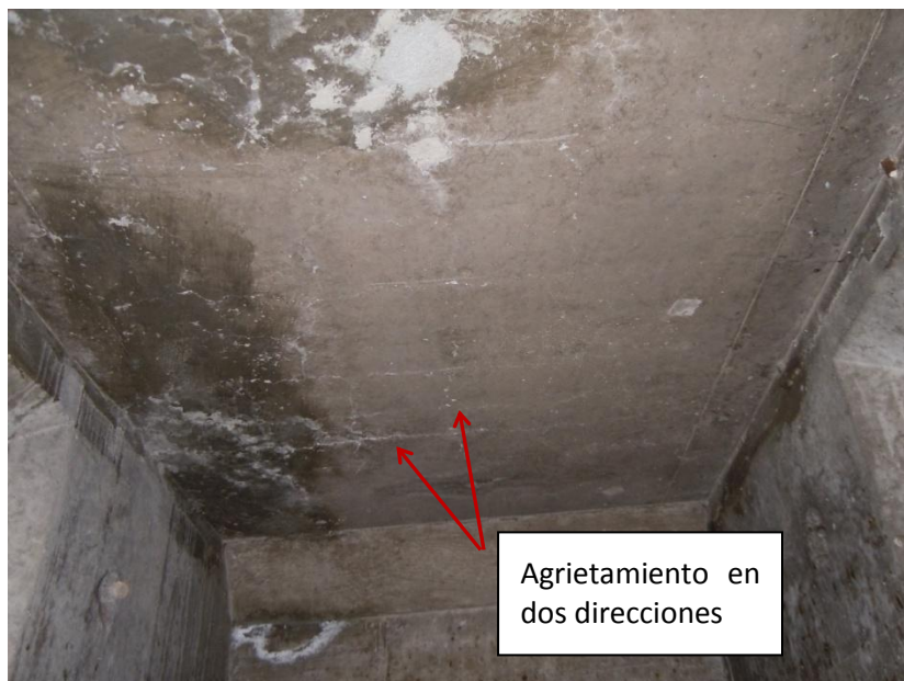
Figura 8: Agrietamiento en dos direcciones y eflorescencias en la superficie inferior de la losa del puente
