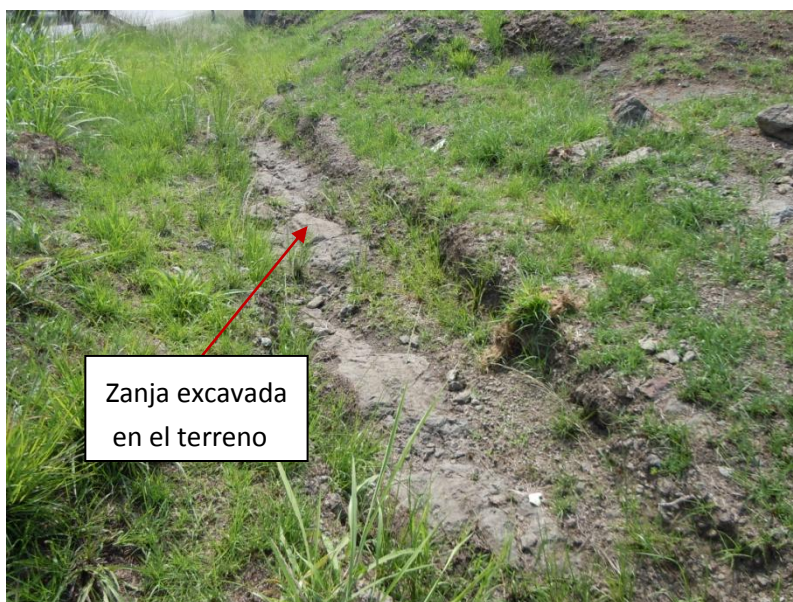
Figura 4: Ausencia de drenajes adecuados en los accesos
