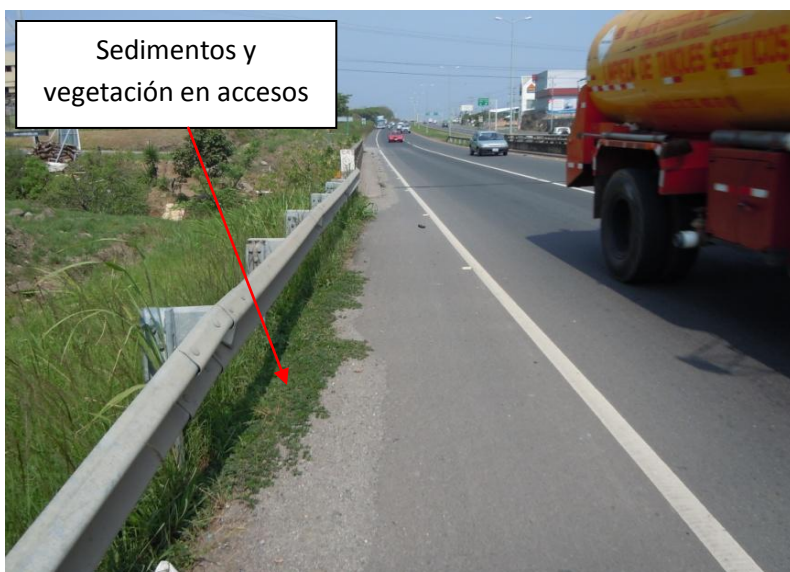
Figura 6: Acumulación de sedimentos y vegetación en el espaldón de los accesos al puente
