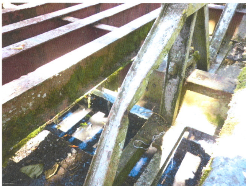
Figura 4. Barandas presentan importantes deformaciones en algunos de sus elementos.
