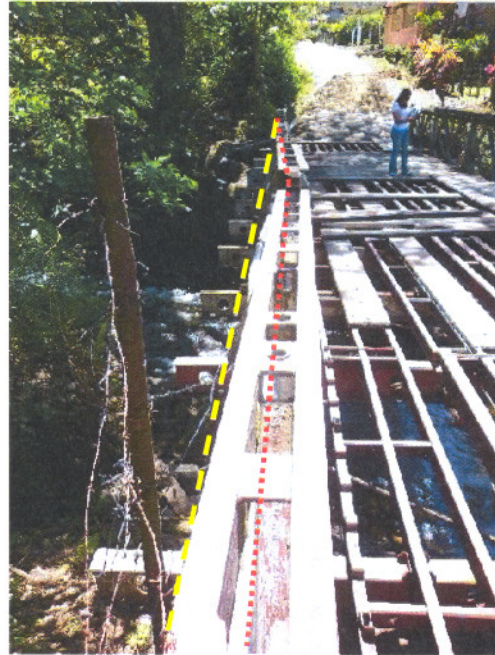
Figura 5. Deformación longitudinal del puente evidencia sobrecargas y problema estructural.
