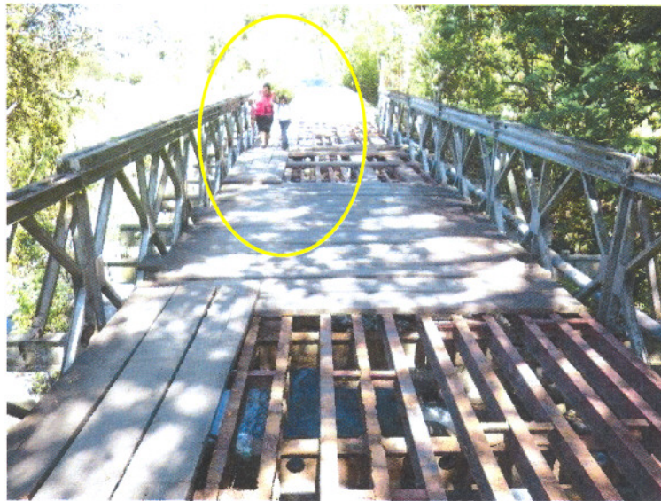
Figura 6. Usuarios continúan utilizando el puente a pesar de su mal estado. Peligro latente.
