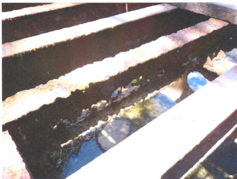
Figura 9. Pérdida de sección en elementos estructurales.
