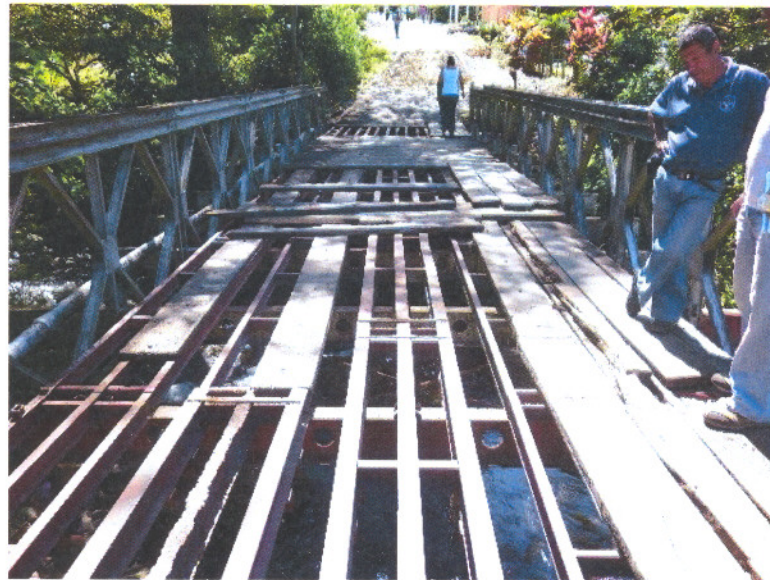
Figura 7. Ausencia de tablas en la superficie de ruedo genera una situación de peligro para los peatones.
