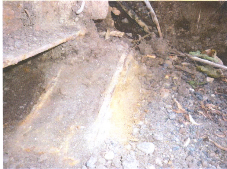
Figura 11. Apoyos de puente ya no cumplen su función estructural.
