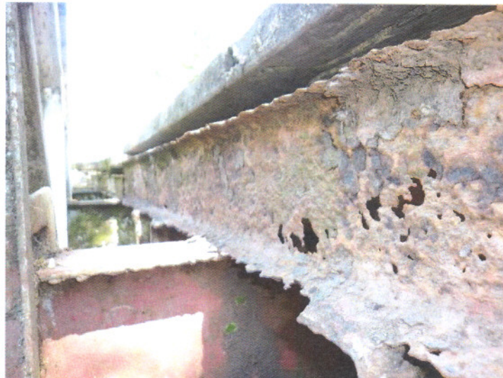
Figura 8. Corrosión en elementos de piso y pérdida de sección de los elementos.
