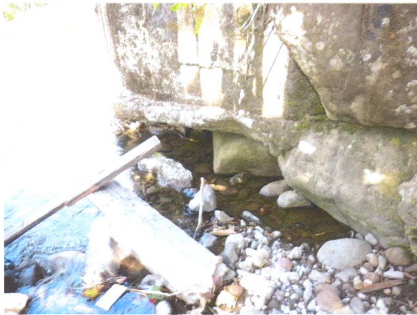
Figura 12. Socavación observada en los bastiones.
