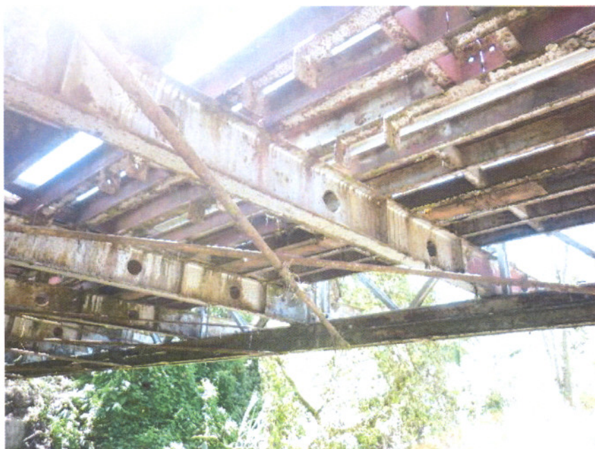
Figura 10. Oxidación y corrosión avanzada en elementos metálicos del puente.
