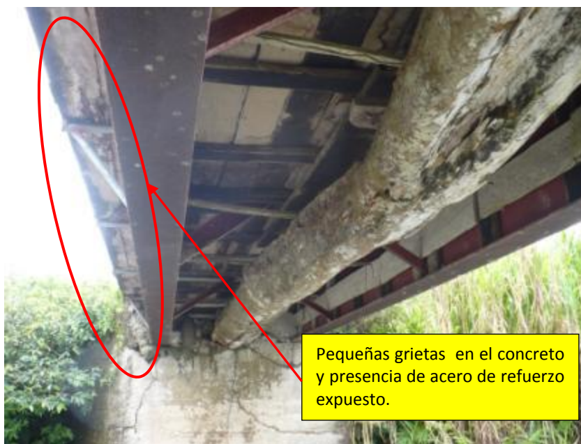
Figura 9. Daño en la superficie inferior de la losa.
