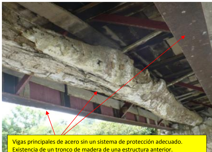
Figura 10. Condición de las vigas principales.
