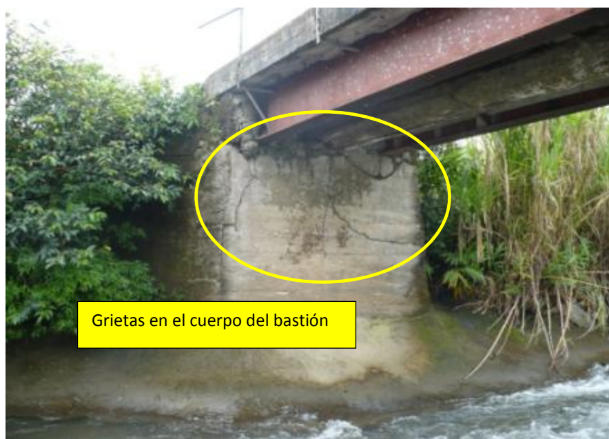
Figura 11. Grietas observadas en el bastión de la margen derecha.
