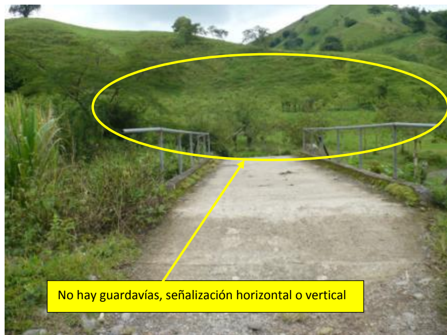
Figura 5. Señalización vertical y horizontal inexistente.
