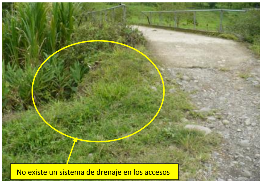
Figura 6. Ausencia de un sistema de drenaje o cunetas.
