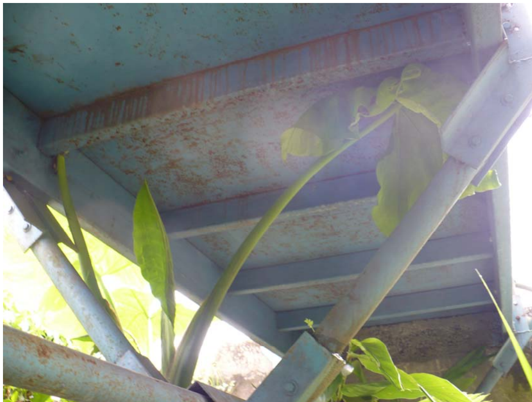
Figura 15. Corrosión generalizada de los elementos del puente peatonal
