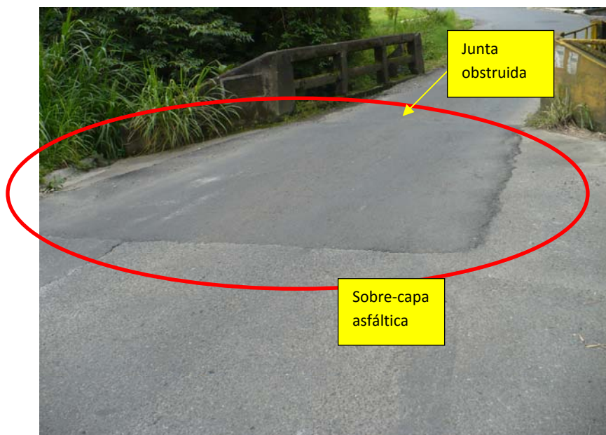
Figura12. Ondulaciones en la sobre-capa asfáltica y juntas obstruidas.
