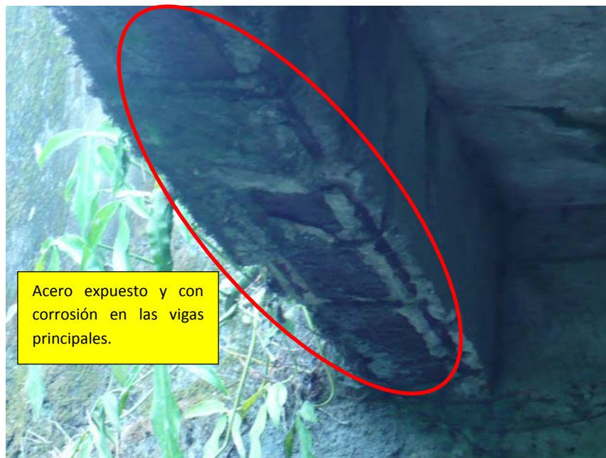
Figura 14. Desprendimiento de concreto, acero expuesto y con corrosión.
