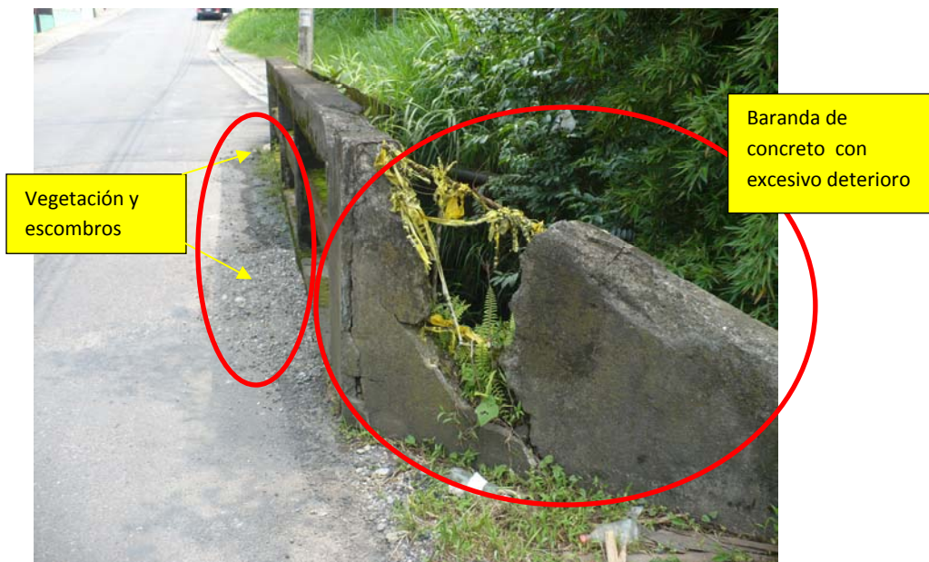
Figura 8. Estado de deterioro de la baranda de concreto y acumulación de vegetación y sedimentos en bordillo.
