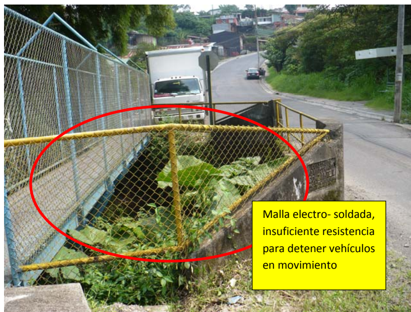
Figura10. Sistema de contención inadecuado.
