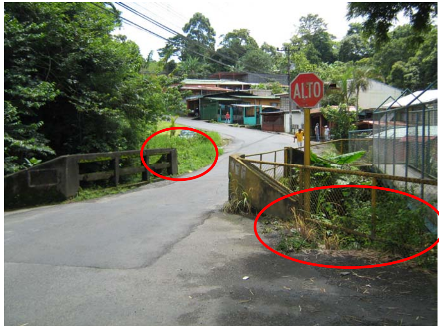
Figura 13. Drenajes de los accesos inadecuados.
