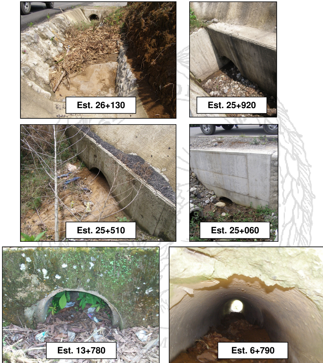
Figura 15. Cunetas y alcantarillas con sedimentos, vegetación y basura.
