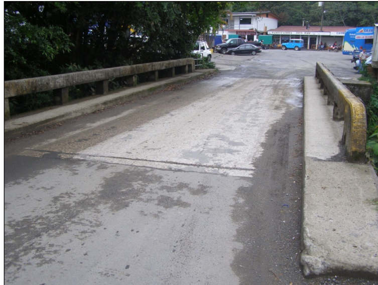
Figura 29. Puentes No. 2 sobre el río Sabalito. Estado del puente al 9 de marzo de 2011.
