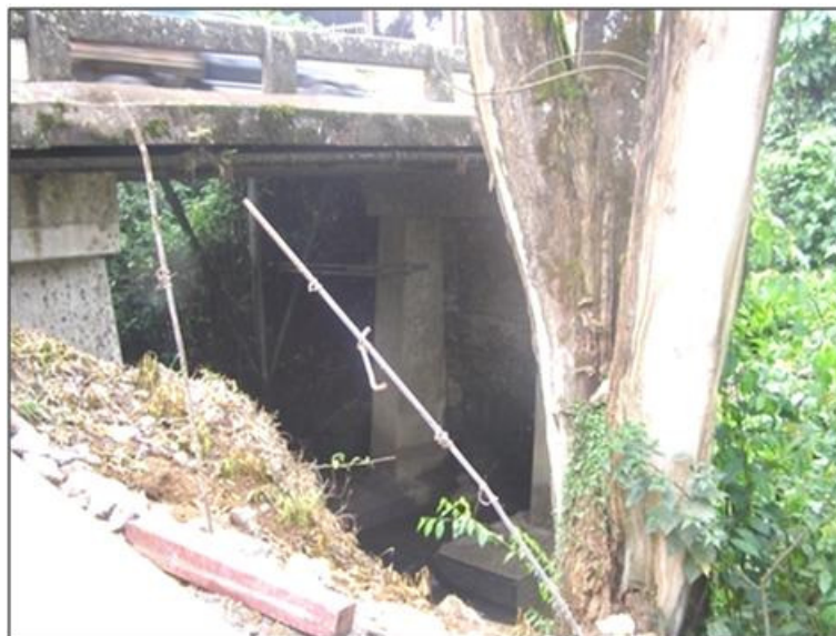
Figura 28. Puente No. 1 sobre el río Sabalito. Estado del puente al 9 de marzo de 2011.
