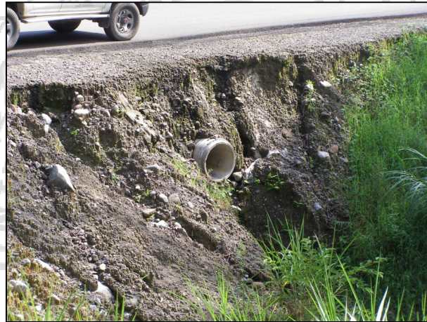
Figura 14. Alcantarilla sin estructura de protección a la salida en Est. 29+530. Estado de la estructura al 17 de mayo de 2011.
