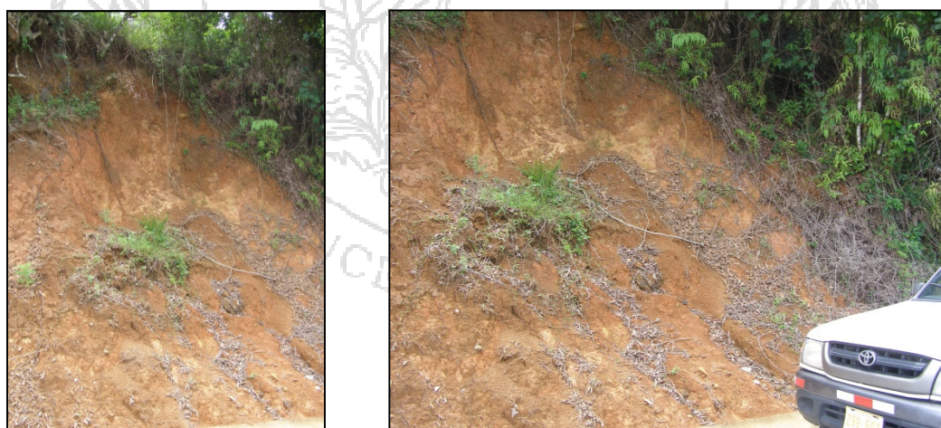
Figura 20. Deslizamientos registrados en estacionamiento 24+020.
