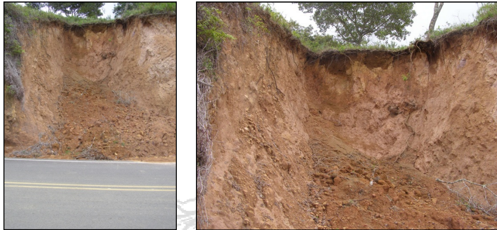
Figura 21. Deslizamientos registrados en estacionamiento 23+470. Estado del deslizamiento al 17 de mayo de 2011.
