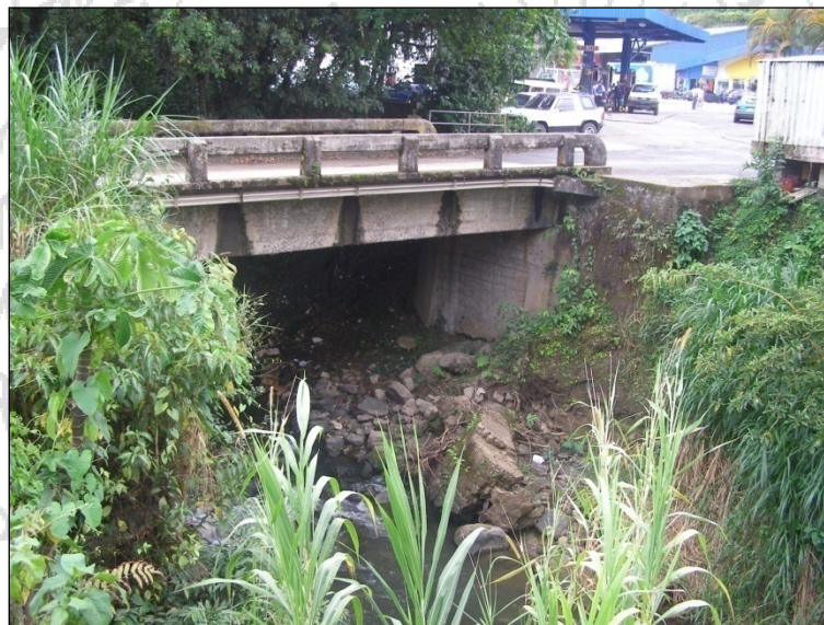
Figura 30. Puentes No. 2 sobre el río Sabalito. Estado del puente al 9 de marzo de 2011.
