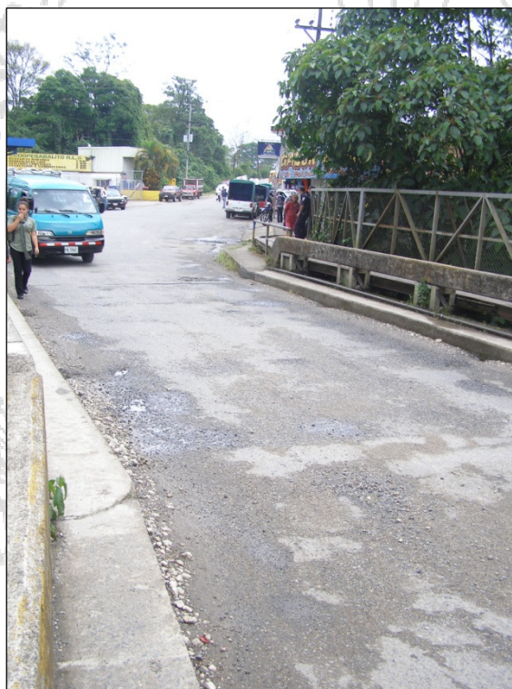
Figura 27. Puente No. 1 sobre el río Sabalito. Estado del puente al 9 de marzo de 2011.
