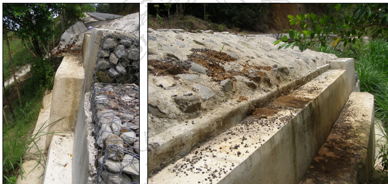
Figura 24. Muro de gaviones entre estacionamientos 24+110 y 24+120. Estado del muro al 17 de mayo de 2011.
