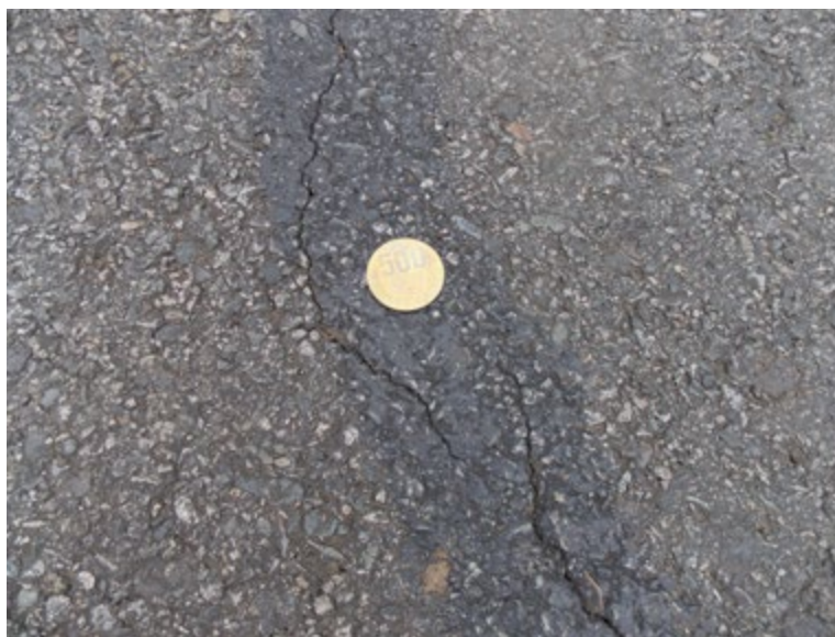
Figura 9: Agrietamiento en el pavimento, est. 66+110, año 2017.
