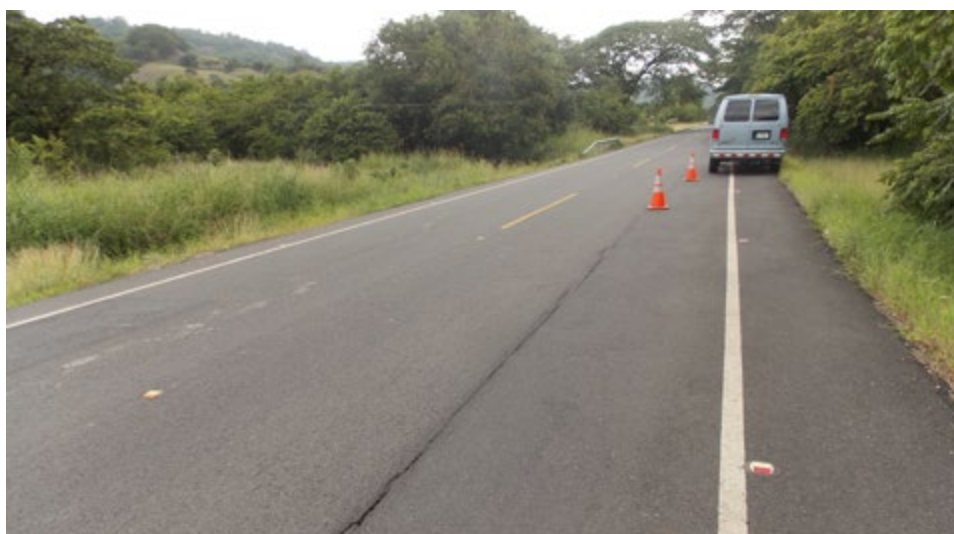
Figura 6: Agrietamiento longitudinal en la carpeta asfáltica, est. 5+315, año 2014
