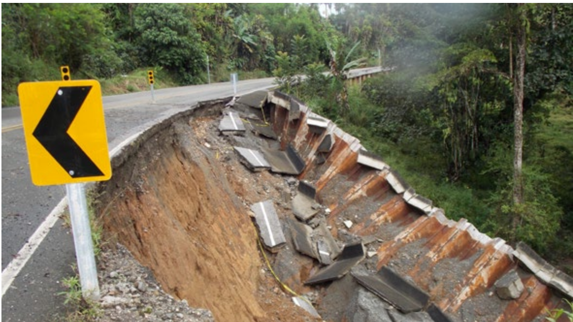
Figura 4: Falla parcial del muro del terraplén en el est. 15+400, año 2017.
