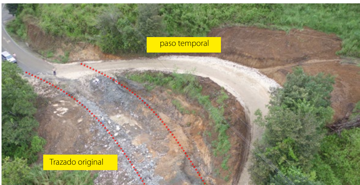
Figura 5: Falla del terraplén en el est. 15+700, año 2017.
