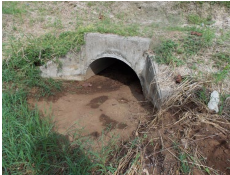
Figura 8: Sedimentación severa en la alcantarilla en la est. 4+580, año 2017.
