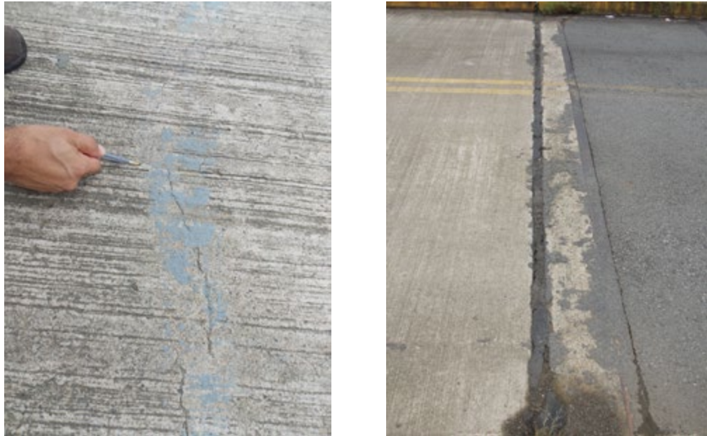
Figura 10: Agrietamientos en el tablero del puente sobre el Río Rincón (izq.); estado de la junta del lado este del mismo puente (der.); año 2015.
