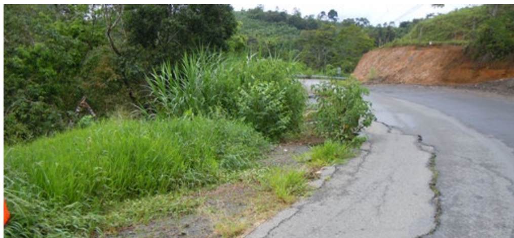
Figura 3: Deslizamiento de terraplén en el est. 15+700, afectando un carril, tal y como se presentó durante la visita del año 2013. Nótese la falta de señalización preventiva.
