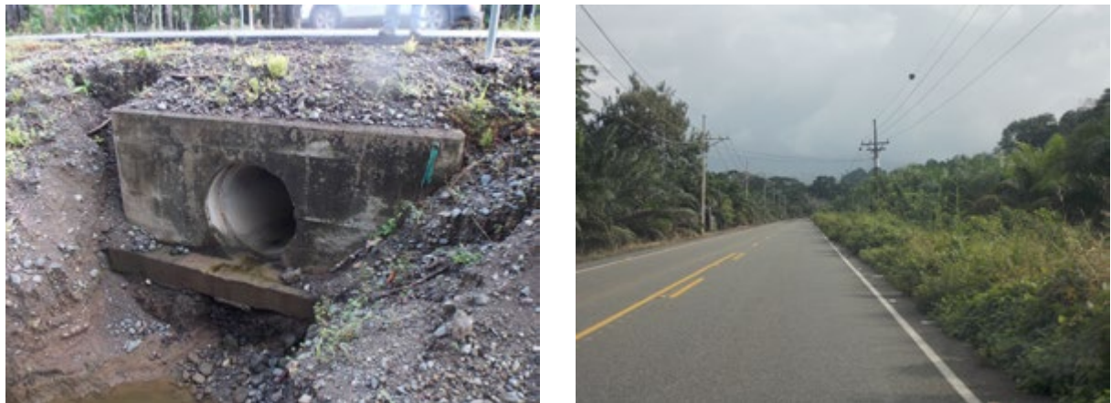
Figura 11: Socavación a la salida de la alcantarilla en el est. 45+550 (izq.); crecimiento de vegetación sin control, a los lados de la ruta, est. 53+500 (der.); año 2017.
