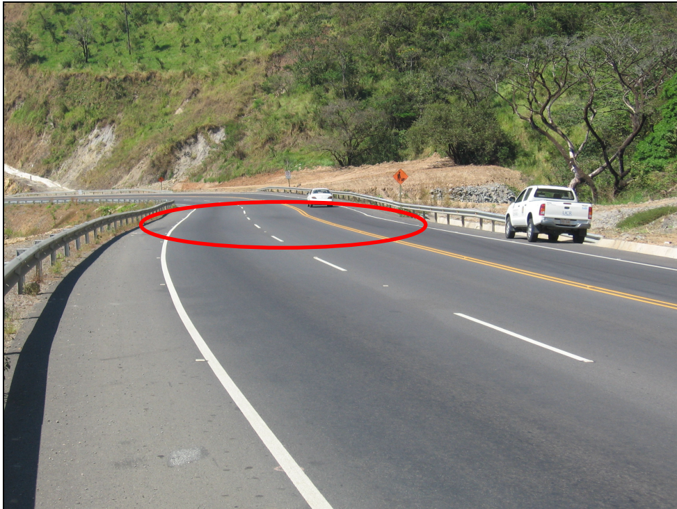
Figura 14. Desnivel en la carpeta, kilómetro 44+510 (al 19 de enero de 2011).
