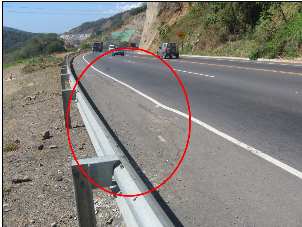
Figura 12. Grietas en el pavimento (al 19 de enero de 2011).
