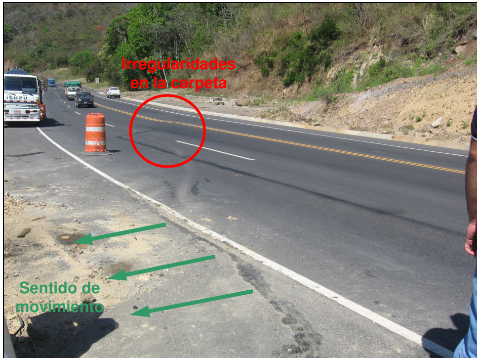
Figura 8. Vista general del tramo entre los Est. 38+700 a Est. 38+800. (al 19 de enero de 2011).
