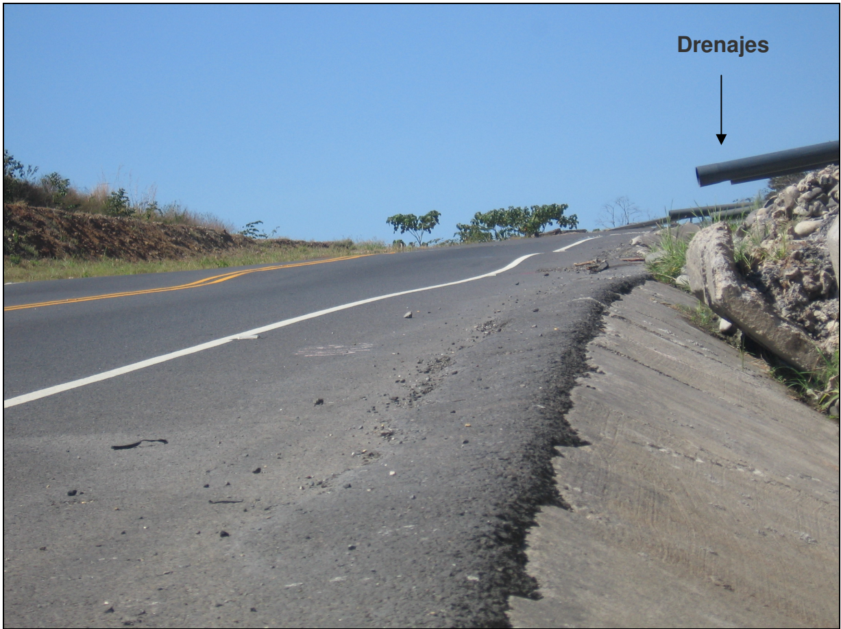
Figura 6. Deformaciones en la carpeta y cuneta (LD Km 36+400) (al 19 de enero de 2011).
