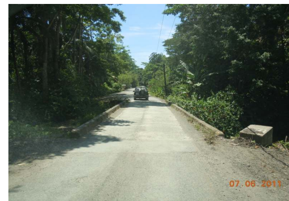
N°72 Estación 13+500, hacia Manzanillo. Superficie con lastre. Puente sin barandas, ni sistema de contención vial en los accesos
