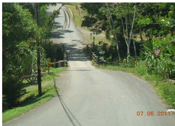
N°80 Estación 15+900, hacia Manzanillo. Superficie con tratamiento superficial. Puente con inadecuado sistema de contención vial en los accesos
