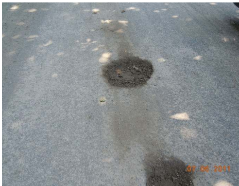
N°4 Estación 9+650, hacia Manzanillo. Huecos en el centro de calzada
