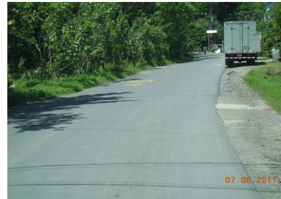
N°66 Estación 11+900, hacia Hone Creek. Superficie con capa asfáltica delgada. Invación de vegetación en cuneta
