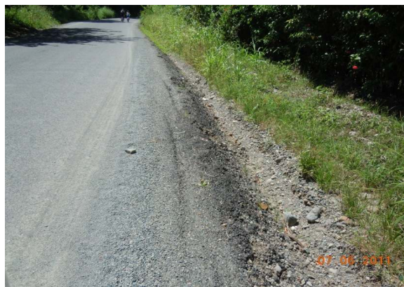
N°38 Estación 6+650, hacia Manzanillo. Superficie con tratamiento superficial. Material de secado para el tratamiento superficial Cuneta inadecuada
