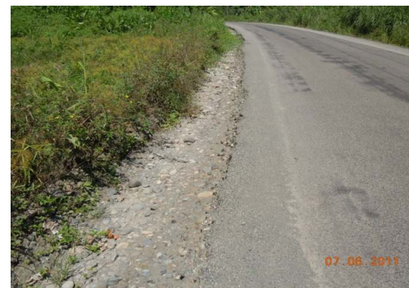
N°15 Estación 2+200, hacia Manzanillo. Superficie con tratamiento superficial. Exudación y agregado expuesto
