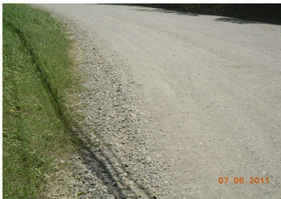
N°55 Estación 9+700, hacia Manzanillo. Termina superficie con tratamiento superficial e inicia lastre. Huecos, roderas y desprendimiento de agregado
