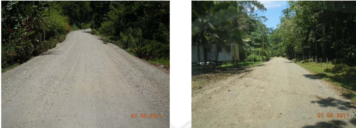
Figura 18. Estación 13+400 y 16+400: roderas, huecos y desprendimiento de agregados.
