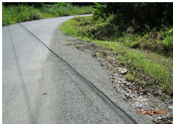
N°20 Estación 2+600, hacia Manzanillo. Superficie con tratamiento superficial. Borde dañado y cuneta inadecuada
