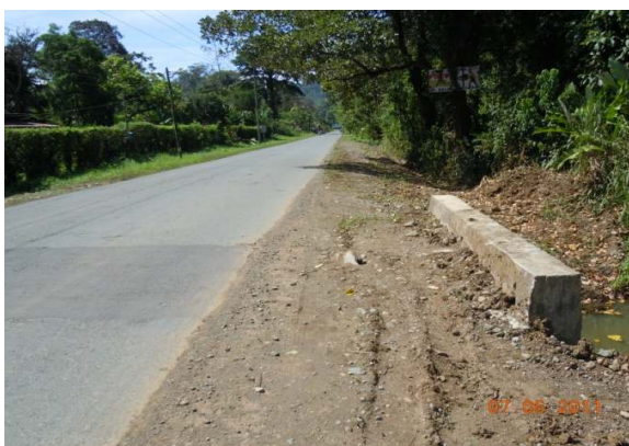
N°4 Estación 0+300, hacia Manzanillo. Superficie con capa asfáltica delgada. Alcantarilla con espesor de corona inadecuado.
