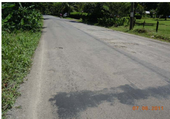
N°43 Estación 8+100, hacia Manzanillo. Superficie con tratamiento superficial. Huecos en ambos carriles y exudación Cuneta inadecuada.
