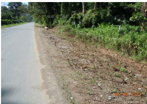
N°1 Estación 0+300, hacia Manzanillo. Inicia superficie con capa asfáltica delgada. Cuneta inadecuada_agua estancada. Material suelto que por la lluvia puede obstruir la cuneta.
