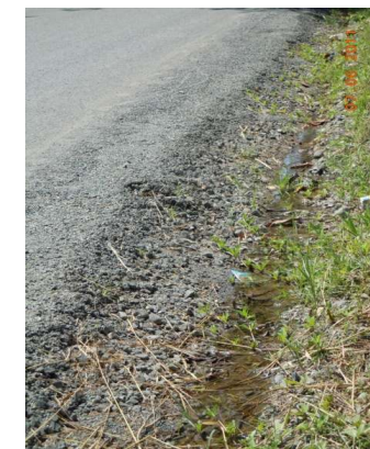
N°30 Estación 4+400, hacia Manzanillo. Superficie con capa asfáltica delgada Cuneta inadecuada agua empozada
