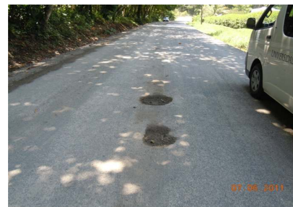
N°51 Estación 9+650, hacia Manzanillo. Superficie con tratamiento superficial. Huecos y agregado expuesto.
