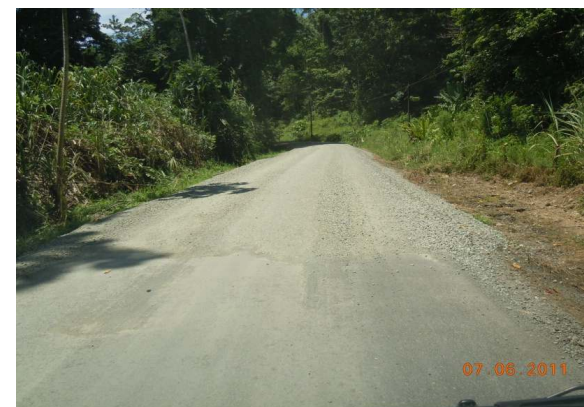
N°69 Estación 13+200, hacia Manzanillo. Termina superficie con capa asfáltica delgada e inicia lastre. Cuneta interrumpida e invasión de vegetación
