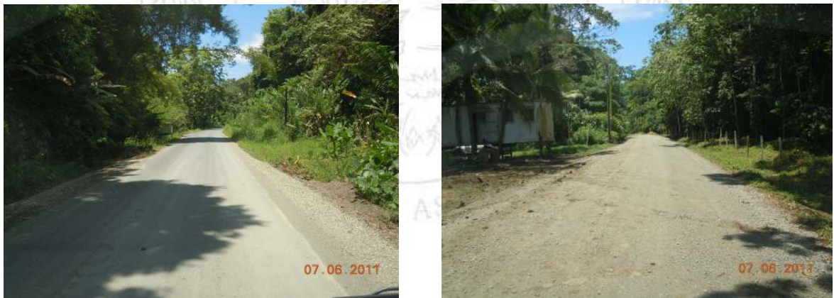
Figura 26. Estación 15+000: cuneta interrumpida con escombros e invasión de vegetación. Estación 16+400: cuenta inadecuada con falta de definición geométrica. (Fecha de fotografías 7-jun-2011) (Fuente: Pitra-LanammeUCR)
