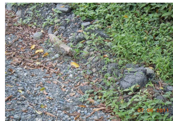
N°57 Estación 9+800, hacia Manzanillo. Superficie con lastre con escombros en las cunetas
