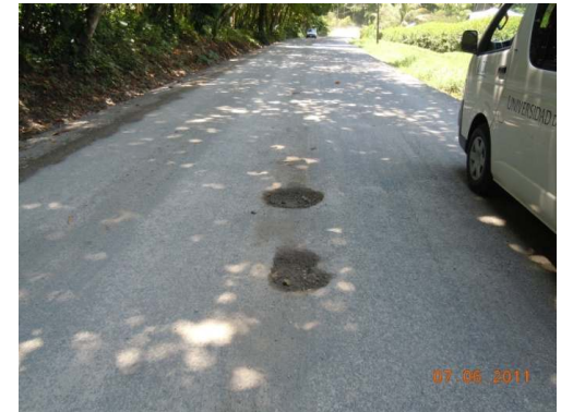
N°3 Estación 9+650, hacia Manzanillo. Huecos en el centro de calzada
