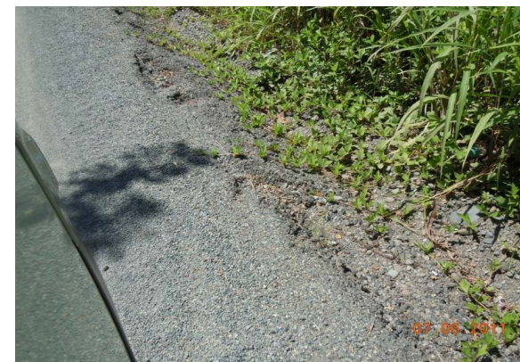
N°39 Estación 6+700, hacia Manzanillo. Superficie con tratamiento superficial. Material de secado para el tratamiento superficial Cuneta inadecuada
