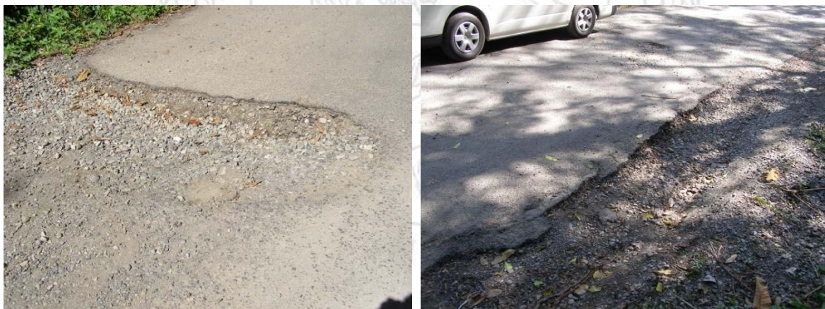
Figura 3. Huecos y desprendimientos en las zonas de carpeta asfáltica deteriorada y tratamientos superficiales.
