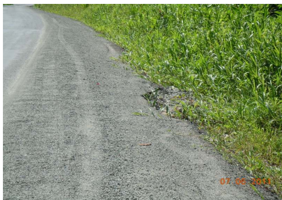
N°19 Estación 2+600, hacia Manzanillo. Superficie con tratamiento superficial. Borde dañado y cuneta inadecuada
