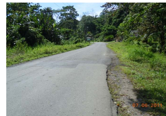
N°6 Estación 1+300, hacia Manzanillo Termina capa asfáltica delgada e inicia tratamiesto superficial Bacheo y borde dañado, no hay cunetas.
