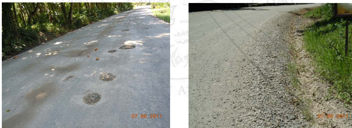
Figura 24. Estación 9+650: pendiente transversal inadecuada. Estación 10+100 al 10+400: falta definición geométrica en la cuneta. (Fecha de fotografías 7-jun-2011) (Fuente: Pitra-LanammeUCR)
