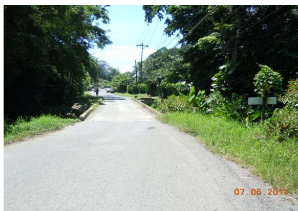
N°47 Estación 8+800, hacia Hone Creek. Superficie con tratamiento superficial. Puente sin barandas, ni sistema de contención vial en los accesos Sin señalización preventiva de puente angosto
