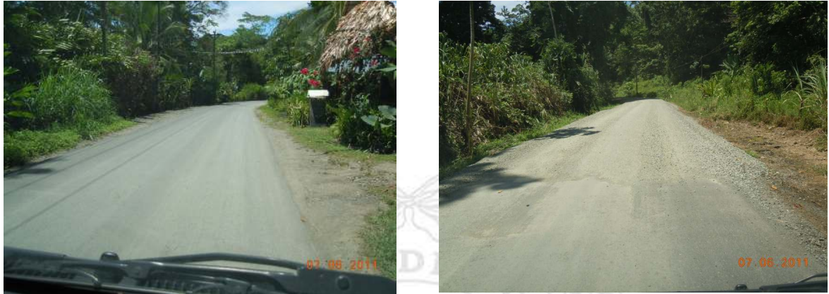
Figura 25. Estación 11+100: sin cunetas. Estación 13+200: cuneta interrumpida invasión de vegetación. (Fecha de fotografías 7-jun-2011) (Fuente: Pitra-LanammeUCR)
