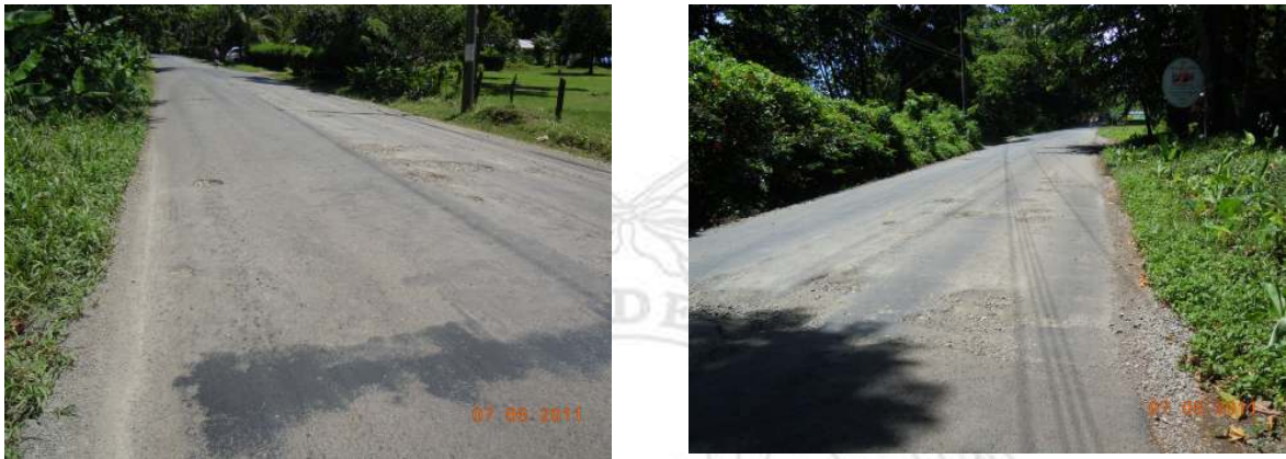
Figura 16. Estación 8+100: huecos exudación, agregado expuesto. (Fecha de fotografías 7-jun-2011) (Fuente: Pitra-LanammeUCR)
