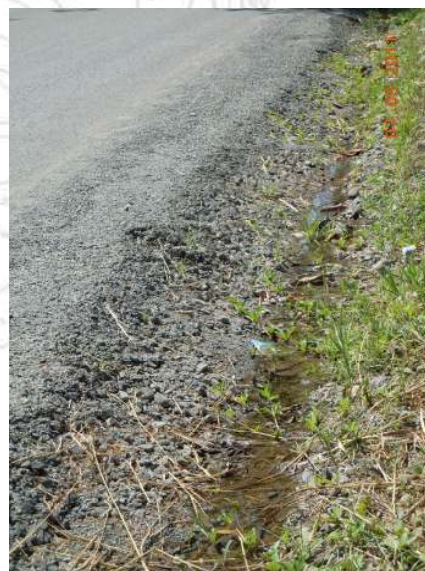
Figura 22. Estación 2+600: cuenta inadecuada y pérdida de borde de calzada Estación 4+400: cuneta inadecuada con agua empozada.
