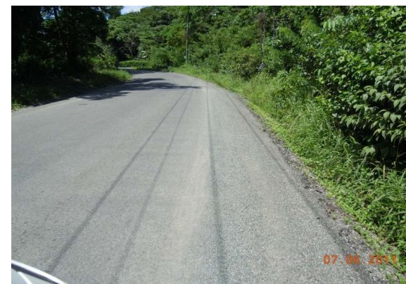
N°45 Estación 8+300, hacia Manzanillo. Superficie con tratamiento superficial. Material de secado para el tratamiento superficial Cuneta inadecuada.
