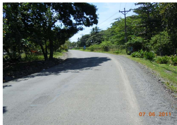
N°35 Estación 4+400 a 5+100, hacia Manzanillo. Superficie con tratamiento superficial. Exudación en el centro de calzada, agregado expuesto Material de secado para el tratamiento superficial
