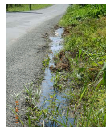
N°18 Estación 2+200, hacia Manzanillo. Superficie con tratamiento superficial. Cuneta inadecuada_agua empozada.
