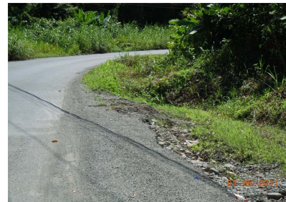
N°21 Estación 2+600, hacia Manzanillo. Superficie con tratamiento superficial. Borde dañado y cuneta inadecuada
