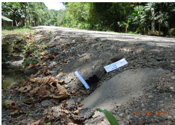
N°85 Estación 17+200, hacia Manzanillo. Superficie con lastre. Borde izquierdo: Material de escombros en cunetas Material de base redondeado
