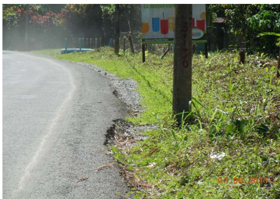
N°25 Estación 3+800, hacia Manzanillo. Termina tratamiento superficial e inicia capa asfáltica delgada. Borde dañado, sin cunetas
