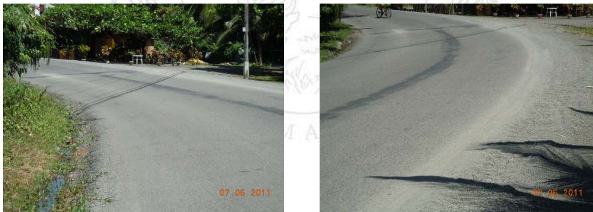
Figura 15. Estación 4+400 al 5+100: exudación y material de secado. (Fecha de fotografías 7-jun-2011) (Fuente: Pitra-LanammeUCR)
