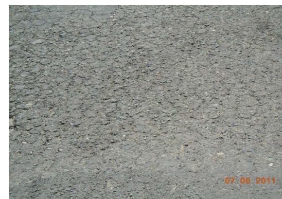
N°27 Estación 3+800, hacia Manzanillo. Superficie con capa asfáltica delgada. Grietas_cuero de lagarto
