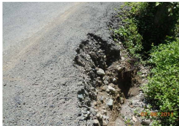
N°14 Estación 2+200, hacia Manzanillo. Superficie con tratamiento superficial. Exudación y agregado expuesto Borde dañado y sin cunetas
