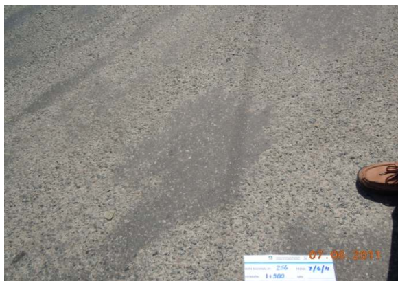
N°7 Estación 1+900, hacia Manzanillo. Superficie con tratamiento superficial. Exudación y agregado expuesto.
