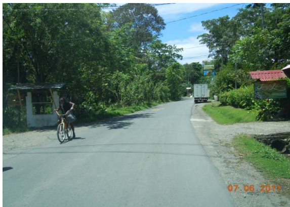
N°65 Estación 11+200, hacia Manzanillo. Superficie con capa asfáltica delgada. Grieta longitudinal
