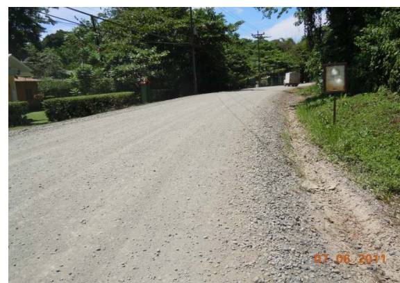
N°59 Estación 10+100 a 10+400, hacia Manzanillo. Termina superficie con tratamiento superficial e inicia lastre. Desprendimiento de agregado. Cunetas inadecuadas.
