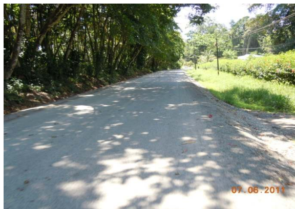
N°50 Estación 9+550, hacia Manzanillo. Superficie con tratamiento superficial. Material de secado para el tratamiento superficial
