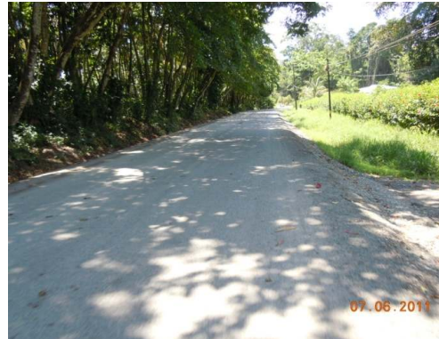
N°2 Estación 9+550, hacia Manzanillo. Pendiente transversal de calzada donde el agua escurre hacia un lado
