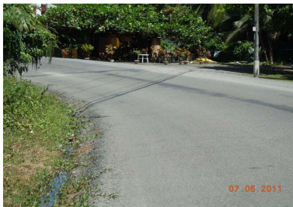
N°31 Estación 4+400 a 5+100, hacia Manzanillo. Termina capa asfáltica delgada e inicia tratamiento superficial. Exudación en el centro de calzada. Cuneta inadecuada_agua empozada.
