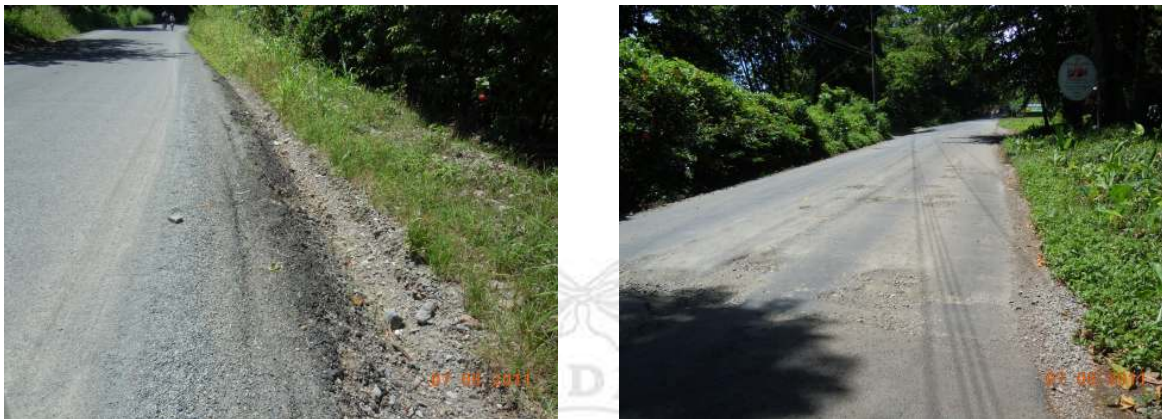
Figura 23. Estación 6+650: cuenta inadecuada Estación 8+100: invasión de vegetación en la cuneta. (Fecha de fotografías 7-jun-2011) (Fuente: Pitra-LanammeUCR)
