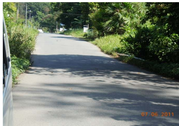
N°5 Estación 1+300, hacia Manzanillo. Puente sin barandas, ni sistema de contención vial en los accesos. Sin señalización preventiva de puente angosto.
