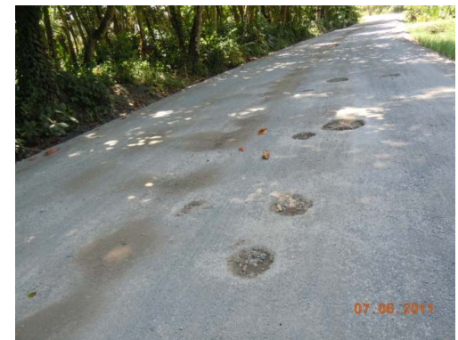
N°5 Estación 9+650, hacia Manzanillo. Huecos en el centro y en el carril derecho
