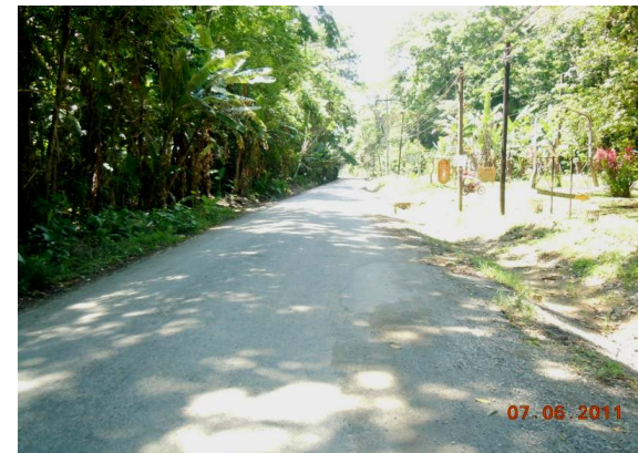
N°63 Estación 10+500 a 11+100, hacia Manzanillo. Termina capa asfáltica delgada e inicia lastre Exudación y agregado expuesto
