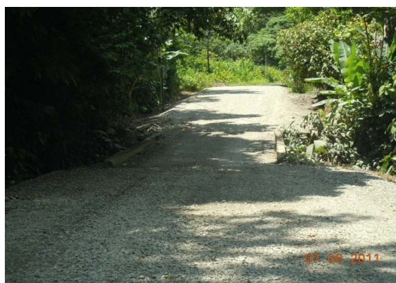
N°82 Estación 16+500, hacia Hone Creek. Superficie con lastre. Puente sin barandas, ni sistema de contención vial en los accesos Sin señalización preventiva de puente angosto
