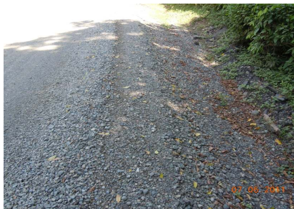
N°56 Estación 9+800, hacia Manzanillo. Superficie con lastre con desprendimiento de agregado
