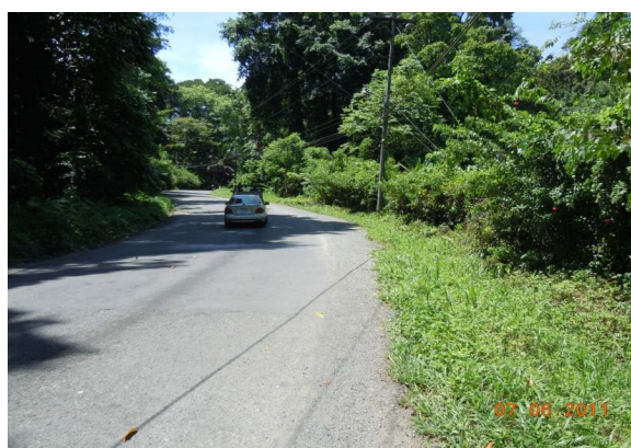
N°41 Estación 7+300, hacia Manzanillo. Inicia otro tipo de tratamiento superficial Cuneta inadecuada Invasión de vegetación
