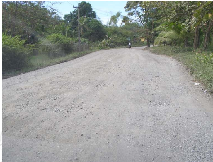
Figura 7. Pavimento de lastre, material desgastado, no existen cunetas. Estacionamiento 13+300, sentido Manzanillo-Hone Creek (Fecha de fotografía 20-ene-2011) (Fuente: Pitra-LanammeUCR)
