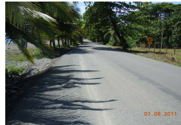
N°33 Estación 4+400 a 5+100, hacia Manzanillo. Superficie con tratamiento superficial. Exudación en el centro de calzada. Material de secado para el tratamiento superficial.
