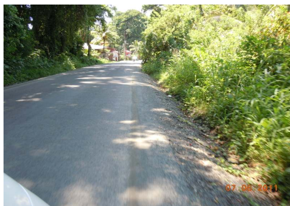
N°40 Estación 6+900, hacia Manzanillo. Superficie con tratamiento superficial. Material de secado para el tratamiento superficial Cuneta inadecuada
