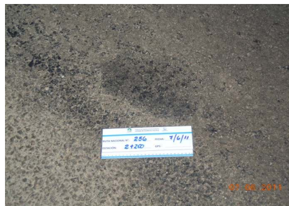
N°17 Estación 2+200, hacia Manzanillo. Superficie con tratamiento superficial. Exudación y agregado expuesto.
