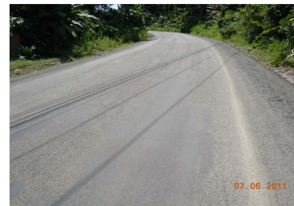
N°12 Estación 2+000, hacia Manzanillo. Superficie con tratamiento superficial. Material de secado en el borde de calzada. Exudación y agregado expuesto
