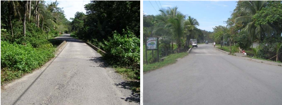
Figura 8. Puentes angostos, sin barandas ni barreras protectoras. (Fecha de fotografía 20-ene-2011) (Fuente: Pitra-LanammeUCR)
