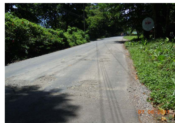
N°42 Estación 8+100, hacia Manzanillo. Superficie con tratamiento superficial. Huecos en el centro y en el carril derecho.
