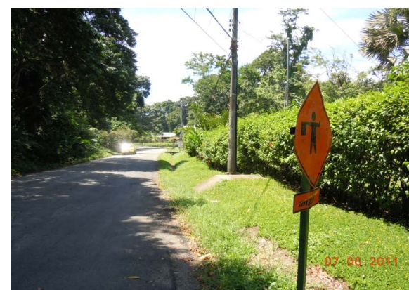
N°48 Estación 9+400, hacia Manzanillo. Superficie con tratamiento superficial. Señal temporal de protección de obra mal colocada Cuneta inadecuada.
