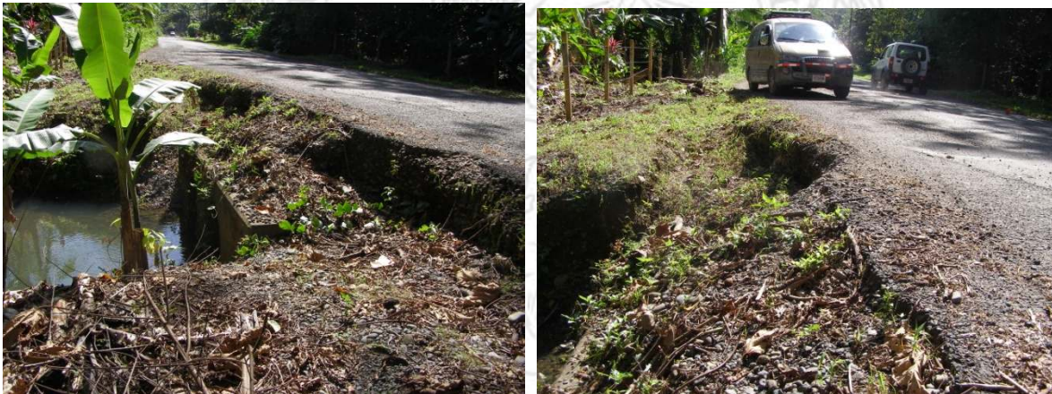
Figura 4. Alcantarilla, sin señalización ni barreras protectoras.
