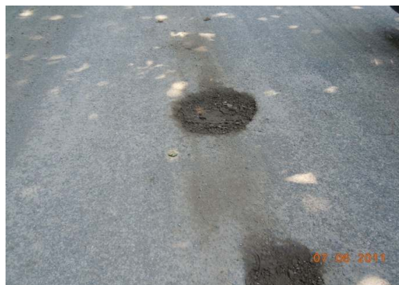
N°53 Estación 9+650, hacia Manzanillo. Superficie con tratamiento superficial. Huecos y agregado expuesto.
