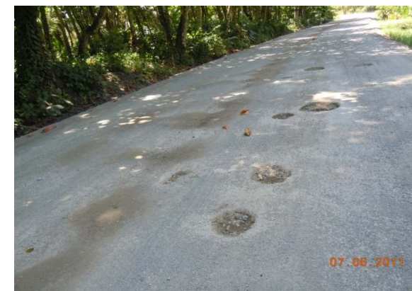
N°54 Estación 9+650, hacia Manzanillo. Superficie con tratamiento superficial. Huecos y agregado expuesto.
