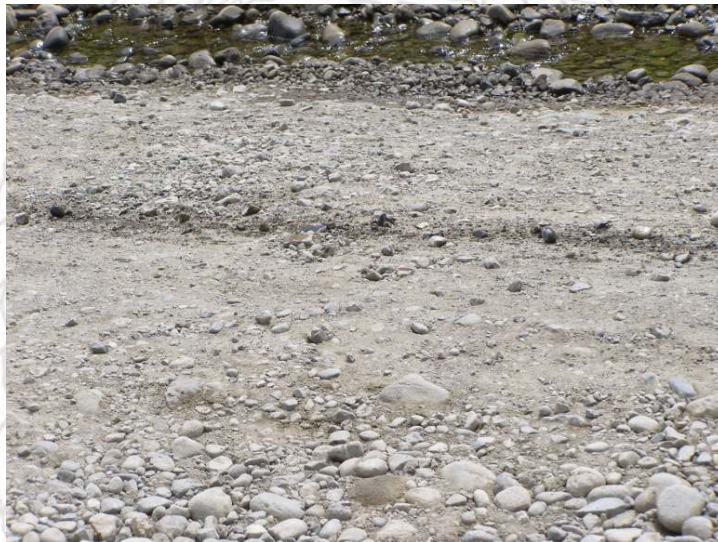
Figura 6. Base construida con material redondeado, material segregado. Estacionamiento 2+300, sentido Manzanillo-Hone Creek (Fecha de fotografía 20-ene-2011) (Fuente: Pitra-LanammeUCR)
