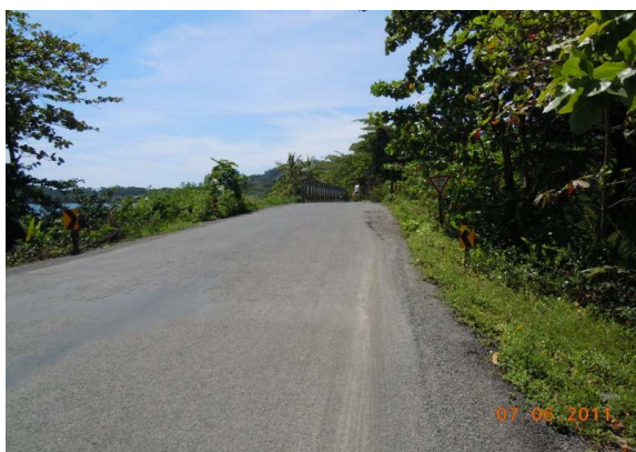
N°34 Estación 4+400 a 5+100, hacia Manzanillo. Superficie con tratamiento superficial. Exudación en el centro de calzada, borde dañado Material de secado para el tratamiento superficial
