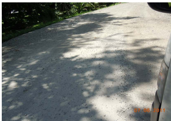
N°74 Estación 13+900, hacia Manzanillo. Termina superficie con capa asfáltica delgada e inicia lastre
