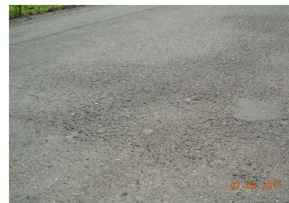
N°24 Estación 3+300, hacia Manzanillo. Superficie con tratamiento superficial. Exudación y agregado expuesto Grietas_cuero de lagarto
