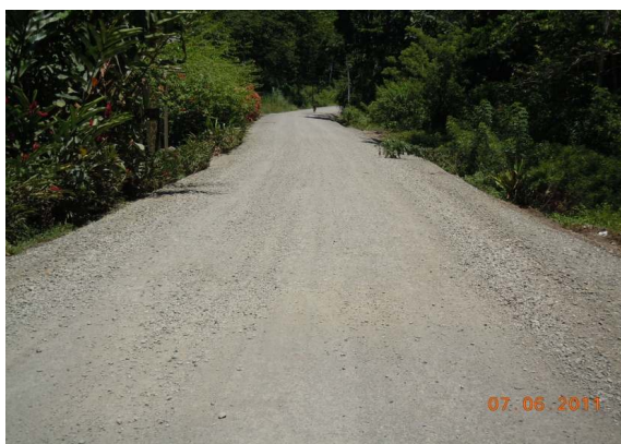
N°70 Estación 13+400, hacia Hone Creek. Superficie con lastre. Rodera y desprendimiento de agregado
