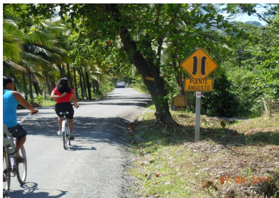
N°29 Estación 4+100 a 4+400, hacia Manzanillo. Superficie con capa asfáltica delgada. Señal de tránsito sucia
