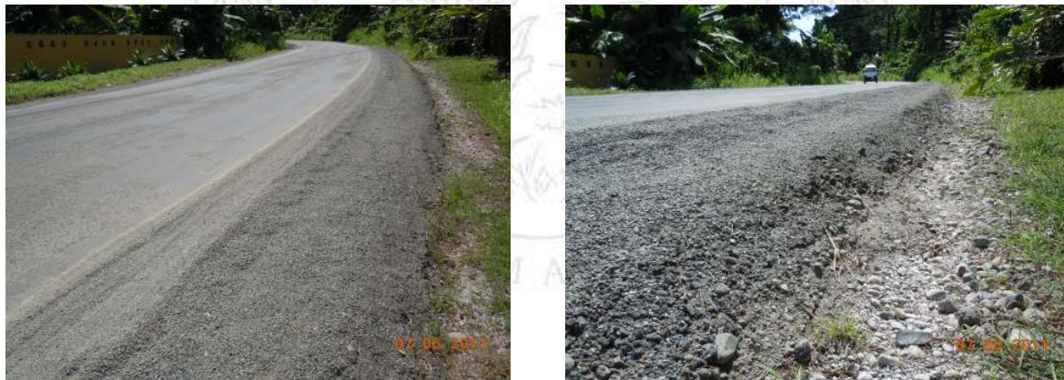
Figura 11. Estación 2+000: material de secado de tratamiento superficial en bordes de calzada. Exudación y agregado expuesto. (Fecha de fotografías 7-jun-2011) (Fuente: Pitra-LanammeUCR)
