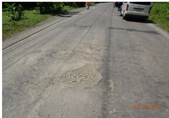
N°44 Estación 8+100, hacia Manzanillo. Superficie con tratamiento superficial. Huecos en ambos carriles y exudación Cuneta inadecuada.
