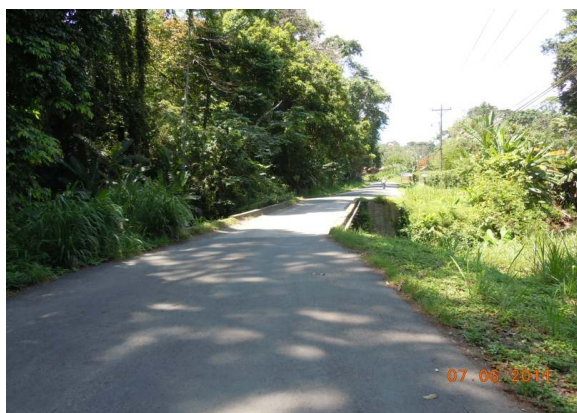
N°46 Estación 8+400, hacia Manzanillo. Superficie con tratamiento superficial. Puente sin barandas, ni sistema de contención vial en los accesos Sin señalización preventiva de puente angosto
