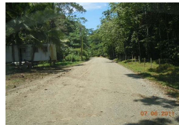
N°81 Estación 16+400, hacia Manzanillo. Termina tratamiento superficial e inicia lastre. Huecos y desprendimiento de agregados.
