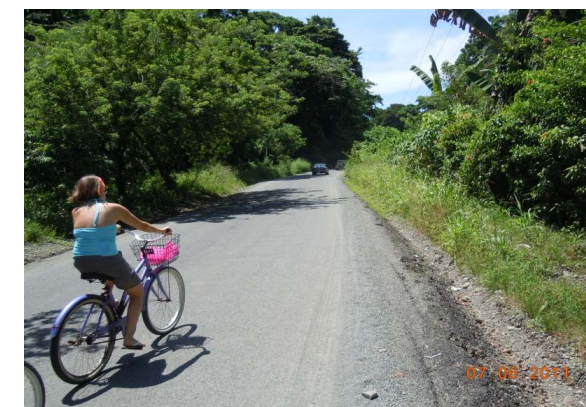
N°36 Estación 4+400 a 5+100, hacia Manzanillo. Superficie con tratamiento superficial. Material de secado para el tratamiento superficial
