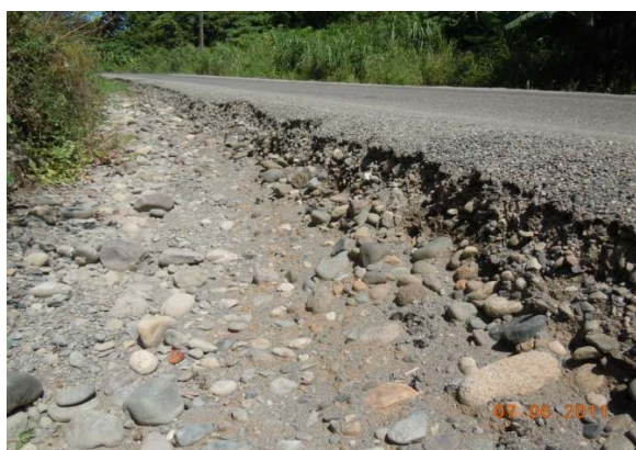
N°16 Estación 2+200, hacia Manzanillo. Superficie con tratamiento superficial. Borde dañado.
