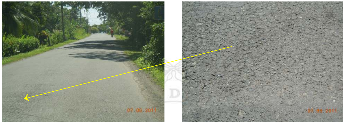
Figura 14. Estación 3+800: grietas-cuero de lagarto. (Fecha de fotografías 7-jun-2011) (Fuente: Pitra-LanammeUCR)
