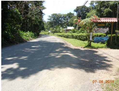
N°1 Estación 9+500, hacia Manzanillo. Pendiente transversal de calzada donde el agua escurre hacia un lado
