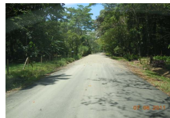
N°84 Estación 17+000, hacia Manzanillo. Termina superficie con capa asfáltica delgada e inicia lastre. Cunetas con definición inadecuada.
