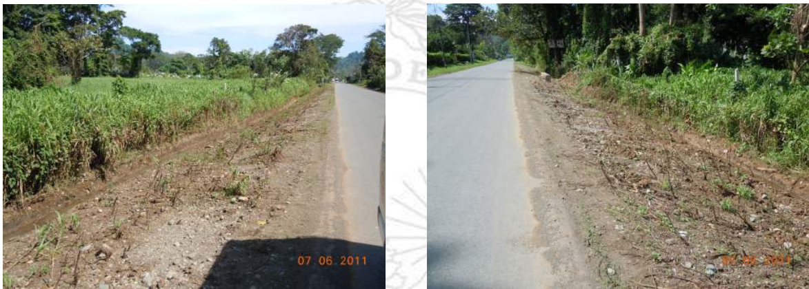
Figura 19. Estación 0+300: material suelto en la pared de la cuneta que puede ser arrastrado por las lluvias y obstruir las cunetas.
