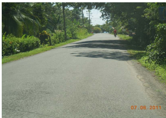
N°26 Estación 3+800, hacia Manzanillo. Superficie con capa asfáltica delgada. Grietas_cuero de lagarto Sin cunetas
