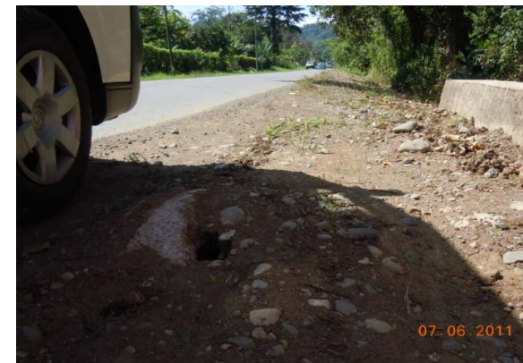
N°3 Estación 0+300, hacia Manzanillo. Alcantarilla con espesor de corona inadecuado.
