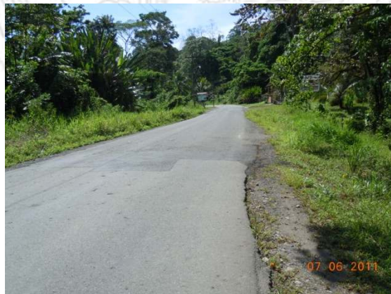
Figura 20. Estación 1+300: ausencia de cunetas.
