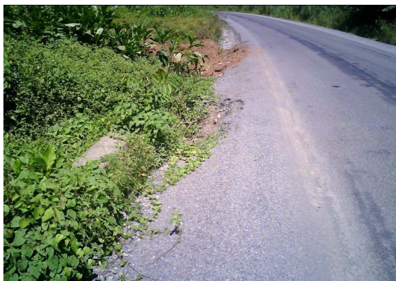
N°13 Estación 2+200, hacia Manzanillo. Superficie con tratamiento superficial. Exudación y agregado expuesto Borde dañado, sin cunetas, socavación de alcantarilla
