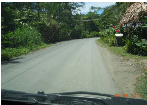
N°64 Estación 11+100, hacia Manzanillo. Termina superficie en lastre e inicia capa asfáltica delgada. Sin cunetas.
