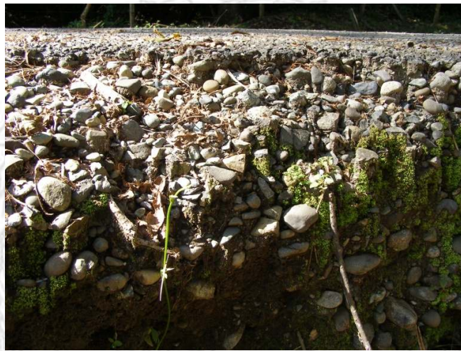
Figura 5. Base construida con material redondeado. (Estacionamiento 16+600, sentido Manzanillo-Hone Creek) (Fecha de fotografía 20-ene-201) (Fuente: Pitra-LanammeUCR)
