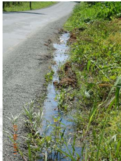
Figura 21. Estación 2+000: pérdida de borde de calzada por socavación y cuneta inadecuada con agua empozada.
