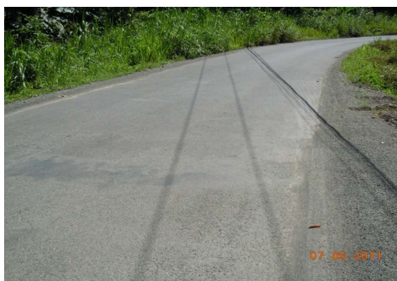
N°22 Estación 3+000, hacia Manzanillo. Inicia otro tratamiento superficial. Exudación y agregado expuesto Junta transversal inadecuada
