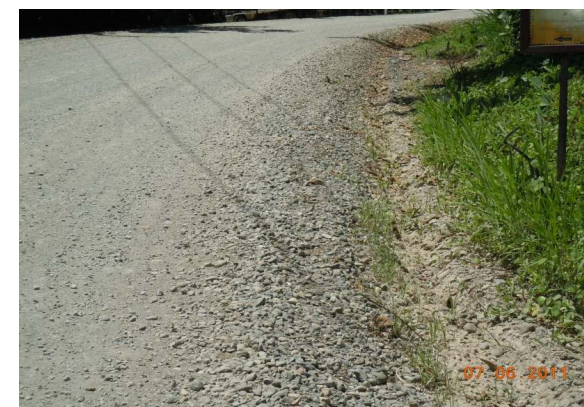
N°60 Estación 10+100 a 10+400, hacia Hone Creek. Superficie con lastre, Desprendimiento de agregado. Cunetas inadecuadas.
