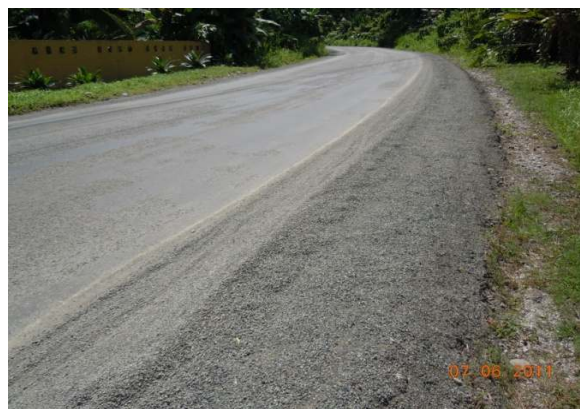
N°10 Estación 2+000, hacia Manzanillo. Inicia otro tratamiento superficial. Material de secado en el borde de calzada. Exudación y agregado expuesto
