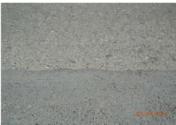
N°28 Estación 4+100 a 4+400, hacia Manzanillo. Superficie con capa asfáltica delgada. Exudación en el centro de calzada
