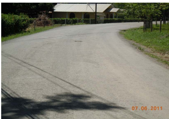
N°58 Estación 10+000 a 10+100, hacia Manzanillo. Termina superficie con lastre e inicia tratamiento superficial. Huecos en el centro de calzada y agregado expuesto.
