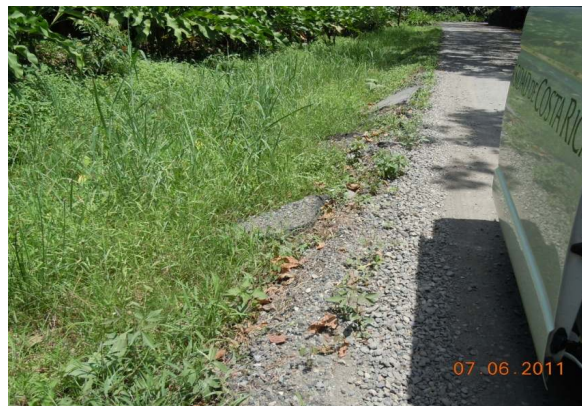
N°86 Estación 17+200, hacia Manzanillo. Superficie con lastre. Borde derecho: Material de escombros en cunetas Material de base redondeado
