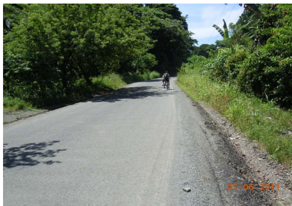
N°37 Estación 6+650, hacia Manzanillo. Superficie con tratamiento superficial. Material de secado para el tratamiento superficial Cuneta inadecuada
