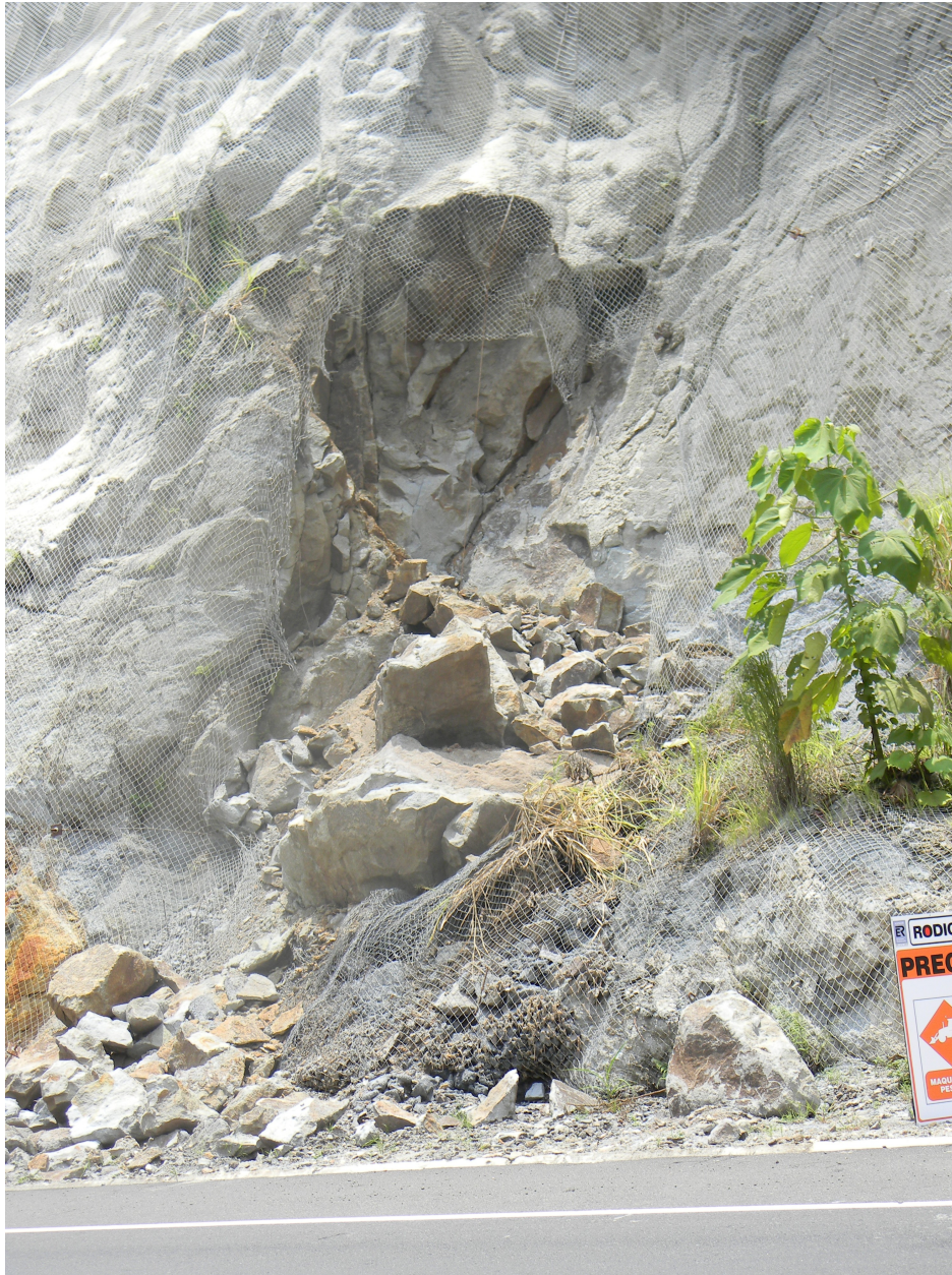
Figura 21: Falla en el sistema de revestimiento, est. 46+050.
