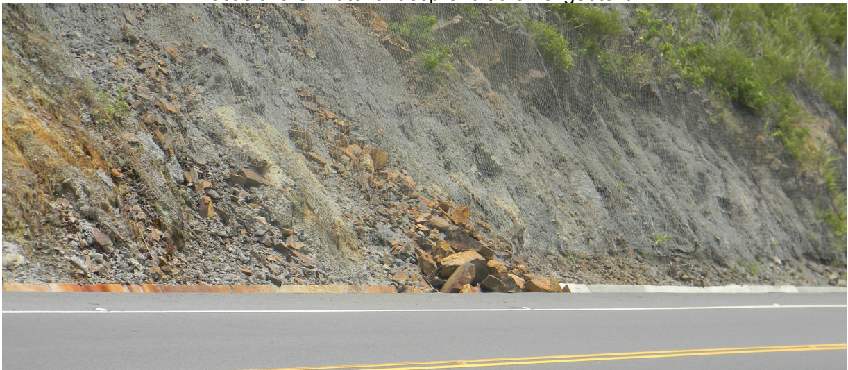
Figura 18: Caída de material, talud est. 44+800.
