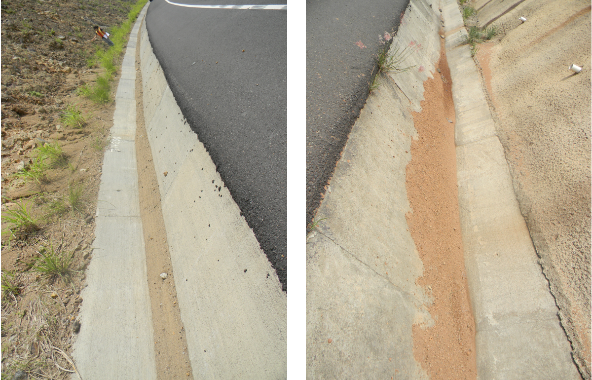
Figura 29: estado de las cunetas, est. 37+200 y 41+000. Fuente: LanammeUCR, setiembre 2011.
