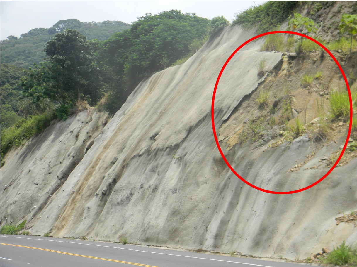
Figura 16: talud, est. 43+740. En el círculo rojo se señalan los desprendimientos en la cubierta de concreto.
