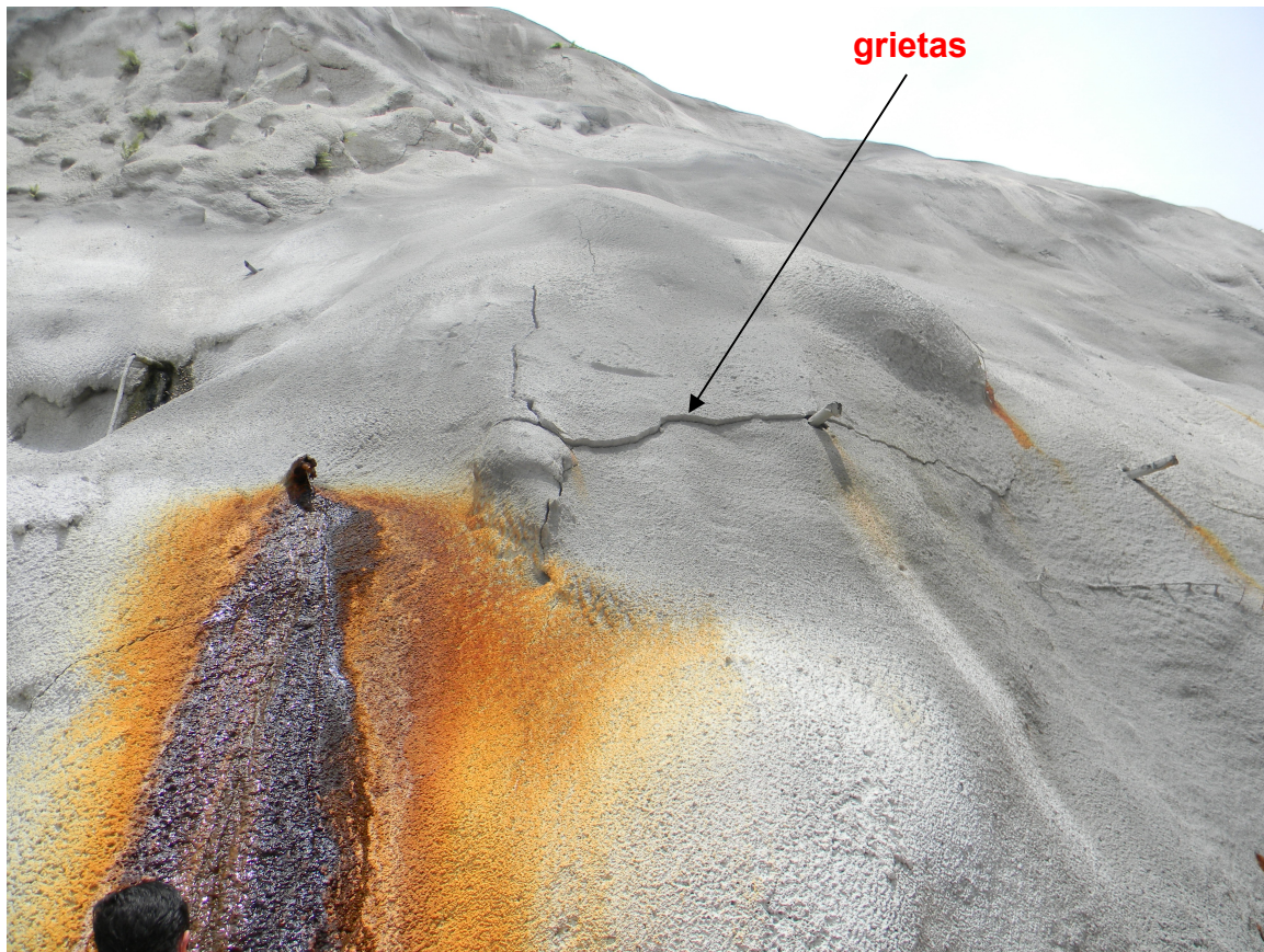
Figura 20: Grietas y daños por humedad, est. 45+220. La mancha q se observa a la izquierda, es debido a la gran cantidad de minerales que posee el agua que emana desde el interior del talud, la cual al no ser canalizada correctamente entra en contacto con el concreto, alterándolo en el proceso.
