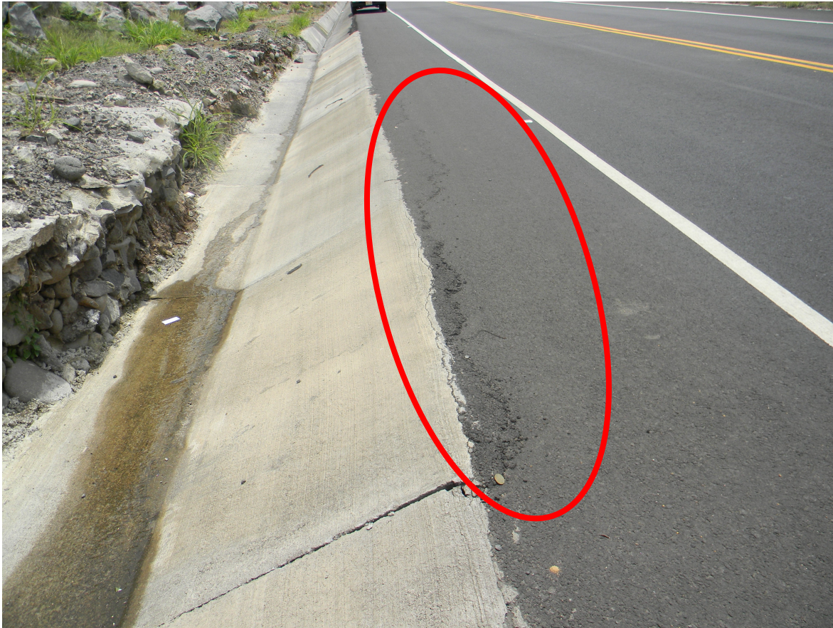
Figura 10: Deformación en el pavimento, est. 36+350.
