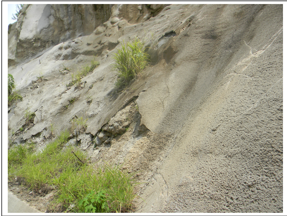
Figura 7: Estado de la cubierta de concreto lanzado, est. 36+000.
