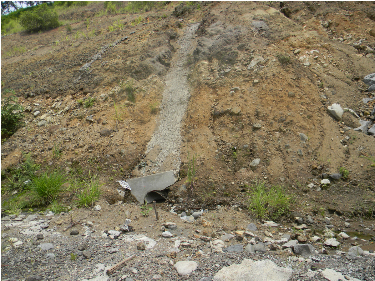
Figura 9: Daños al pie del drenaje, est. 36+350.
