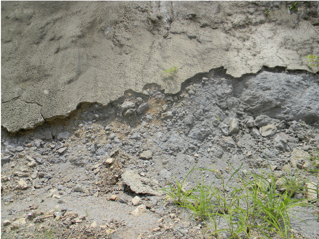
Figura 22: Desprendimientos en la base del talud, est. 46+050.
