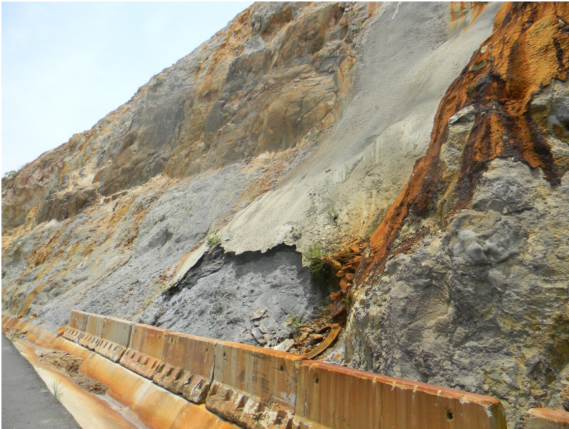
Figura 19: Daños en taludes, est. 45+220.
