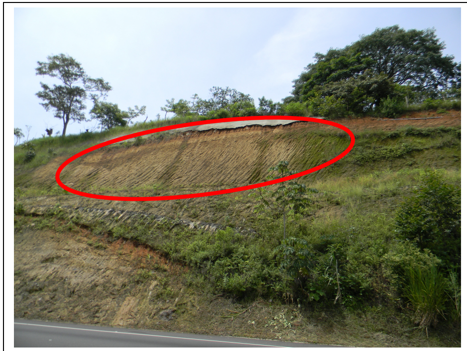
Figura 4: Restos de concreto lanzado, talud derecho, est. 28+400.
