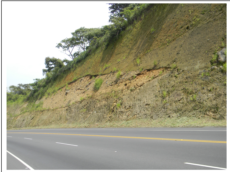
Figura 3: Talud derecho, est. 28+400.
