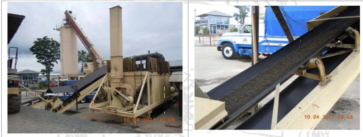
Fotografía 3 Fajas de transporte de agregados y casa de finos.
