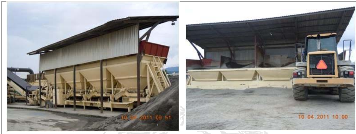
Fotografía 2 Tolvas de dosificación de agregados, con estructura de techos.
