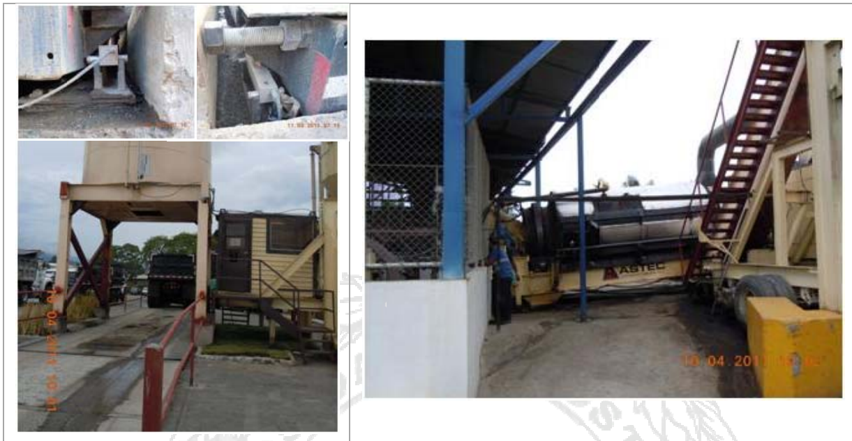
Fotografía 5 Plataforma de pesaje. Tambor doble barril (secador y mezclador).
