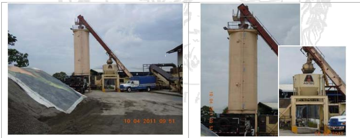
Fotografía 1 Silos de almacenaje de mezcla asfáltica producida (principal y auxiliar)
