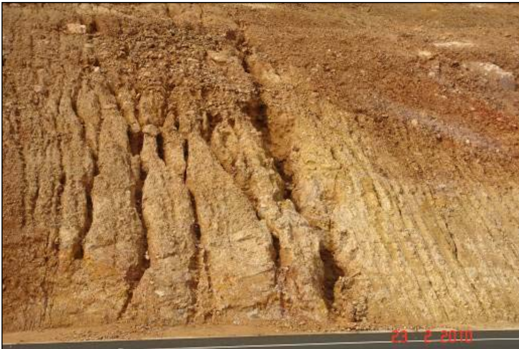
Fotografía 2. Formación de surcos en talud afectado por escurrimiento superficial en Estacionamiento 48+250. Condiciones al 23 de febrero de 2010. (LanammeUCR, 2010).
