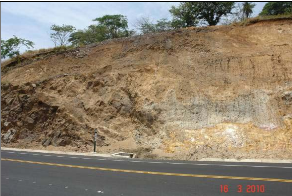
Fotografía 8. Talud en Estacionamiento 47+100. Condiciones al 16 de marzo de 2010. (LanammeUCR, 2010).
