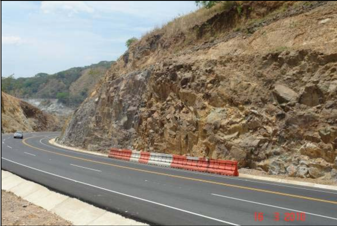
Fotografía 9. Talud con malla y protecciones contra caídos y desprendimientos en Estacionamiento 47+200. Condiciones al 16 de marzo de 2010. (LanammeUCR, 2010).
