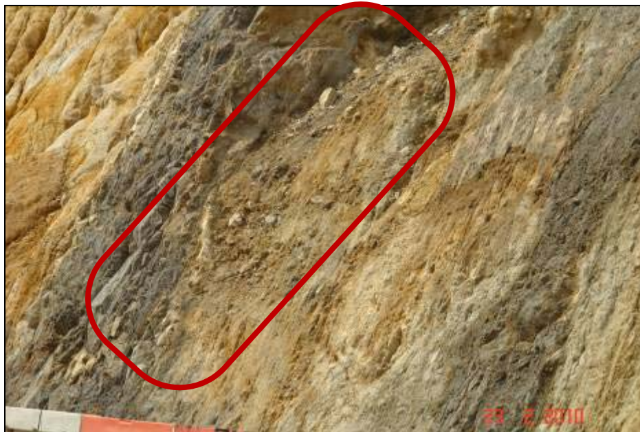
Fotografía 1. Presencia de bloques sueltos en cara de talud en Estacionamiento 47+700. Condiciones al 23 de febrero de 2010. (LanammeUCR, 2010).
