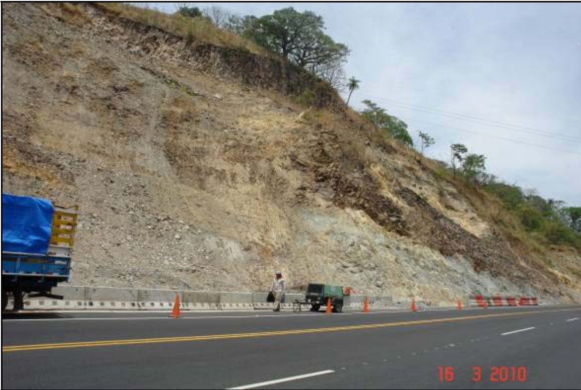
Fotografía 4. Talud afectado en Estacionamiento 45+500. Condiciones al 16 de marzo de 2010. (LanammeUCR, 2010).
