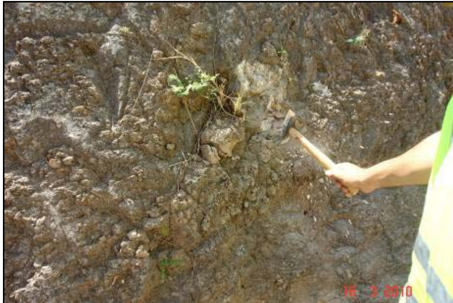
Fotografía 23. Roca meteorizada en talud en Estacionamiento 51+150. Condiciones al 16 de marzo de 2010. (LanammeUCR, 2010).
