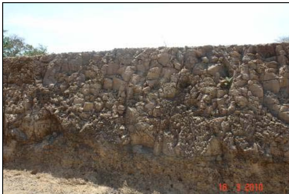
Fotografía 24. Roca meteorizada en talud en Estacionamiento 51+150. Condiciones al 16 de marzo de 2010. (LanammeUCR, 2010).
