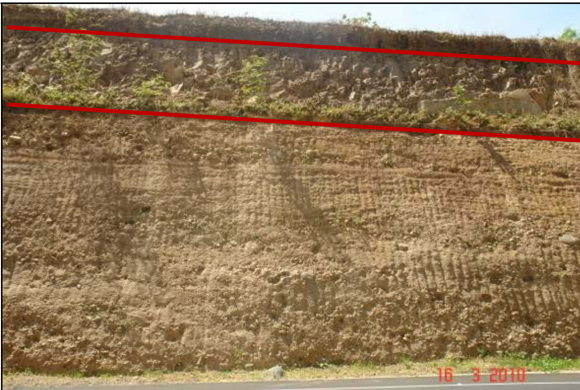
Fotografía 20. Talud en Estacionamiento 49+600. Condiciones al 16 de marzo de 2010. (LanammeUCR, 2010).
