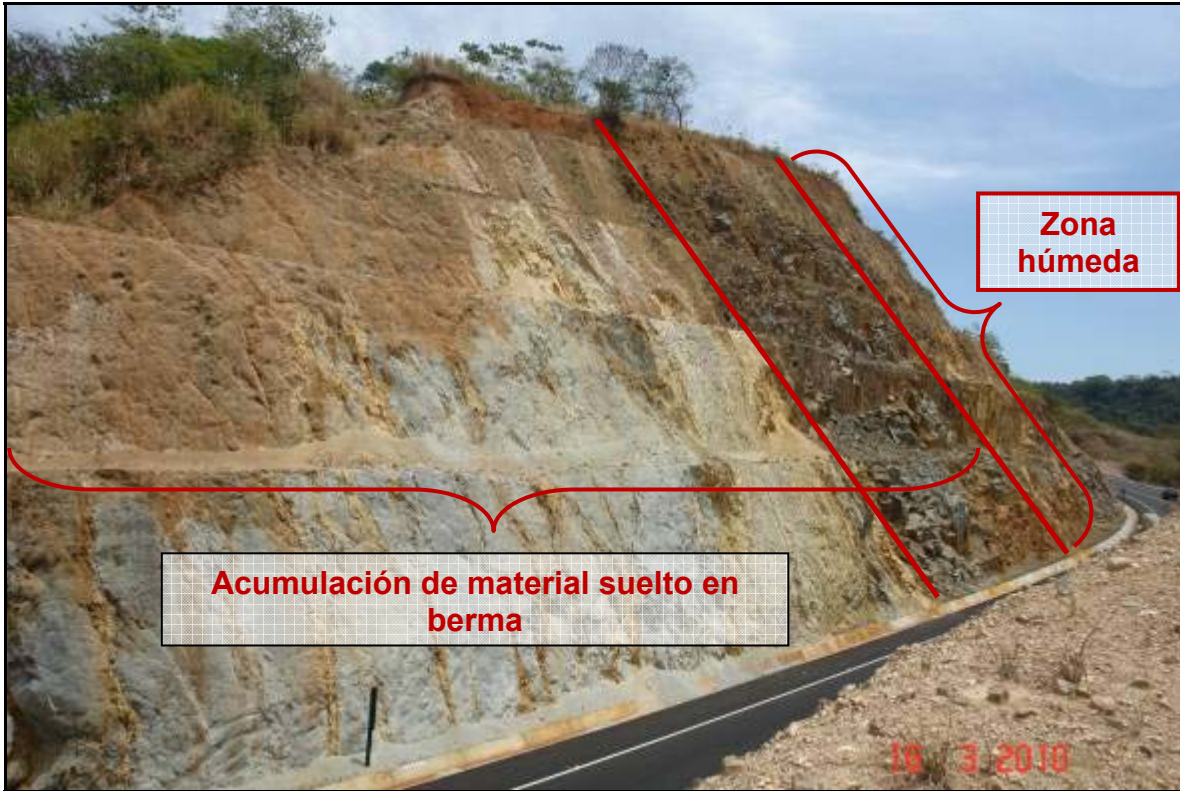
Fotografía 10. Talud en Estacionamiento 47+700. Condiciones al 16 de marzo de 2010. (LanammeUCR, 2010).
