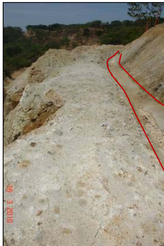
Fotografía 15. Canales de drenaje no impermeabilizados en Estacionamiento 48+550. Condiciones al 16 de marzo de 2010. (LanammeUCR, 2010).
