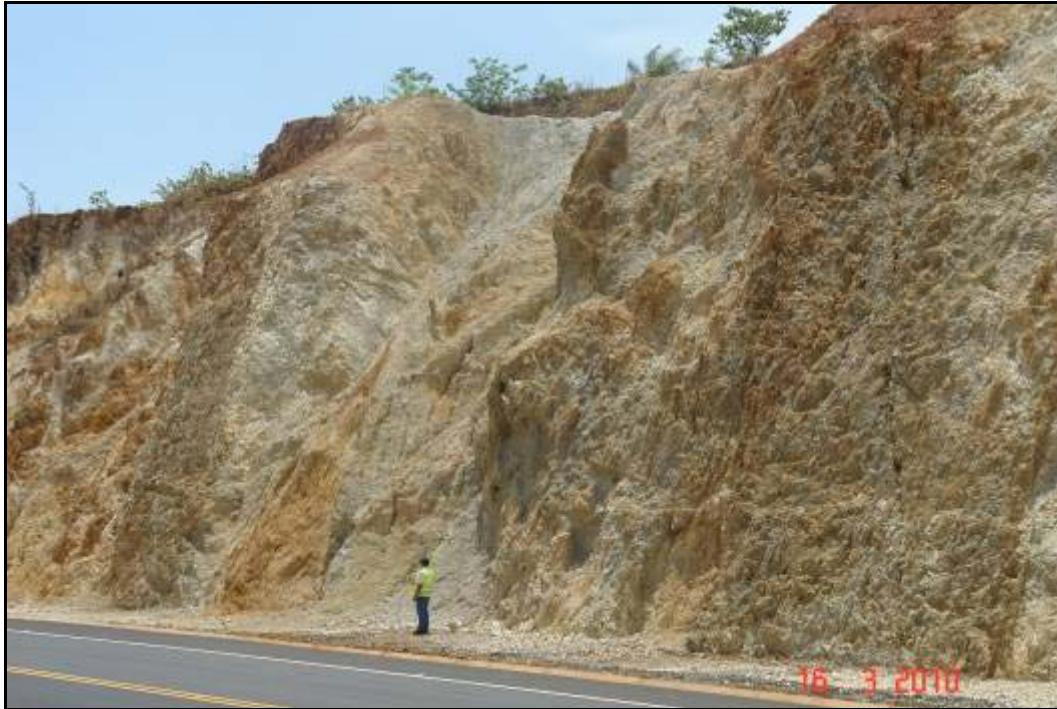
Fotografía16. Talud en Estacionamiento 49+100. Condiciones al 16 de marzo de 2010. (LanammeUCR, 2010).
