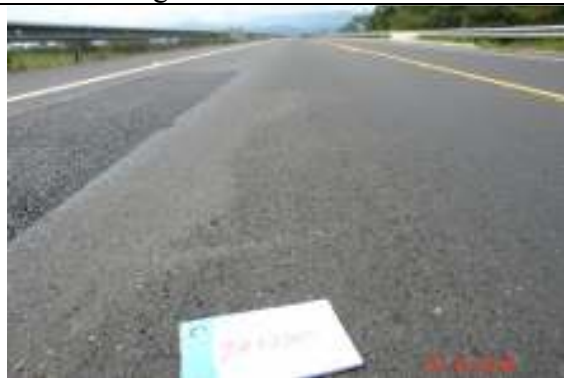
Fotografía N. 17b Desprendimiento Est. 24+350
