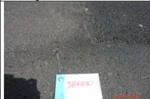
Fotografía N. 17a Desprendimiento Est. 38+850
