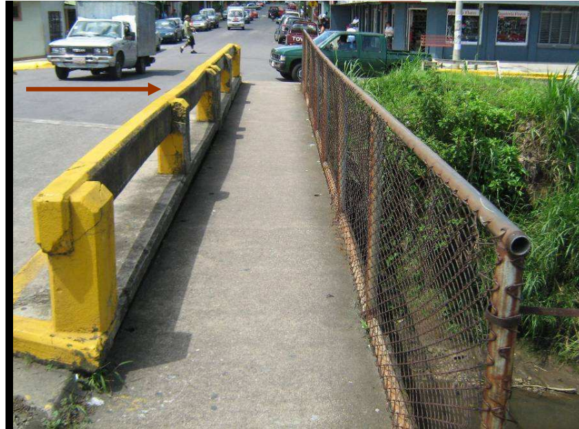
Figura 6. Deformación en la baranda.
