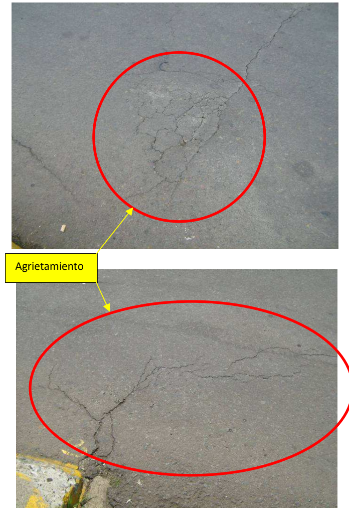
Figura 8. Agrietamiento en la carpeta asfáltica, entre el acceso Sur y el puente, causado por movimientos diferenciales.
