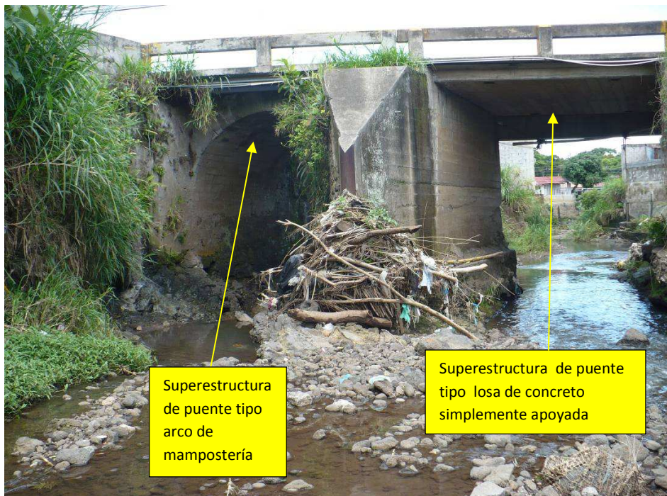
Figura 5. Vista lateral hacia el Oeste. Puente consta de dos superestructuras: una tipo arco de mampostería y otra tipo losa de concreto.
