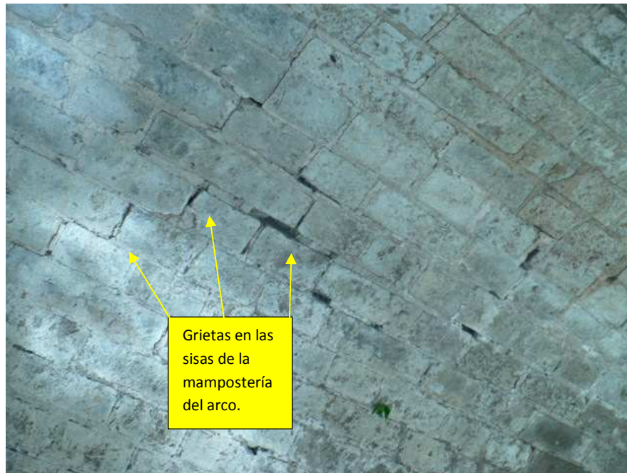
Figura 14. Grietas en las sisas de la mampostería.
