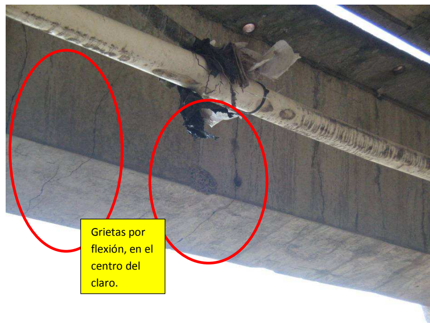
Figura 15. Grietas por flexión en el centro del claro de la viga del puente peatonal.
