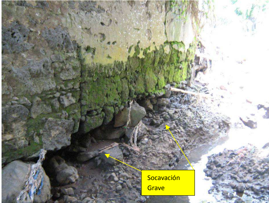
Figura 18. Socavación grave bajo la pila central.
