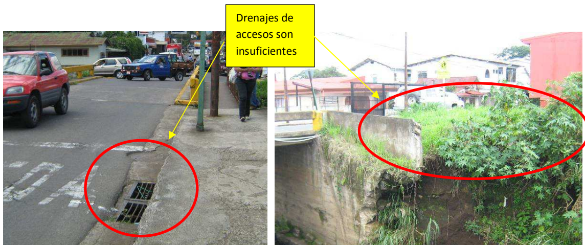
Figura 10. Drenajes de accesos son insuficientes o inexistentes.
