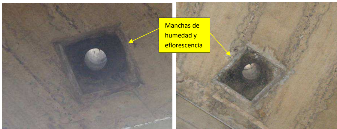
Figura 13. Manchas de humedad. Leve eflorescencia en orificios de drenaje.
