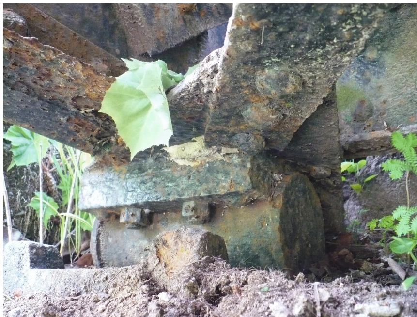
Foto No. 4. Apoyo tipo rodillo que se encuentra muy afectado por corrosión
