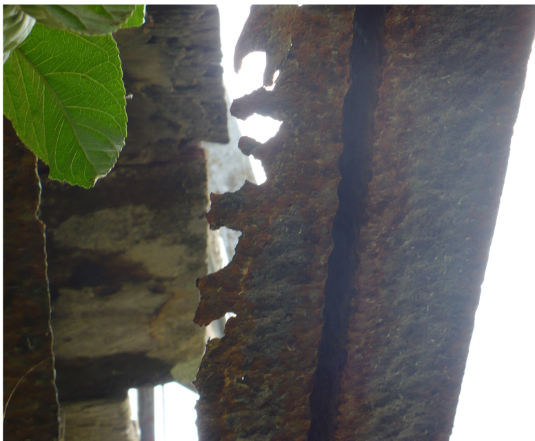
Foto No. 3. Cuerda inferior de la cercha severamente dañada por corrosión y pérdida de material
