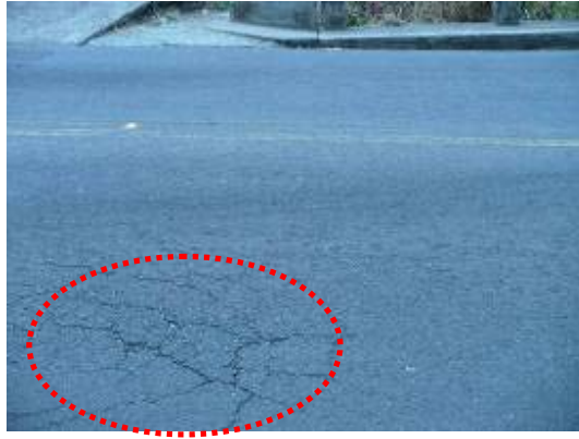
Figura 3. Grietas sobre la capa de rodamiento asfáltica.
