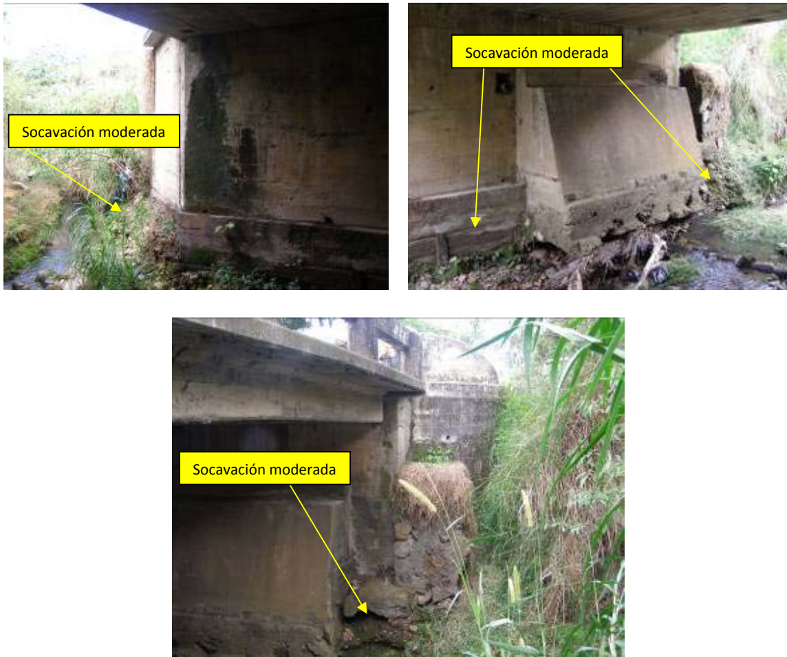
Figura 11. Socavación moderada en aletones, bastiones y fundaciones.
