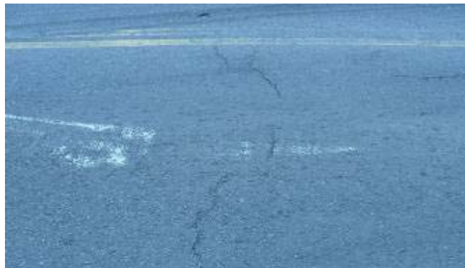
Figura 5. Grietas sobre el puente en el limite entre el apoyo de la losa y uno de los accesos.
