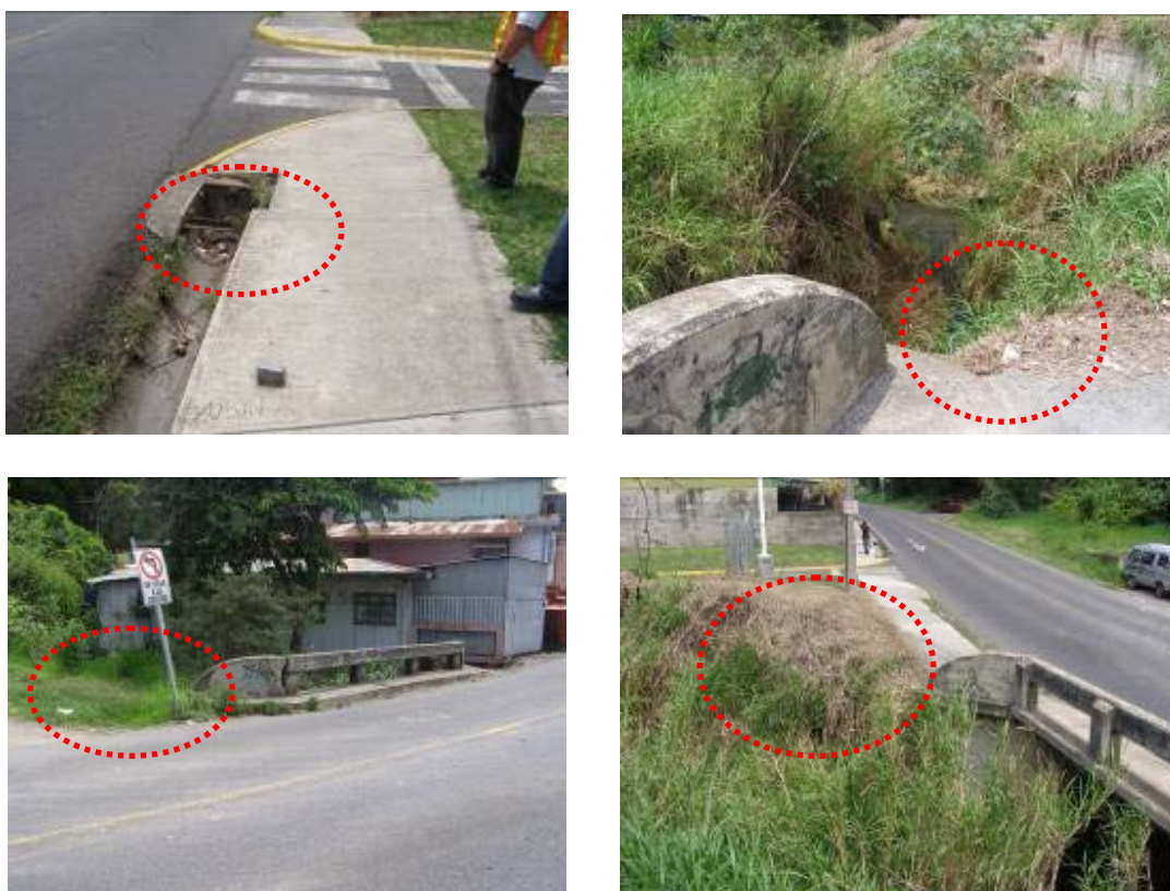
Figura 6. Alcantarillas obstruidas y drenajes inexistentes en los accesos al puente.
