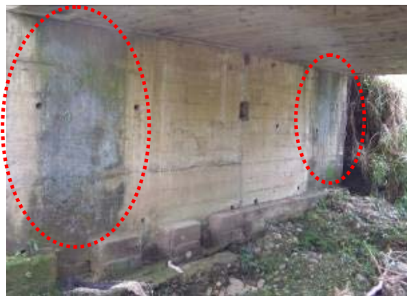
Figura 10. Humedad proveniente de drenajes defectuosos de la losa del puente.
