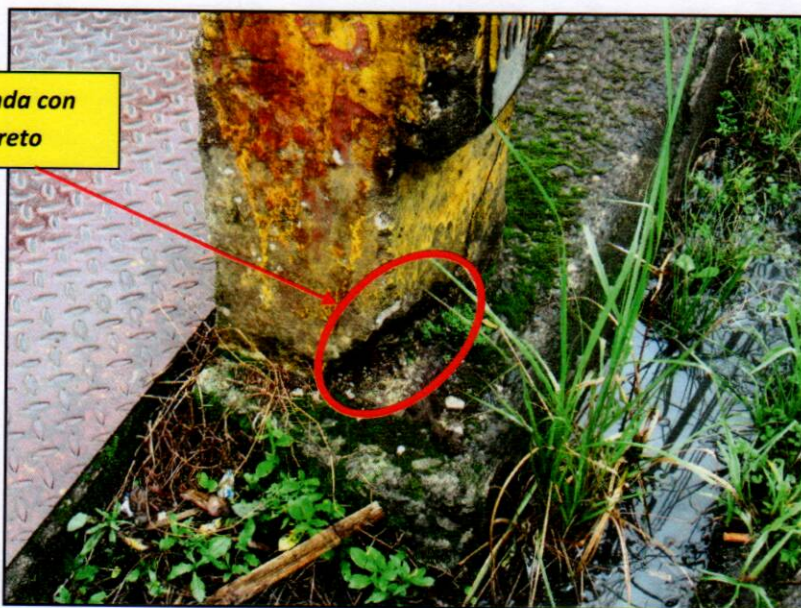
Fotografía 7. Falta de concreto en base de columna de baranda. (Estado del puente al 19 de mayo de 2010).
