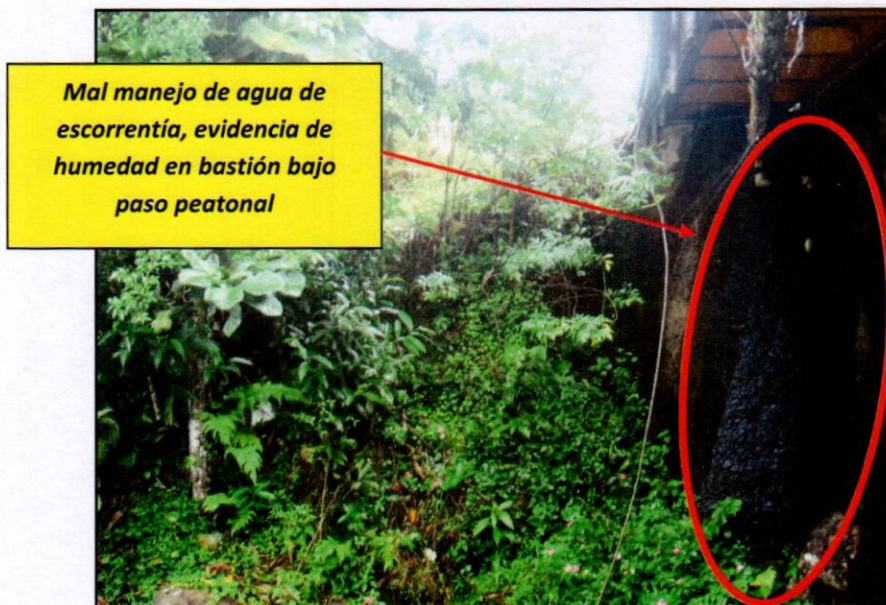
Fotografía 14. Evidencia de humedad en bastión bajo estructura de paso peatonal. (Estado del puente al 19 de mayo de 2010).
