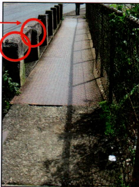
Fotografía 6. Falta de concreto en topes de columnas de baranda. (Estado del puente al 19 de agosto de 2010).
