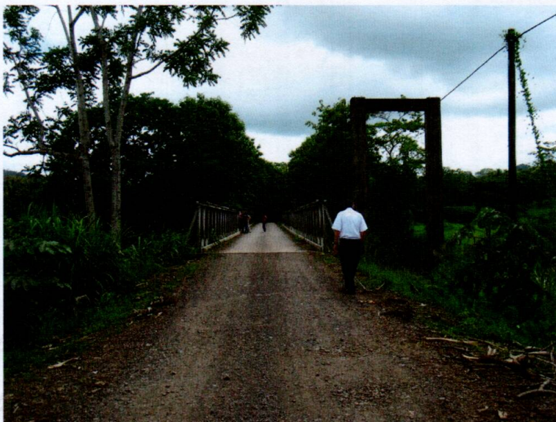
Figura 7. Los accesos al puente no cuentan con guardavías, delineadores verticales, etc.
