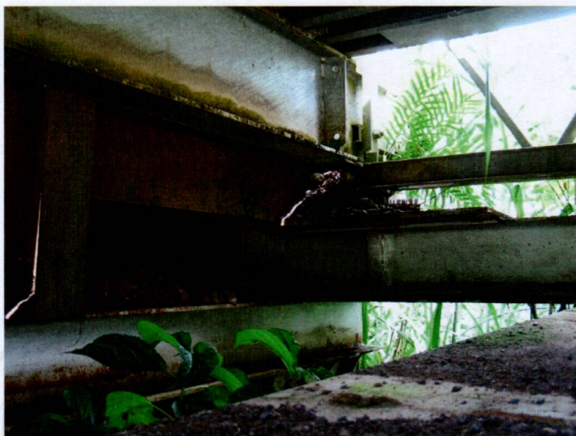
Figura 9. Sedimento acumulado alrededor de los apoyos de las cerchas.
