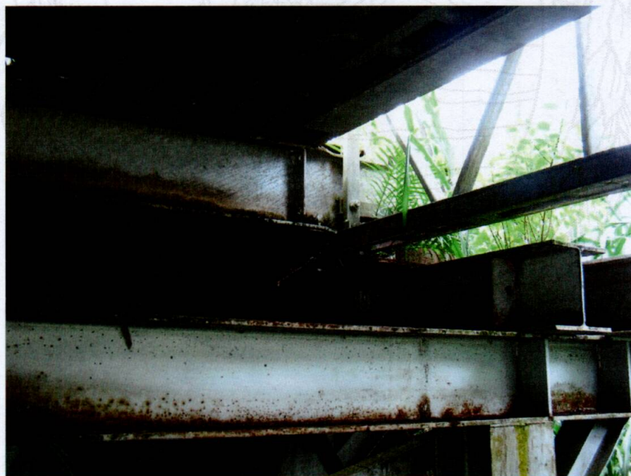
Figura 10. Oxidación y corrosión de los elementos que componen la estructura de acero del bastión-Sur.
