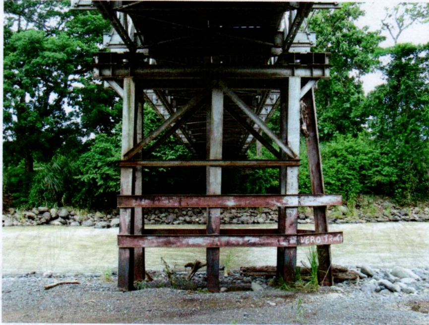
Figura 11. Oxidación y corrosión de los elementos que componen la estructura de acero de la pila.
