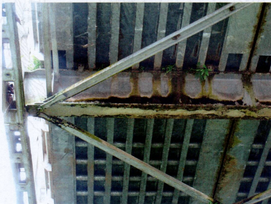
Figura 8. Vista típica de elementos de la superestructura los cuales exhiben manchas por falta de mantenimiento debido a su exposición al agua, sedimento y materia orgánica.
