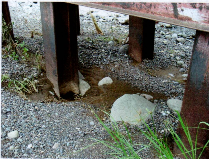
Figura 12. Nivel de erosión observado junto a los elementos columna/pilote.
