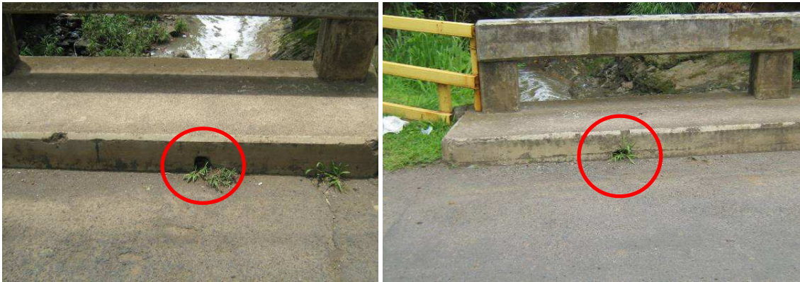
Figura 11. Drenajes de puente obstruidos con material vegetal y piedra suelta.
