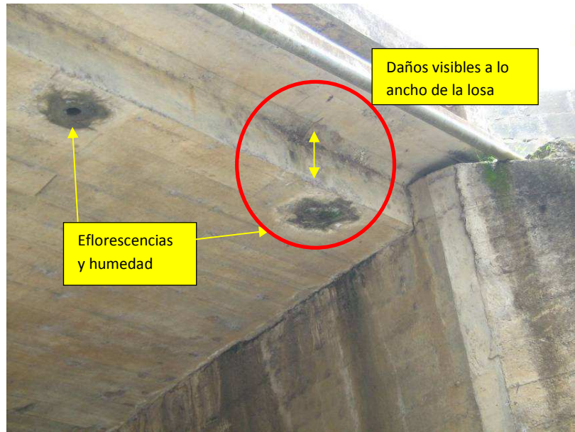
Figura 13. Concentración de humedad, eflorescencias a lo ancho de la losa.
