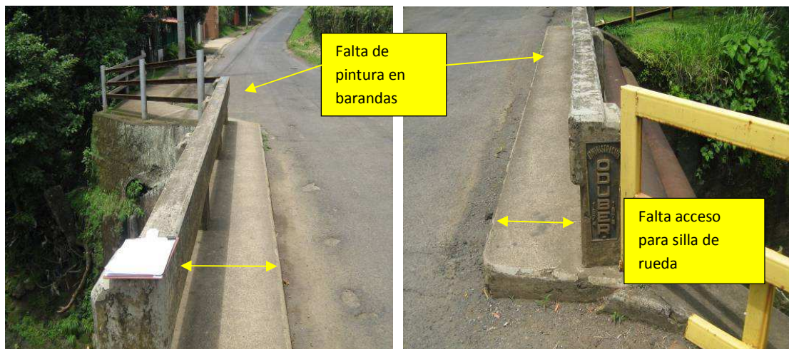
Figura 7. Barandas en buen estado, les falta pintura. Ancho insuficiente de la acera peatonal.
