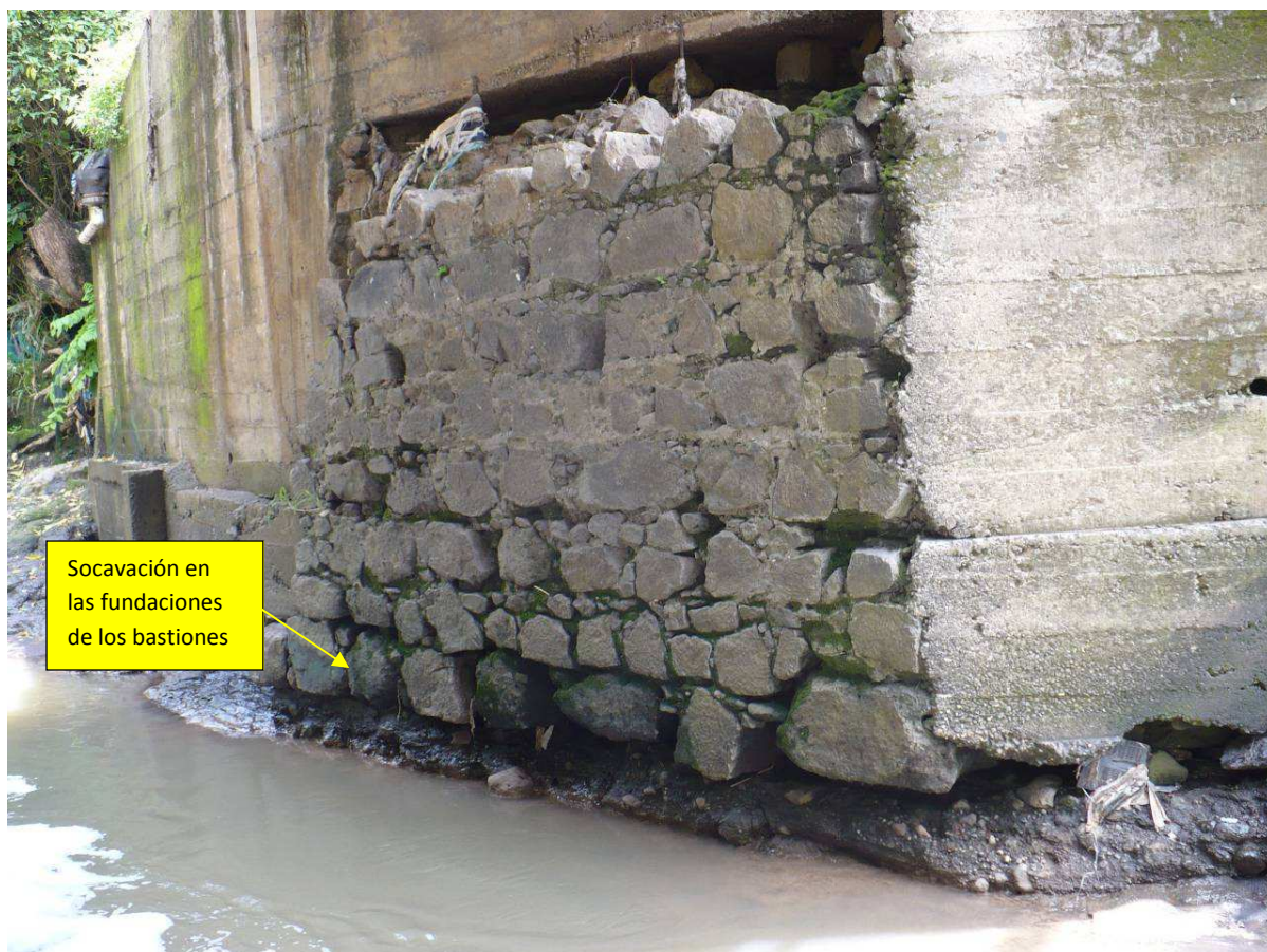
Figura 15. Socavación de las fundaciones de los bastiones, problema en ambos lados.
