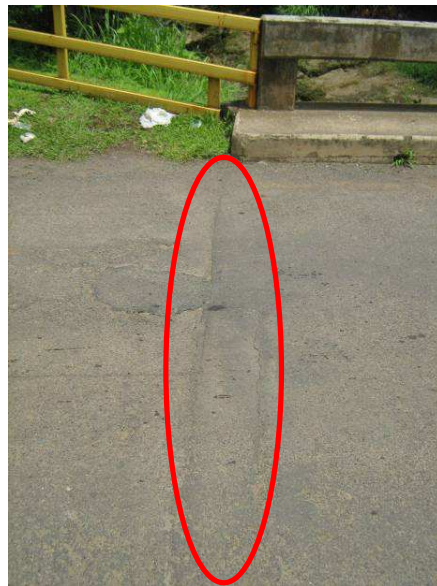
Figura 12. Junta de expansión obstruida por carpeta de mezcla asfáltica
