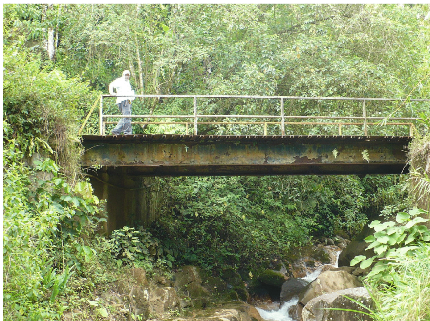
Figura 9. Se observa socavación leve en la base de los bastiones.
