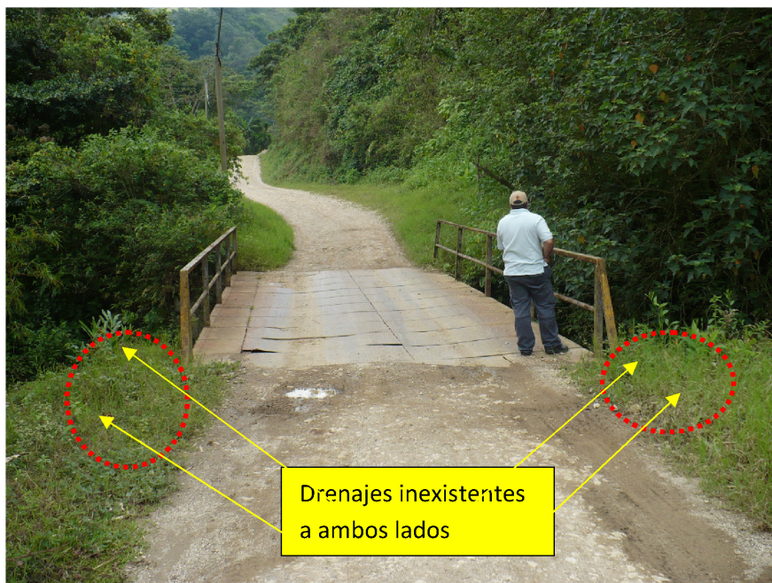
Figura 5. No existe un sistema de drenaje en los accesos.
