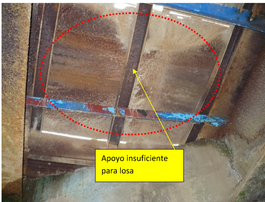
Figura 7. Falta de una estructura apropiada que sirva de apoyo a la láminas de acero de la superficie de rodamiento (Ejemplo de una reparación empírica sin contar con un diseño formal).
