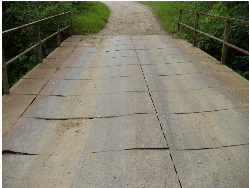
Figura 4. Vista del puente mostrando la mala condición de las barandas y de la superficie de rodamiento y la falta de aceras y drenajes.
