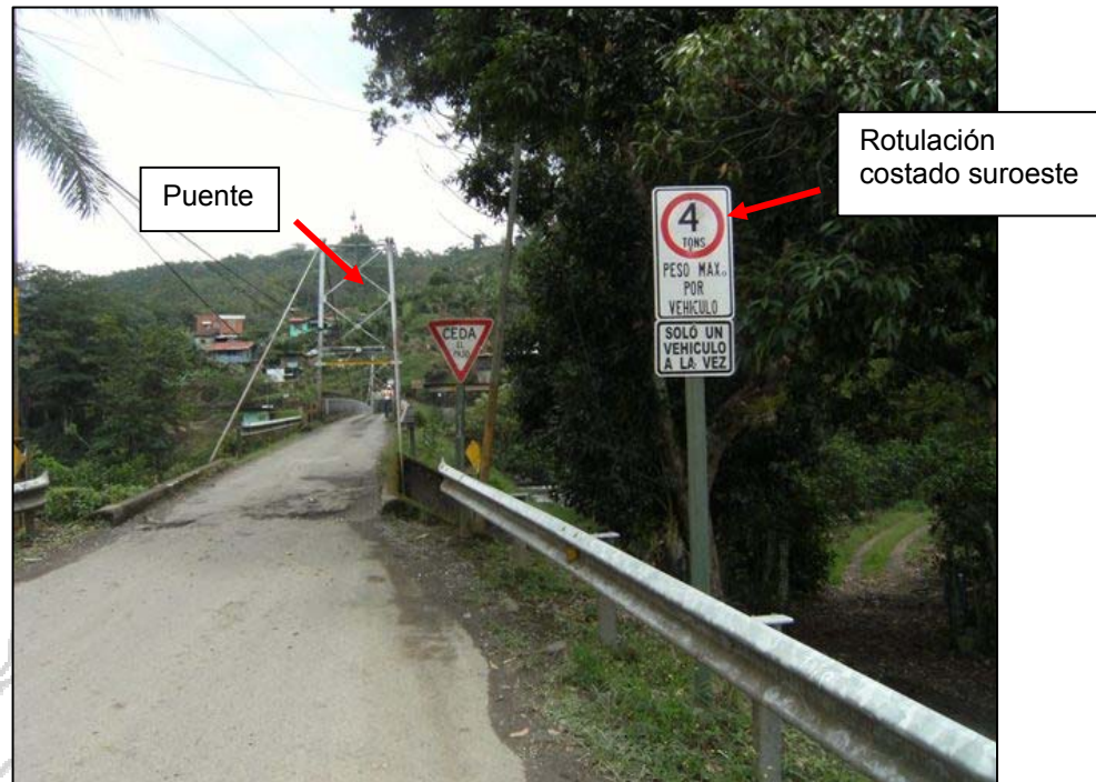
Fotografía No. 12. Rotulación de restricción vehicular aplicada por el MOPT, costado sur oeste (Fecha de fotografía 28-abr-2010) (Fuente: Unidad de Auditoría Técnica, LanammeUCR)
