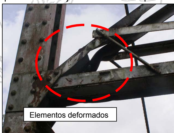
Fotografía No. 5. Elementos deformados en la torre suroeste (Fecha de fotografía 28-abr-2010) (Fuente: Unidad de Puentes, LanammeUCR)
