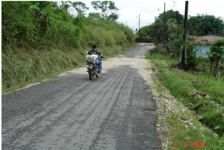
Figura 21: Proyecto antiguo, con un tratamiento superficial.
