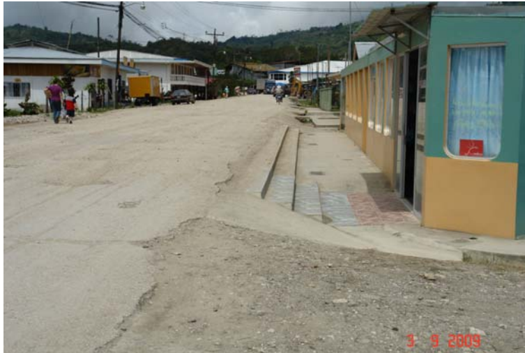
Figura 14: Elevado nivel de la rasante respecto a las construcciones vecinas.
