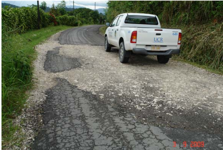
Figura 20: Proyecto antiguo, con un tratamiento superficial.
