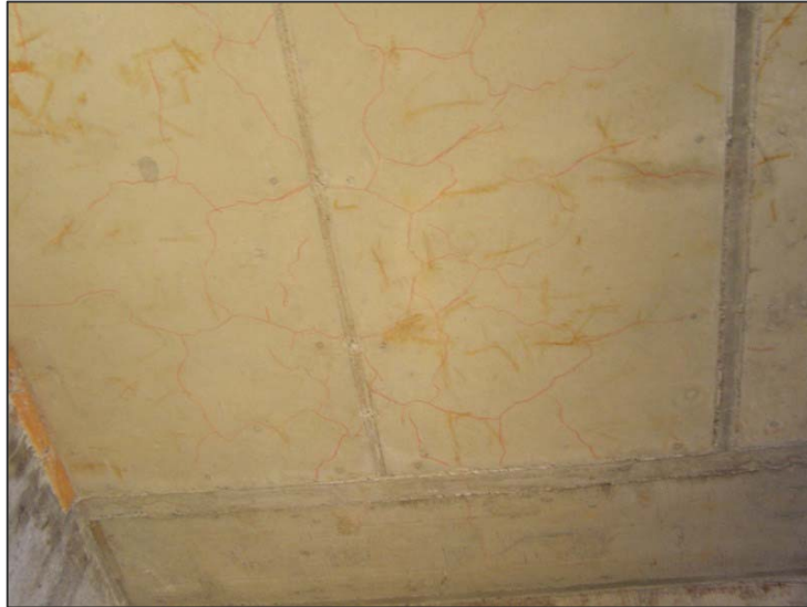
Figura 4.8: Agrietamiento en superficie inferior de la losa
