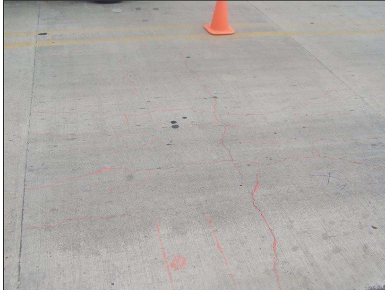
Figura 4.6: Agrietamiento de la losa (sección 3 D)
