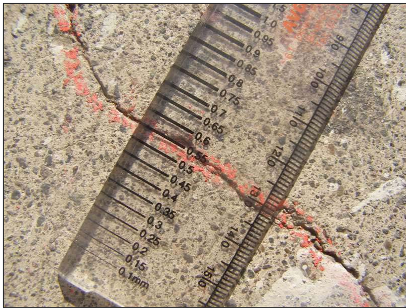
Figura 4.23: Fisura de 0.55 mm
