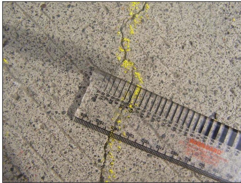
Figura 4.12: Fisura de 0.35 mm
