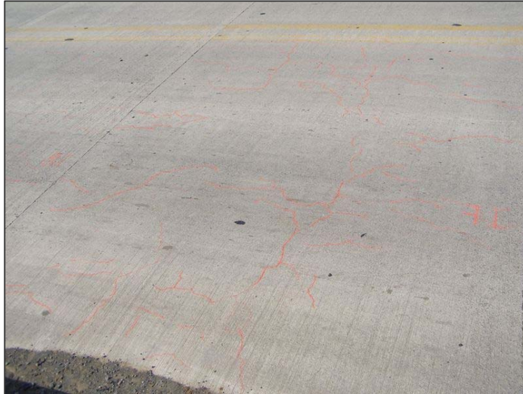
Figura 4.4: Agrietamiento de la losa (sección 7 I)
