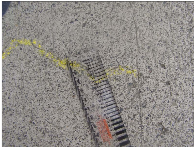
Figura 4.18: Fisura de 0.40 mm
