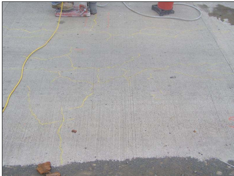
Figura 4.7: Agrietamiento de la losa (sección 5 D)
