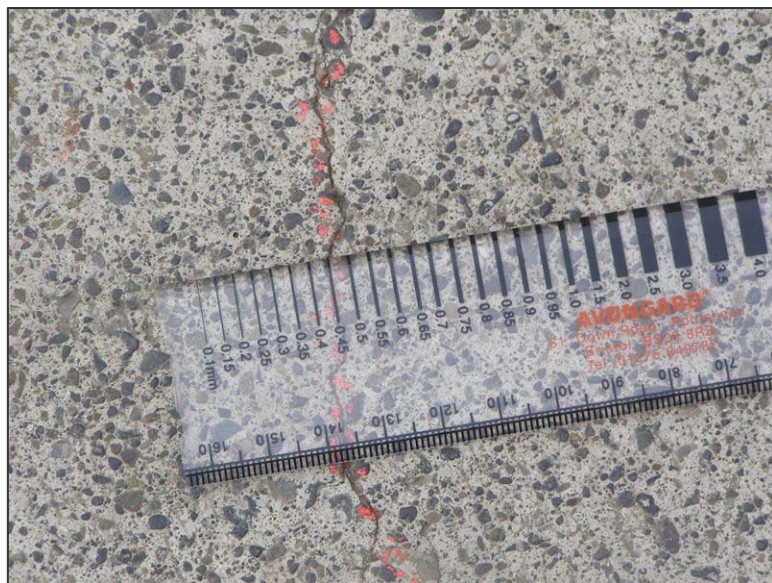
Figura 4.15: Fisura de 0.45 mm
