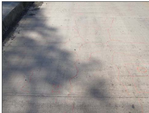
Figura 4.1: Agrietamiento de la losa (sección 3 I)
