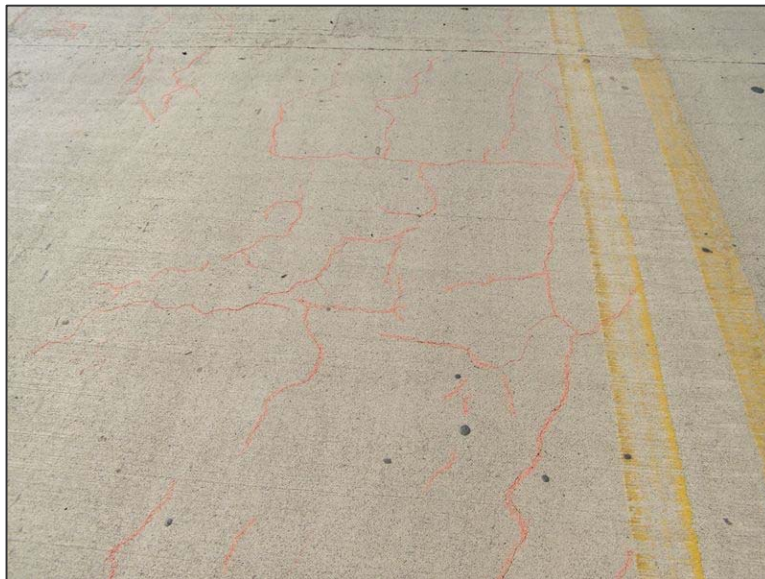
Figura 4.3: Agrietamiento de la losa
