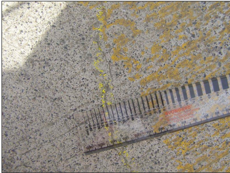
Figura 4.22: Fisura de 0.40 mm
