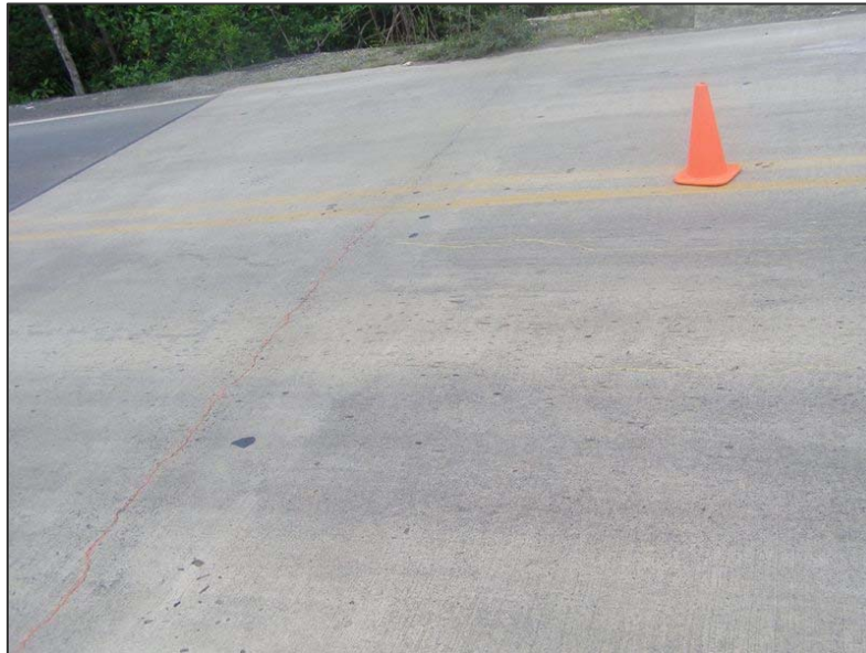
Figura 4.24: Agrietamiento transversal en la losa de aproximación (hacia Parrita)
