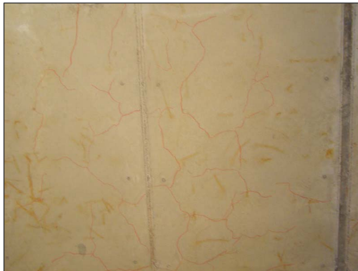
Figura 4.9: Agrietamiento en superficie inferior de la losa
