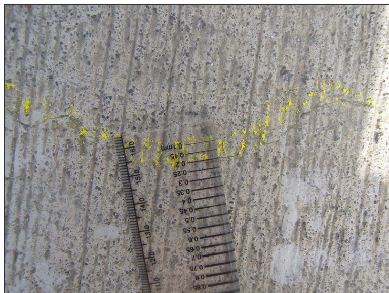
Figura 4.17: Fisura de 0.2 mm
