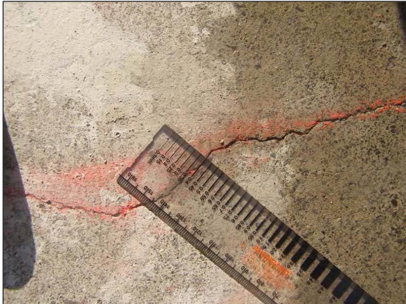
Figura 4.21: Fisura de 0.40 mm
