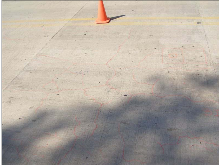
Figura 4.2: Agrietamiento de la losa (sección 3 I)
