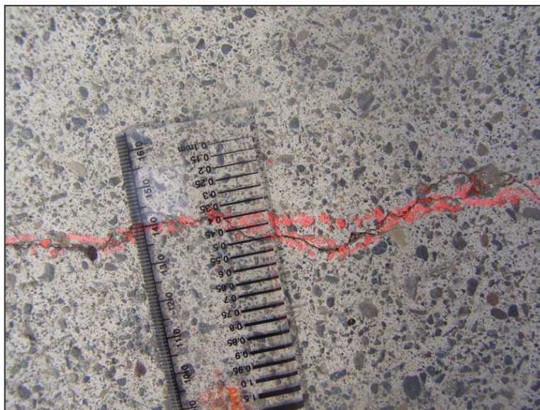
Figura 4.19: Fisura de 0.50 mm
