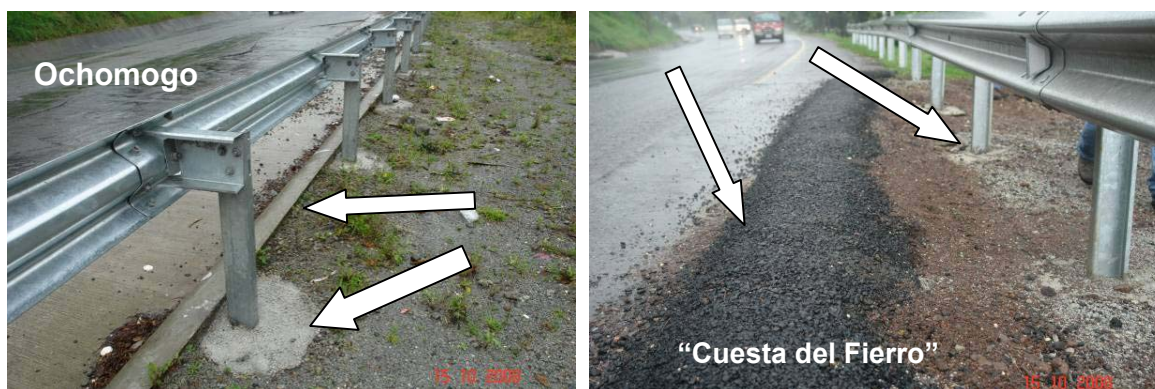
Fotografía No. 6 y 7: Sistemas de contención lateral instalados incorrectamente. Ruta Nacional No. 2. Fecha 10 de octubre del 2008.
