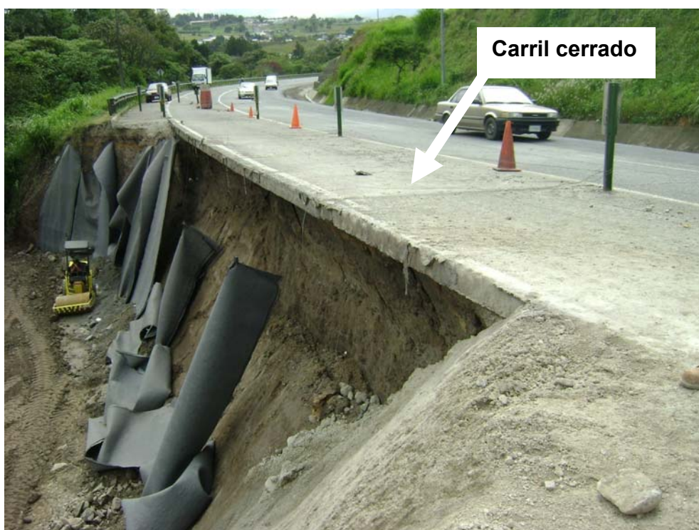
Fotografía No 2. Proceso constructivo del muro de gaviones, Ochomogo Ruta Nacional No. 2. Fecha: 29 de noviembre de 2007 donde se observa la ausencia de apoyo de las losas de concreto
