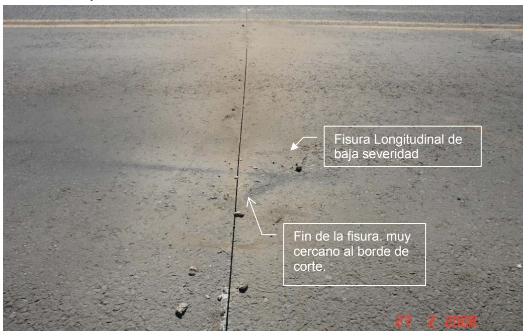
Fotografía 30. No se respeta la franja mínima de Pavimento sano alrededor de la zona afectada. Las fisuras llegan a menos de 30 cms del borde del área que se va a cortar.
