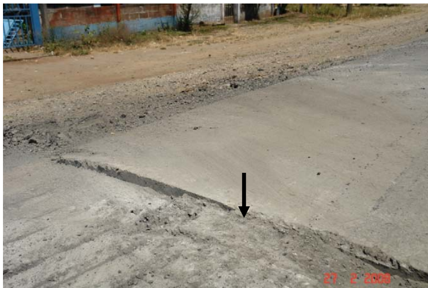
Fotografía 31 En la frontera de la zona tratada no hay retiro completo de la capa afectada.
