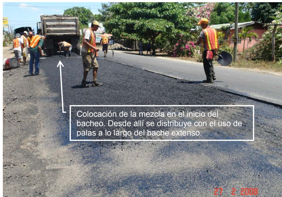
Fotografía 40. Colocación y extensión manual de la Mezcla asfáltica en zona extensa de bacheo. Gran parte de la mezcla necesaria se descargó en un extremo y debe ser paleada para distribuirla al área restante.
