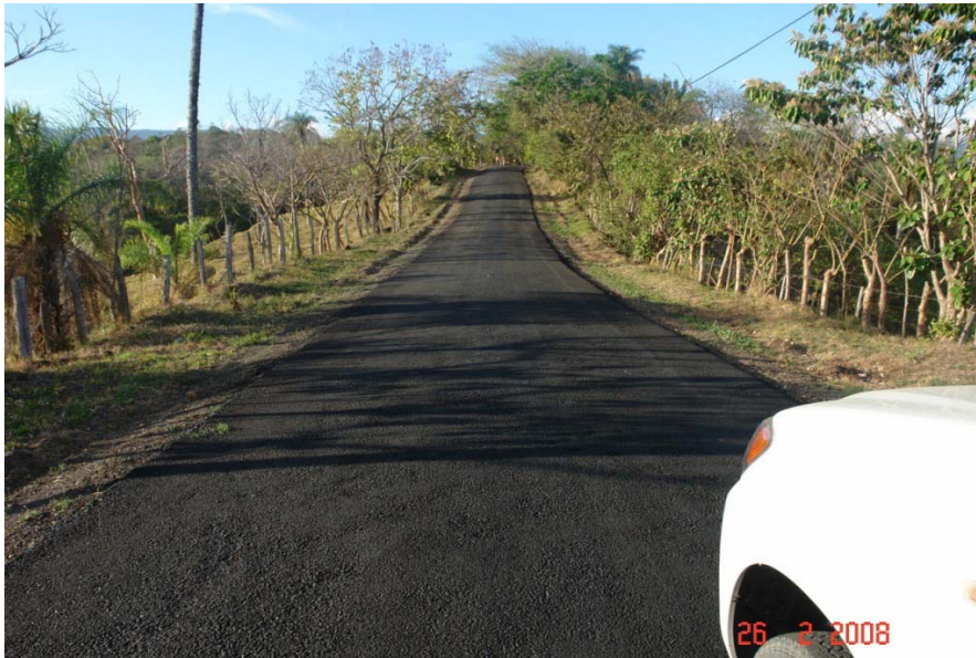
Fotografía 16. Zonas con bacheos extensos recientes, que cubren el ancho total de la calzada y sobre la cual se colocará el Tratamiento Superficial.
