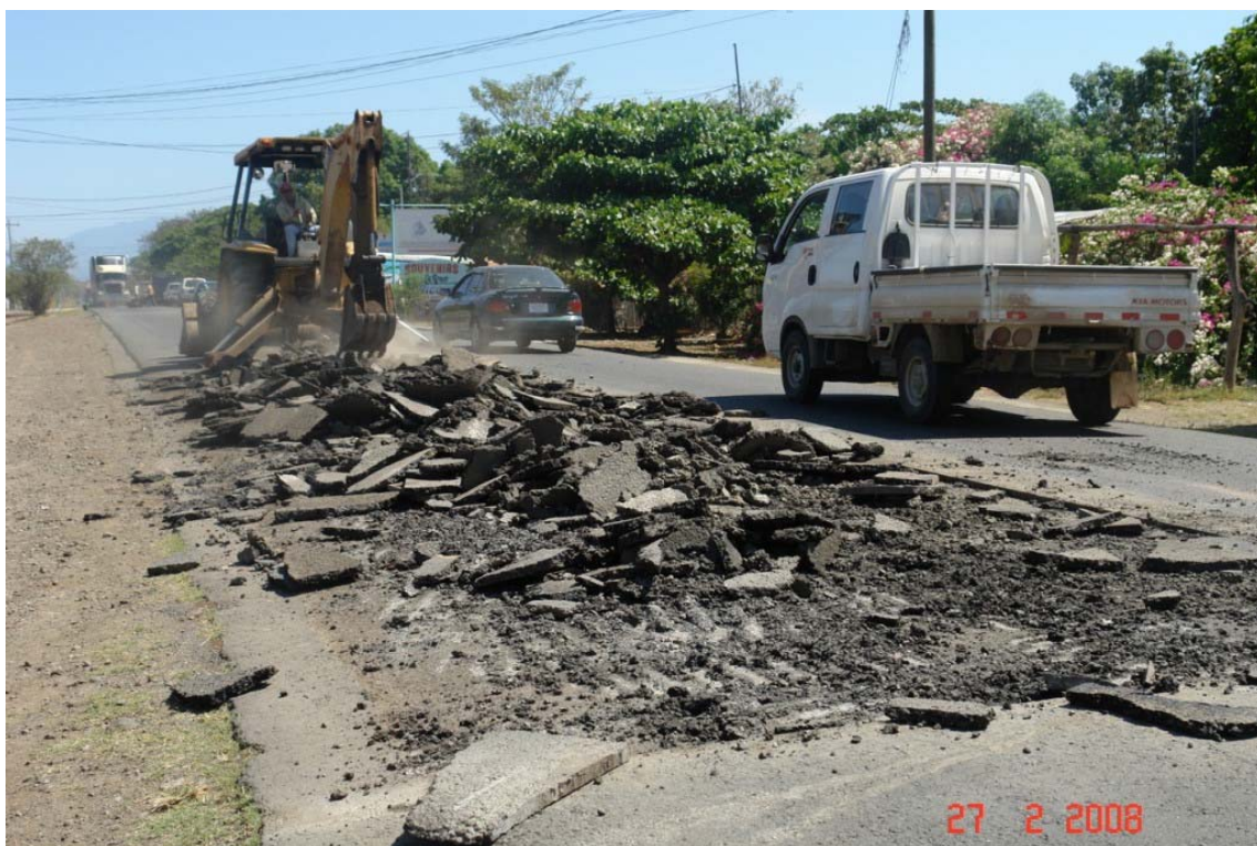
Fotografía 26. Levantamiento de la carpeta asfáltica superior del pavimento en fracciones grandes, que se separan fácilmente de la capa asfáltica subyacente. Obsérvese la longitud de la zona intervenida.
