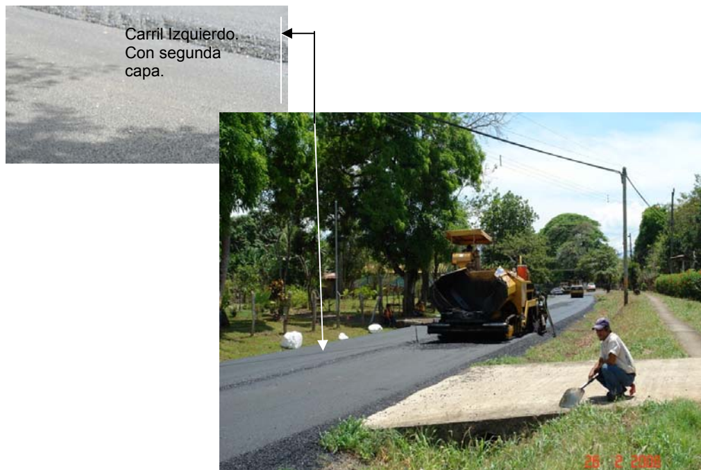
Fotografía 1. Extensión de segunda capa de concreto asfáltico sin realizar el corte de la junta longitudinal.
