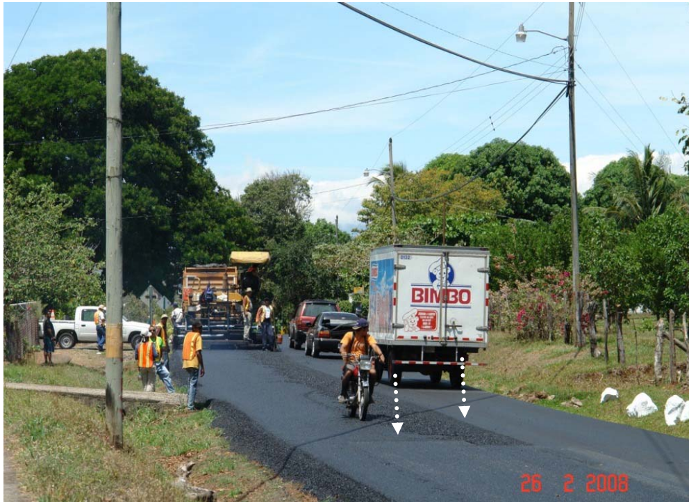
Fotografía 2. Obsérvese manejo del material del traslape y zona afectada por el venteo del material grueso.
