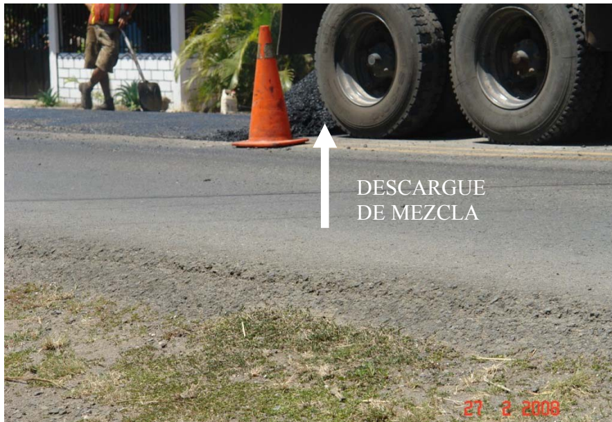
Fotografía 39. Vaciado de la mezcla en uno de los bordes donde se realizará el bacheo.
