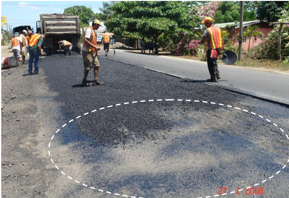
Fotografía No. 33. Realización del bacheo. Obsérvese falta de homogeneidad en la distribución del ligante en el bache de dimensiones 25 x 3 m.
