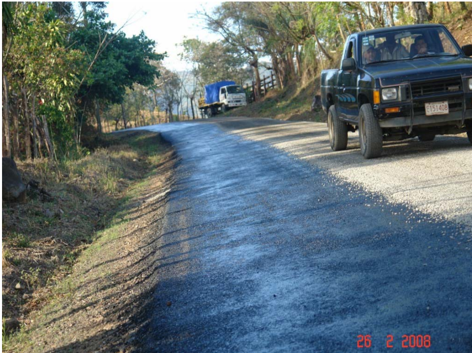
Fotografía 11. Riego de imprimación. Construcción de la primera capa del tratamiento superficial TS-2.
