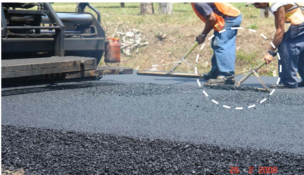
Fotografía 3. Por no ejecutarse el corte vertical de la junta longitudinal, se propicia la colocación de exceso de mezcla sobre ella, la cual debe ser extendida por operarios encima de la capa de rodadura recientemente colocada por la pavimentadora.
