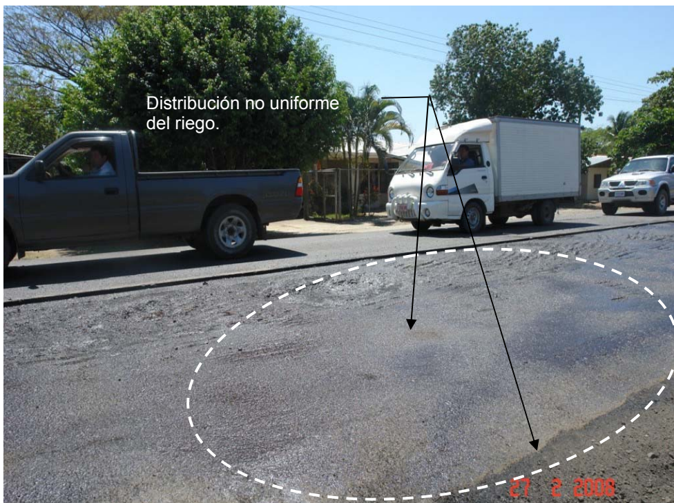
Fotografía No. 34. Realización del bacheo. Obsérvese falta de homogeneidad en la distribución del ligante en el bache de dimensiones 25 x 3 m.
