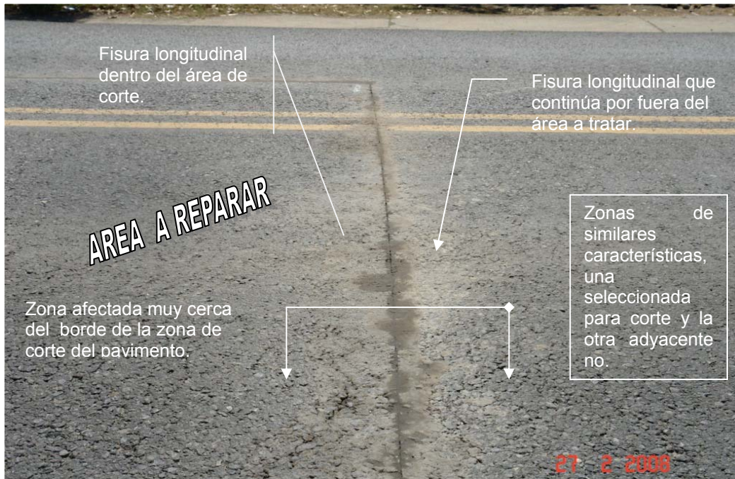
Fotografía 29. Tratamiento diferente a zonas de similares características de tipo y severidad del daño de la carpeta.
