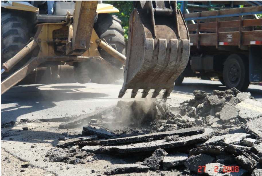
Fotografía 44. Deficiente riego de liga entre la capa retirada y la subyacente.
