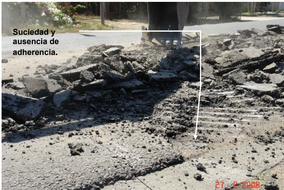
Fotografía 45. Ausencia o deficiente riego de liga entre la capa retirada y la subyacente. Obsérvese carpeta asfáltica subyacente en buen estado.
