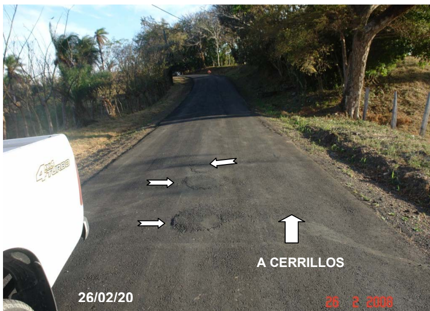
Fotografía 17. Zona con capa de nivelación y zonas bachadas existentes. Sobre este bacheo se extenderá el tratamiento superficial
