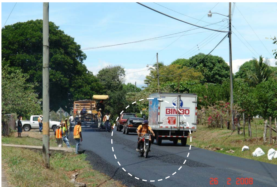
Fotografía 9. La falta de delimitación de la zona de trabajo, permite el ingreso de vehículos a la carpeta recién extendida y sin compactar.
