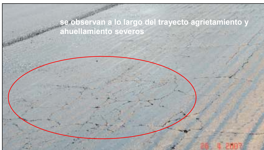
Fotografía N° 1. Agrietamiento y ahuellamiento severos en la carpeta existente sobre la cual se colocó una sobrecapa de mezcla asfáltica en caliente
