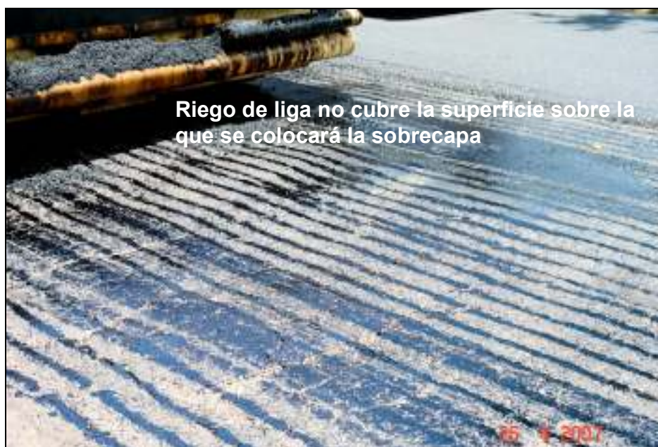
Fotografía N° 2. Deficiencias en la colocación del riego de liga previa colocación de sobrecapa.
