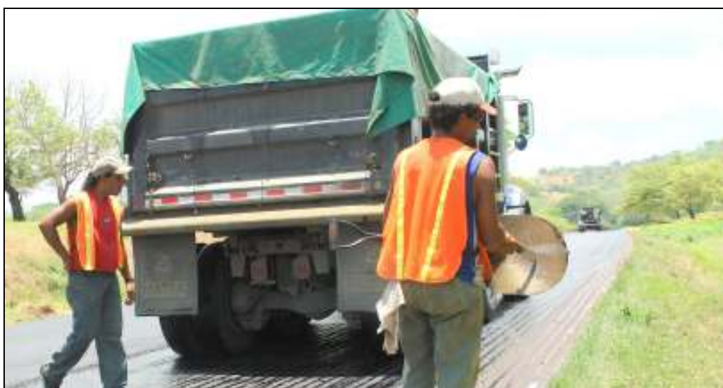
Fotografía N° 3. Ausencia de marchamos en los equipos de transporte de mezcla asfáltica
