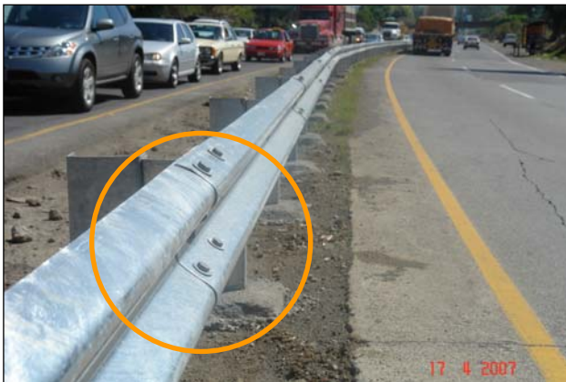
Fotografía 3: Detalle del empalme de las vigas de la barrera de seguridad en contra de la dirección del flujo vehicular.
