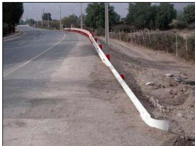
Figura 2: Extremo terminal de un guardavías que ha sido objeto de esviaje y de abatimiento.
