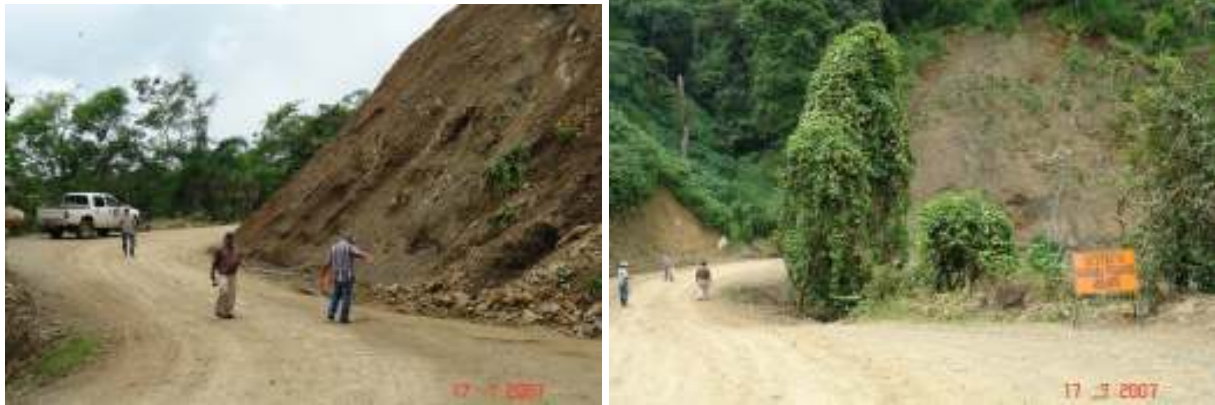
Fotografía No.7 y No.8: Trabajadores haciendo labores de topografía sin chalecos y con señalización escasa en la vía.
