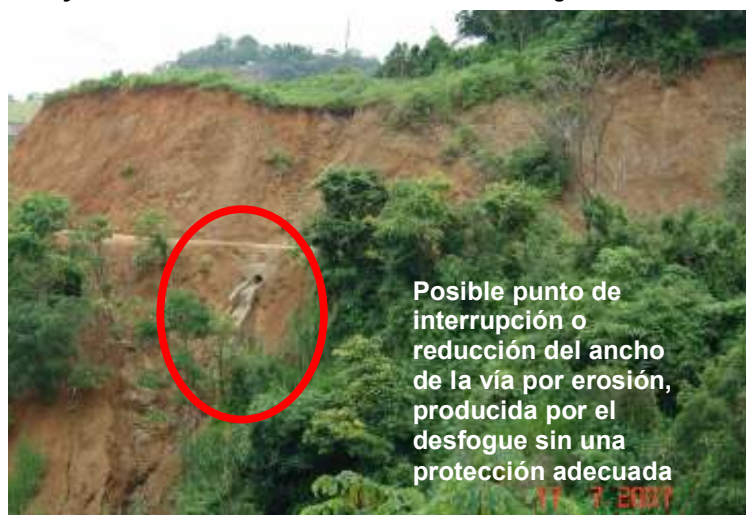
Fotografía No.13: Detalles observados en los desfogues de las alcantarillas construidas.
