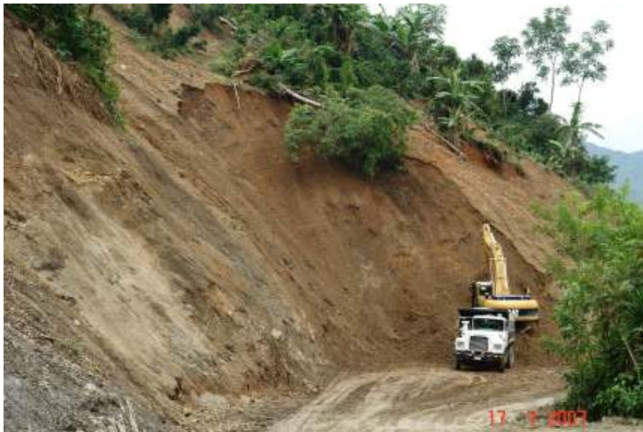
Fotografía No.5: Magnitud de uno de los derrumbes encontrados en el proyecto. Se ha indicado por parte del ingeniero inspector de la obra que se busca la estabilización natural del suelo.
