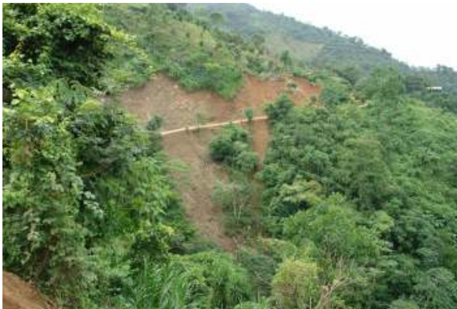
Fotografía No.1: Vista de un tramo de la carretera. Se puede ver la magnitud del problema si se produjera un deslizamiento.
