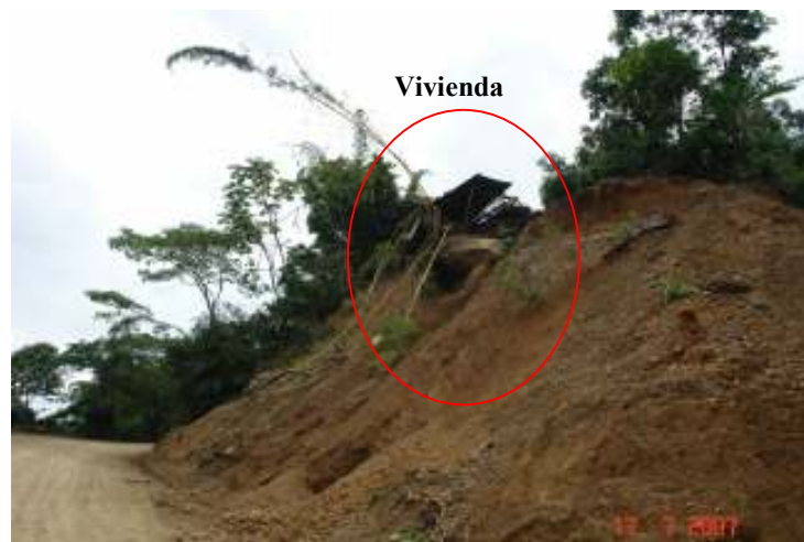
Fotografía No.2: Aquí existía una casa habitada. Se puede notar que aun está el techo que está a punto de caer a la carretera.
