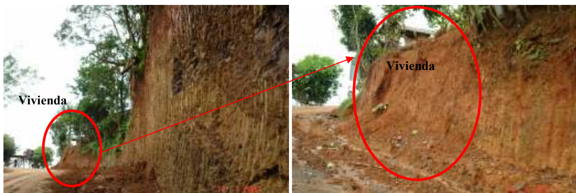
Fotografías No.3 y No.4: Cortes verticales al hacer la ampliación de la carretera. En el talud del fondo existe una casa habitada con peligro constante que sea afectada por un deslizamiento.
