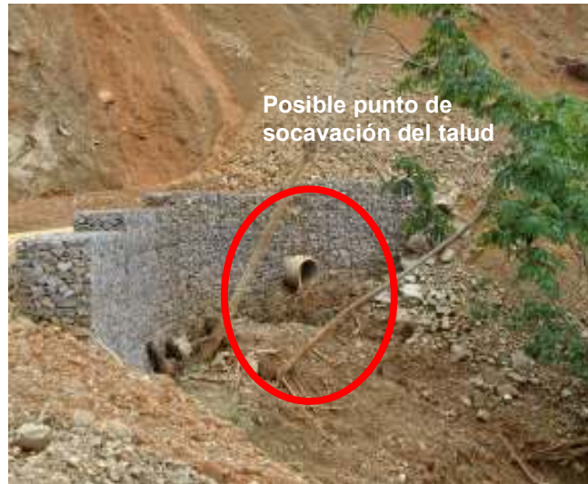
Fotografía No.14: Detalles observados en los desfogues de las alcantarillas construidas.
