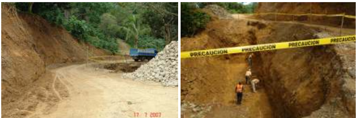
Fotografía No.9 y No.10: Señalización escasa e inadecuada en la vía.
