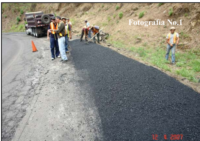
Vista general del frente de obra de bacheo donde se detectaron las deficiencias en el control de pesos de mezcla asfáltica en caliente, ruta nacional No.3.
